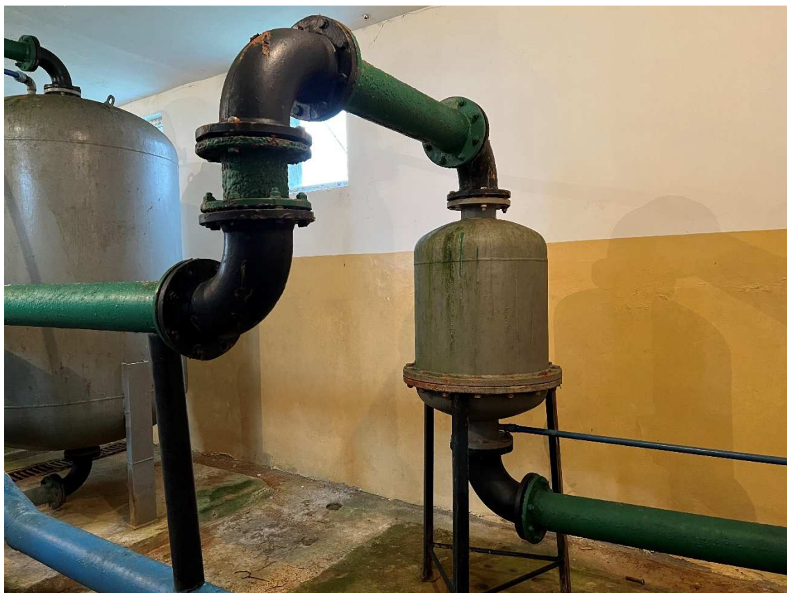
Fot. 7. Hala technologiczna SUW w Dobrzycy – aerator
