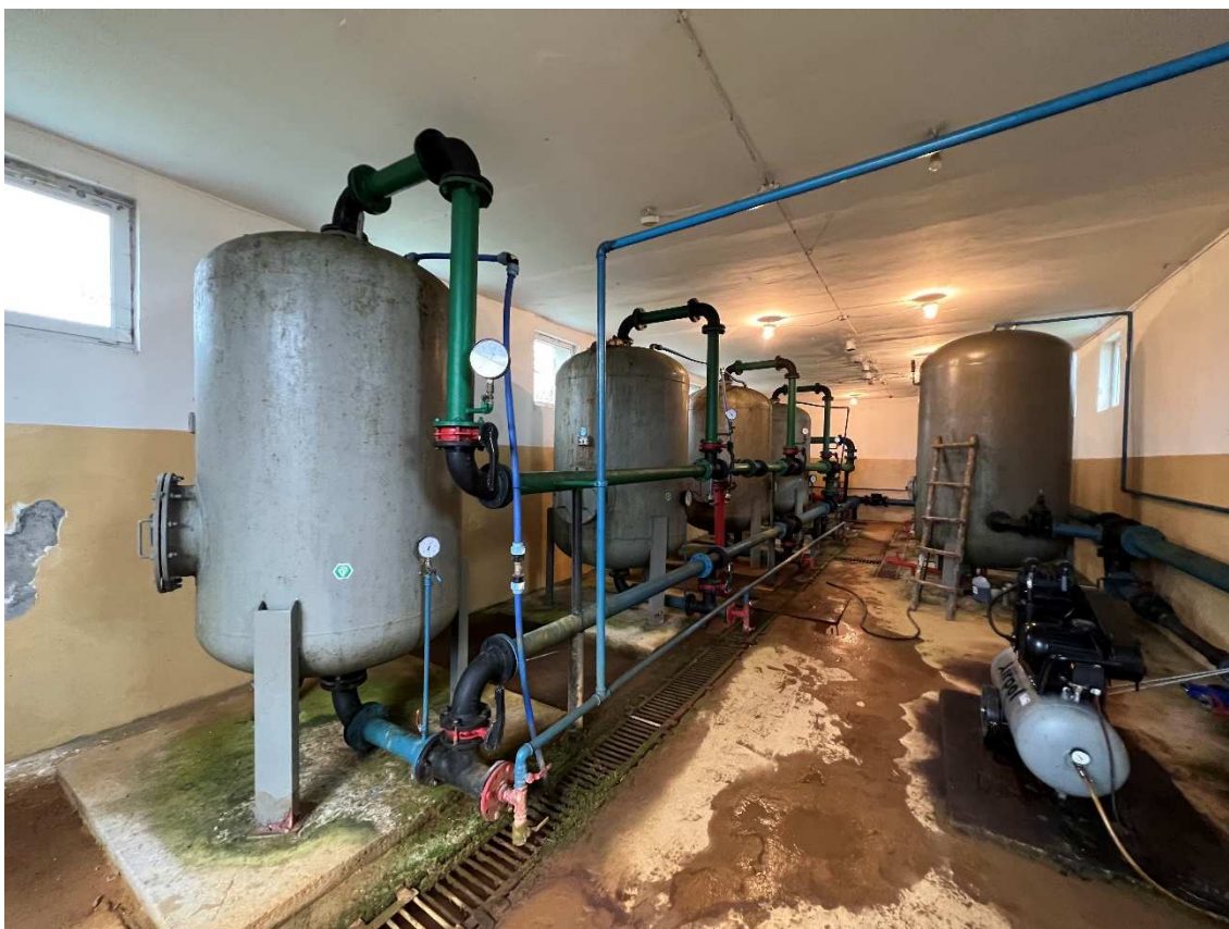
Fot. 5. Hala technologiczna SUW w Dobrzycy – widok ogólny
