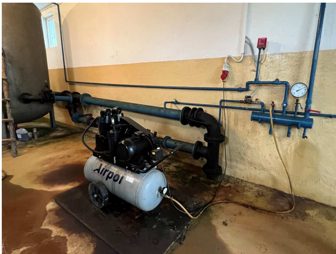
Fot. 8. Hala technologiczna SUW w Dobrzycy – instalacja sprężonego powietrza
