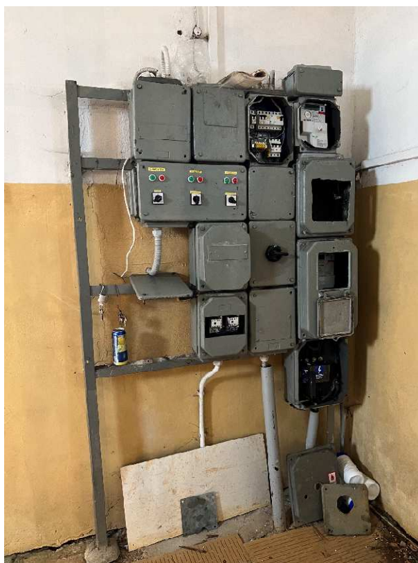
Fot. 10. Hala technologiczna SUW w Dobrzycy – rozdzielnicza elektryczna
