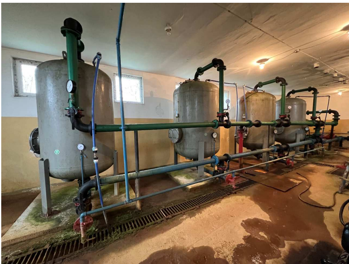
Fot. 6. Hala technologiczna SUW w Dobrzycy – blok filtrów
