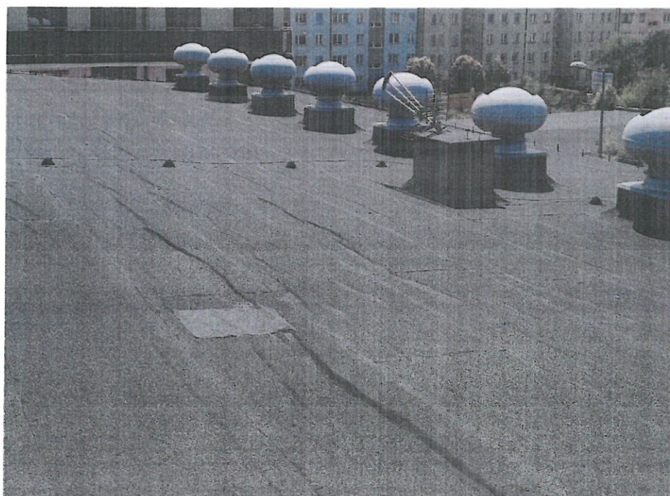
Pofałdowane pokrycie dachowe
