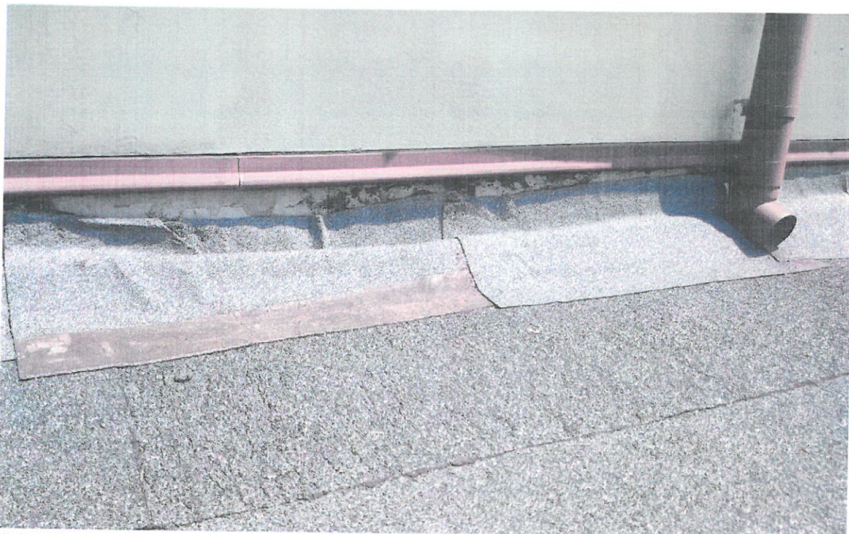
Odspojenia porycia na styku ze ścianą
