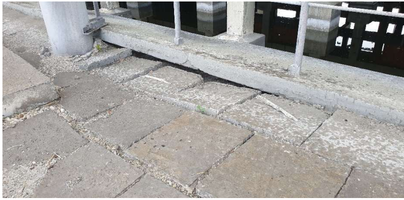
Fot.26 Uszkodzenia chodnik od strony zachodniej chłodni
