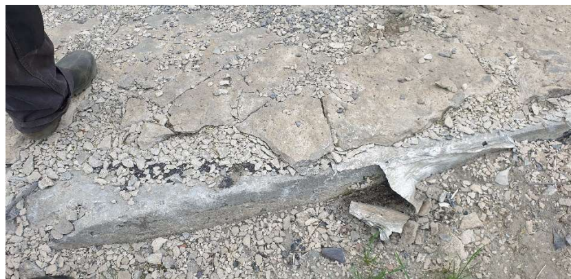
Fot.7 Uszkodzony nadbeton izolacja na stropie Komory nr 2
