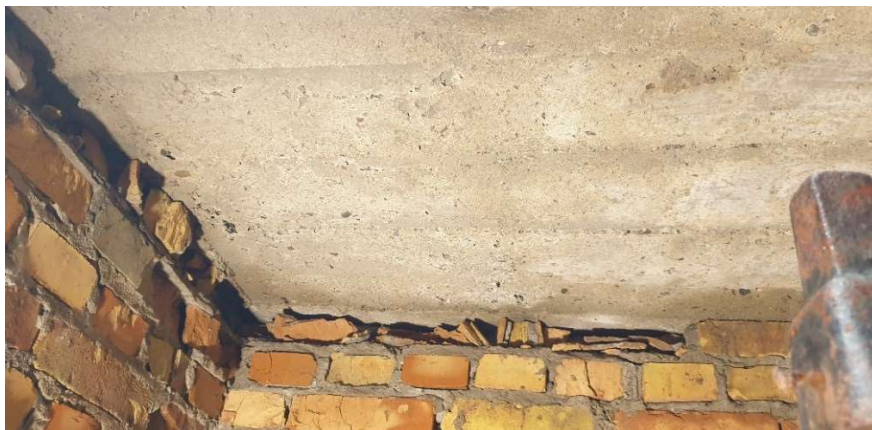
Fot.20 Uszkodzona warstwa cegieł w Komorze nr 4
