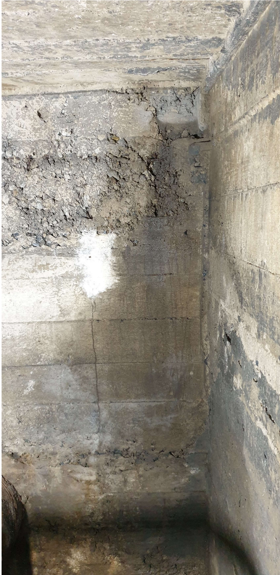
Fot.13 Zawilgocone naroże w Komorze nr 2
