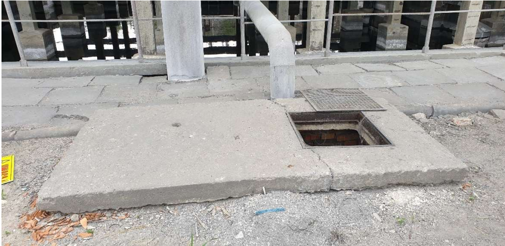
Fot.14 Widok Komory nr 3 – pęknięcie płyty
