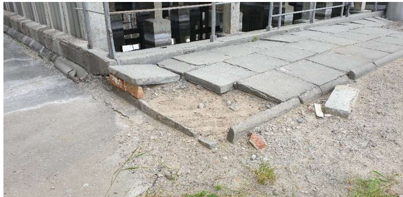
Fot.27 Uszkodzenia chodnik od strony zachodniej chłodni
