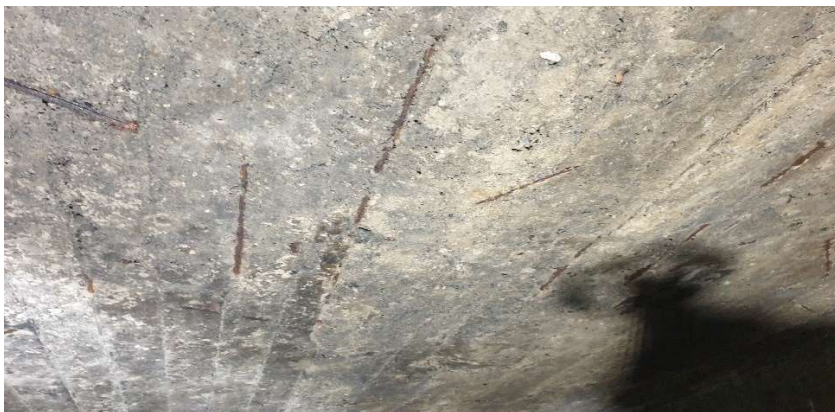
Fot.11 Odkryte pręty zbrojeniowe w Komorze nr 2
