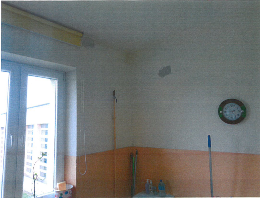
Fot. 13 Spękanie muru w narożniku, kontrolne plombę s.15
