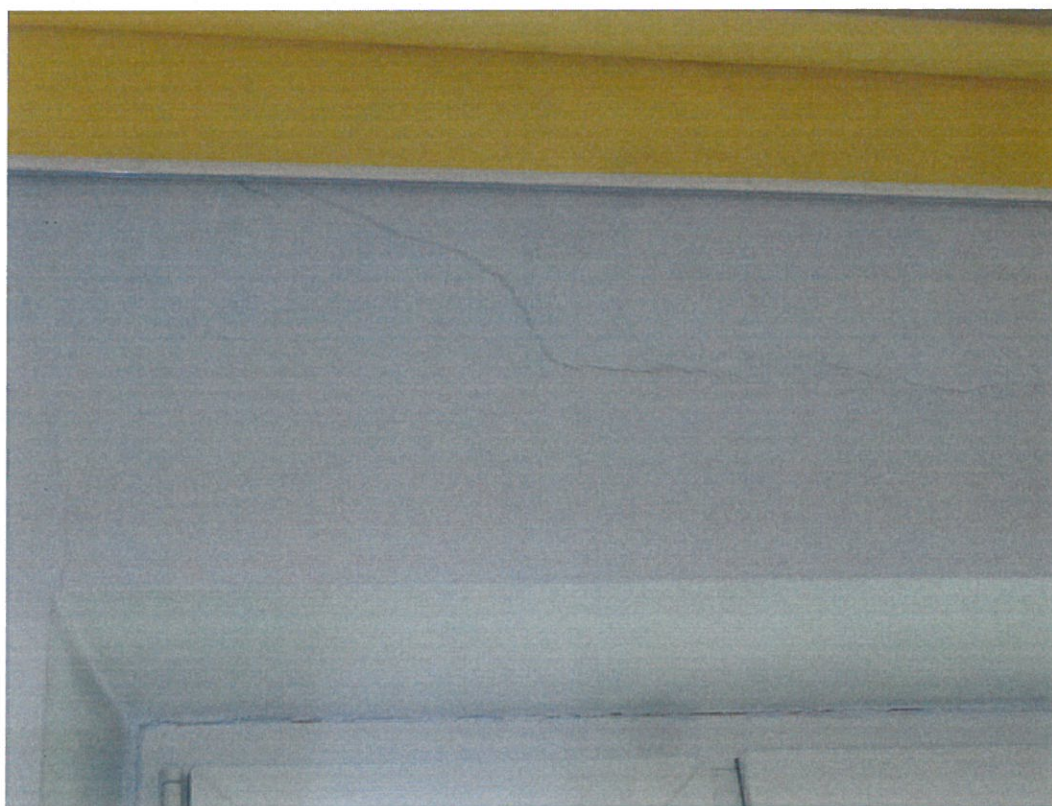
Fot. 8 - Pęknięcie sufitu przy nadprożu i ościeżu okna, s.12
