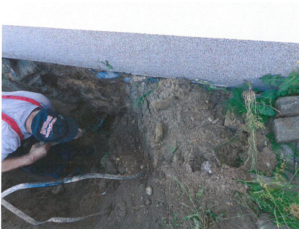
Fot. 4 Odkrywka – mur fundamentu z kamienia wapiennego, widoczne ubytki w murze.
