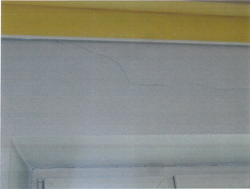
Fot. 9 - Pęknięcie sufitu przy nadprożu, s. 12
