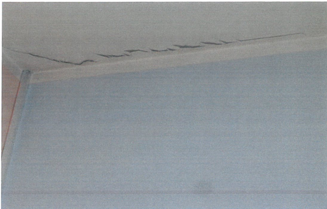
Fot. 7 - Pęknięcie sufitu przy nadprożu, s.12
