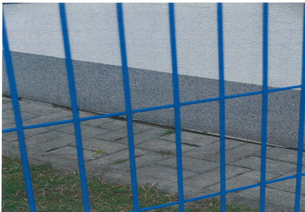
Fot. 2 J.w. widoczne osiadanie gruntu.
