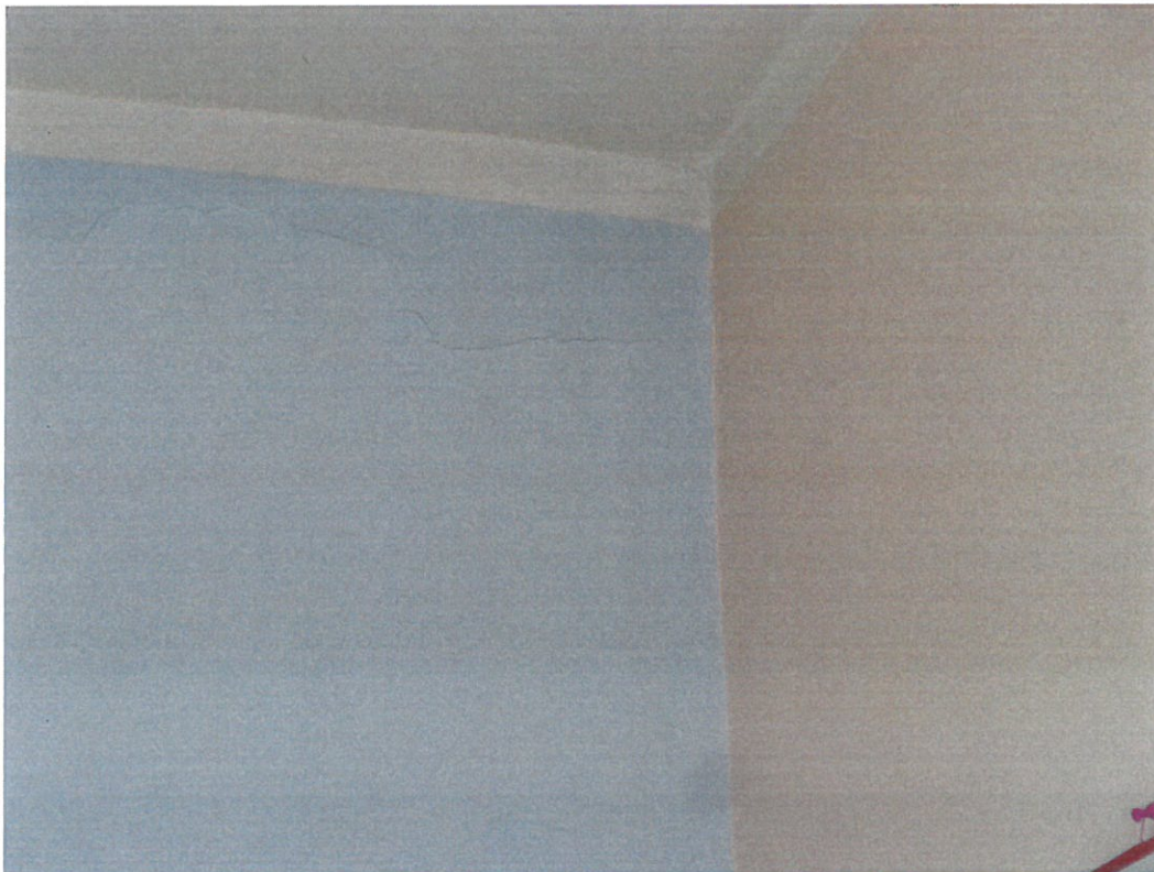
Fot. 10 - Pęknięcie ściany w narożniku w wyniku osiadania, s. 14
