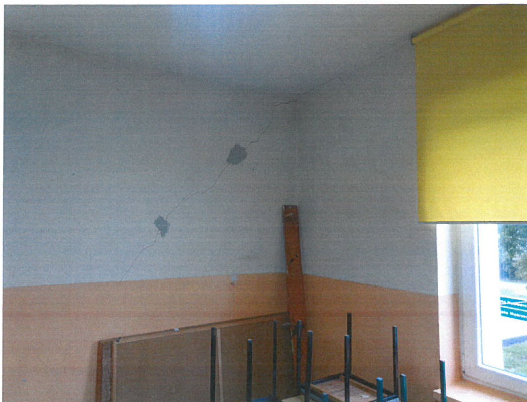
Fot. 11 - Pęknięcie muru ściany, osiadanie narożnika, przyklejone kontrolne plomb, s. 15
