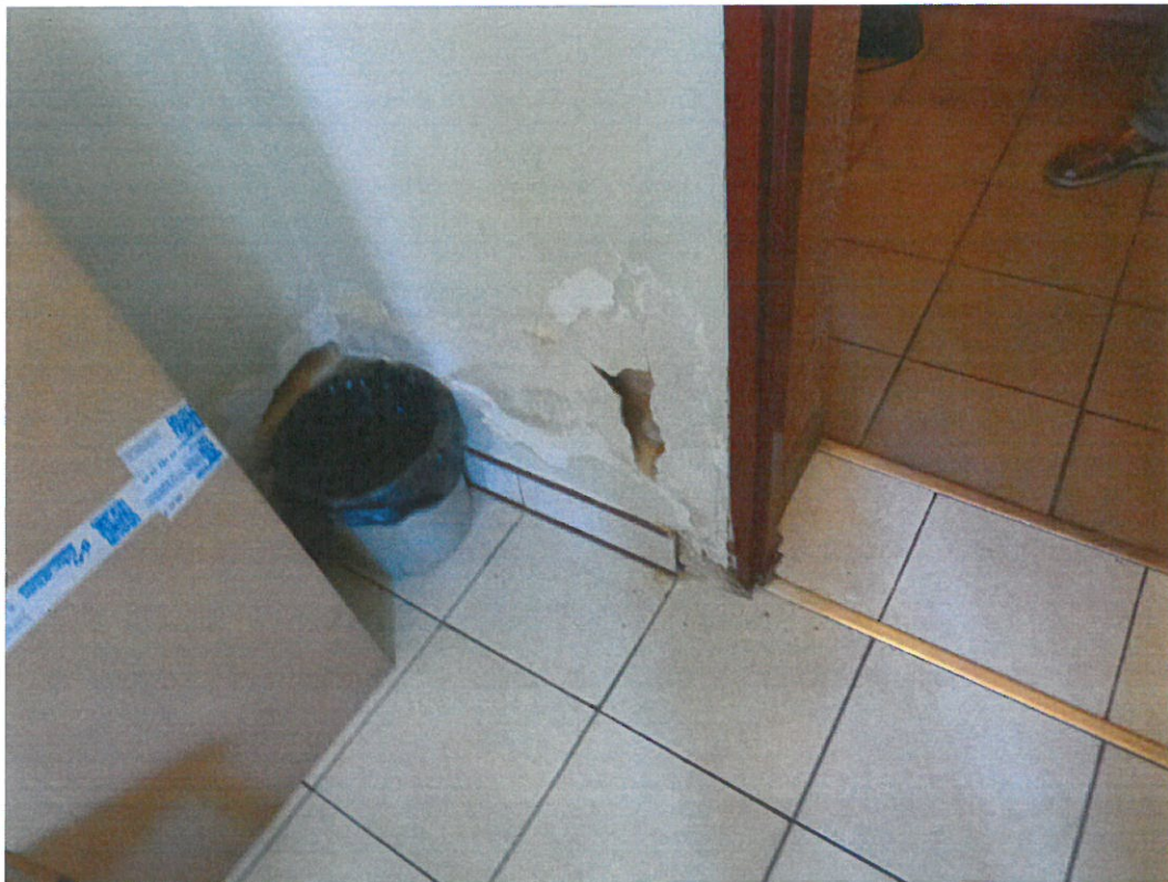
16. Zniszczony tynk ściany przez wilgoć - skutek braku izolacji poziomej i pionowej. Parter budynku.
