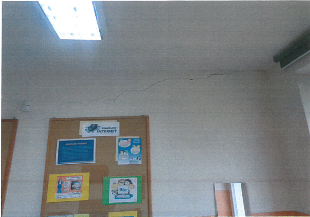
Fot. 15 - Osiadanie ściany w narożniku, s. 16
