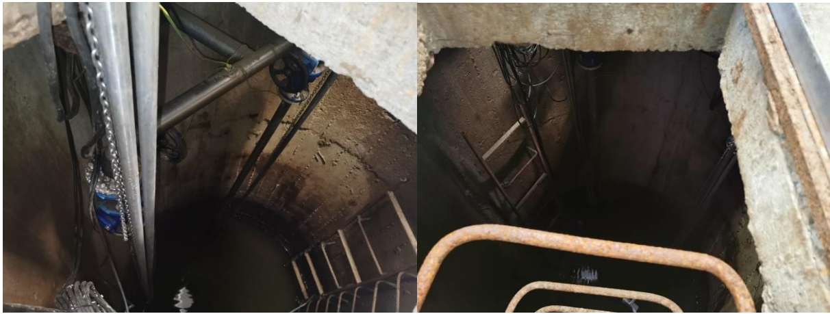
Rysunek 1. Komora przepompowni - stan obecny
