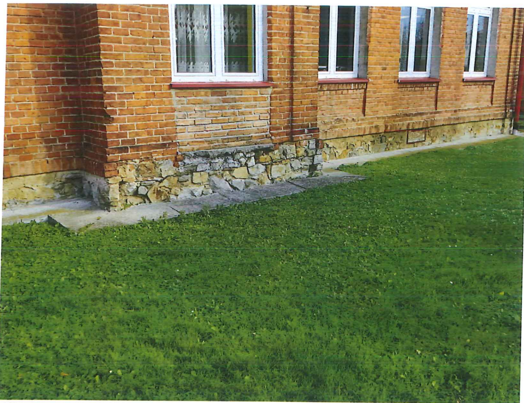
Zdjęcie nr 4. Korozja wątku ceglanego na elewacji pół-zach.
