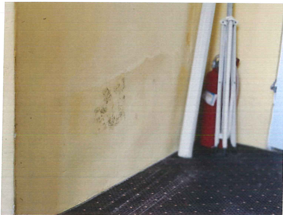
Zdjęcie nr 7. Pokój nauczycielski. Pleśń, odparzenia powłoki malarskiej i tynku z powodu braku poziomej izolacji przeciwwilgociowej ścian fundamentowych.
