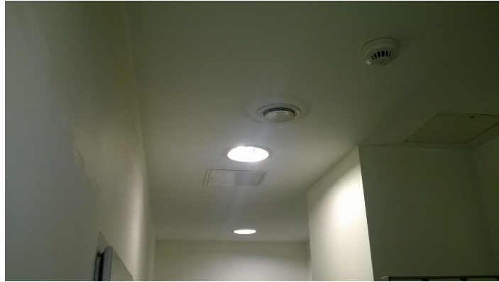
Zdjęcie nr 2 – Przykład planowanej oprawy
