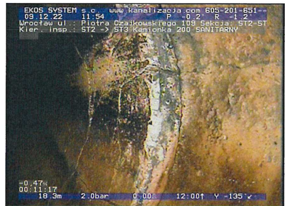
ST2-ST3-foto_nr-106.jpg, 00:11:03, 18.38 m Złamanie obwodowe - wyraźne otwarcie ścian przewodu, fragmenty obecne na swoim miejscu, szer.: 1mm od 1 godz. do 11 godz.
