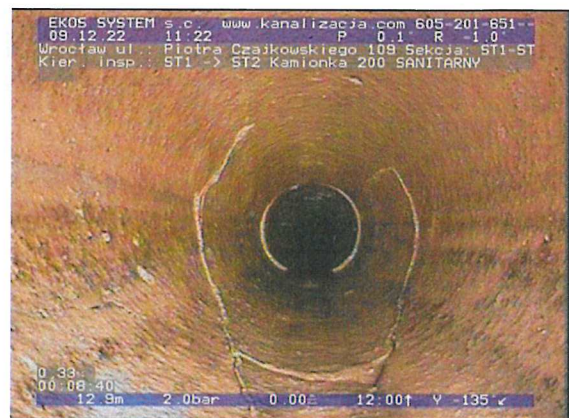
ST1-ST2-foto_nr-090.jpg, 00:08:28, 12.91 m Złamanie złożone - wyraźne otwarcie ścian przewodu, fragmenty obecne na swoim miejscu, szer.: 1mm od 12 godz. do 12 godz., Początek obserwacji
