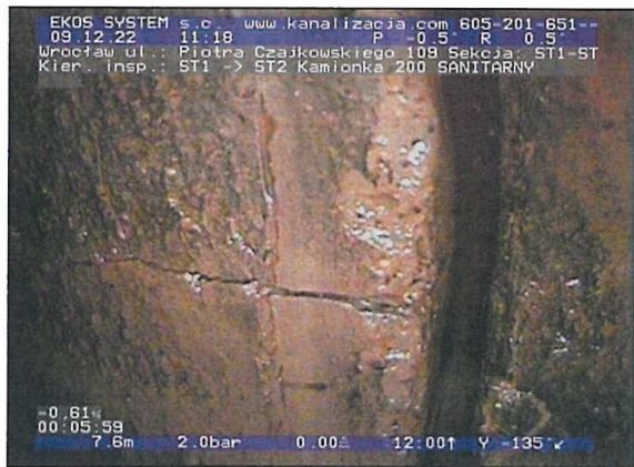
ST1-ST2-foto_nr-085.jpg, 00:05:59, 7.65 m Pęknięcie obwodowo, widoczne linie pęknięcia, fragmenty nadal obecne na swoim miejscu, szer.: 1mm od 5 godz. do 7 godz.
