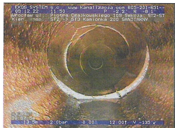
ST2-ST3-foto_nr-102.jpg, 00:07:54, 13.57 m Złamanie złożone - wyraźne otwarcie ścian przewodu, fragmenty obecne na swoim miejscu, szer.: 1mm od 12 godz. do 12 godz.
