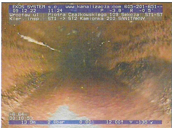
ST1-ST2-foto_nr-092.jpg, 00:10:53, 13.90 m Miejscowe załamanie spadków rury (przeciwspadek). Zastój ścieków do, 30% prześwitu rury, Początek obserwacji
