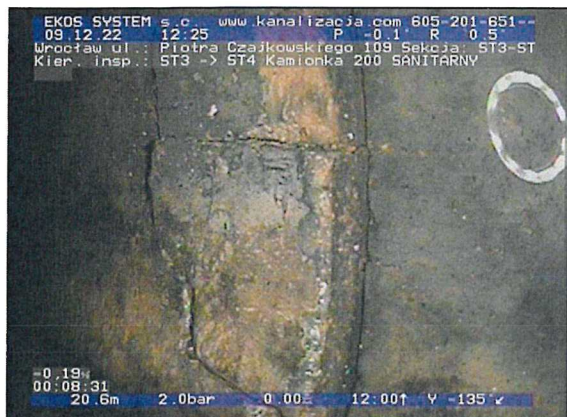
ST3-ST4-foto_nr-124.jpg, 00:08:26, 20.69 m Pęknięcie obwodowo, widoczne linie pęknięcia, fragmenty nadal obecne na swoim miejscu, szer.: 1mm od 4 godz. do 8 godz.
