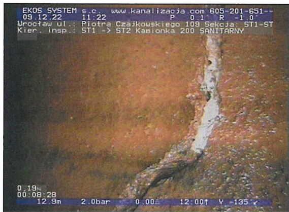
ST1-ST2-foto_nr-087.jpg, 00:08:28, 12.91 m Złamanie złożone - wyraźne otwarcie ścian przewodu, fragmenty obecne na swoim miejscu, szer.: 1mm od 12 godz. do 12 godz., Początek obserwacji
