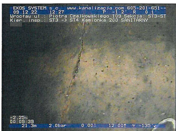
ST3-ST4-foto_nr-126.jpg, 00:09:33, 21.34 m Pęknięcie obwodowo, widoczne linie pęknięcia, fragmenty nadal obecne na swoim miejscu, szer.: 1mm od 12 godz. do 12 godz.
