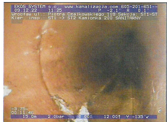
ST1-ST2-foto_nr-093.jpg, 00:11:45, 15.07 m Przemieszczone złącze, odchylenie rur pod kątem na 6 godz., próg
