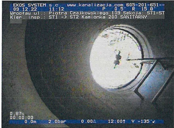
ST1-ST2-foto_nr-081.jpg, 00:00:00, 0.00 m Węzeł początkowy. Studzienka wiazowa, ST1
