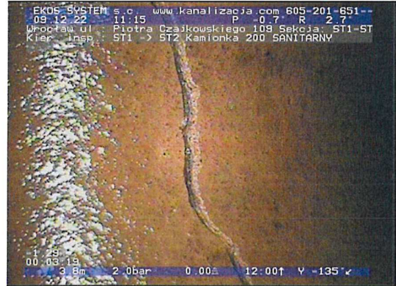
ST1-ST2-foto_nr-082.jpg, 00:03:19, 3.83 m Złamanie obwodowe - wyraźne otwarcie ścian przewodu, fragmenty obecne na swoim miejscu, szer.: 1mm od 12 godz. do 12 godz.
