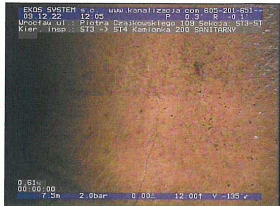
ST3-ST4-foto_nr-113.jpg, 00:13:55, 7.51 m Pęknięcie obwodowo, widoczne linie pęknięcia, fragmenty nadal obecne na swoim miejscu, szer.: 1mm od 2 godz. do 8 godz.
