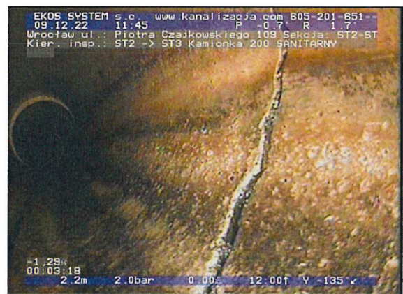
ST2-ST3-foto_nr-098.jpg, 00:03:18, 2.23 m Złamanie obwodowe - wyraźne otwarcie ścian przewodu, fragmenty obecne na swoim miejscu, szer.: 1mm od 12 godz. do 12 godz.
