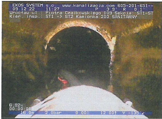
ST1-ST2-foto_nr-095.jpg, 00:11:45, 15.07 m Przemieszczone złącze, odchylenie rur pod kątem na 6 godz., próg
