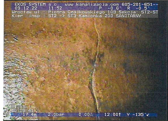
ST2-ST3-foto_nr-104.jpg, 00:09:41, 17.48 m Pęknięcie obwodowo, widoczne linie pęknięcia, fragmenty nadal obecne na swoim miejscu, szer.: 1mm od 12 godz. do 12 godz.
