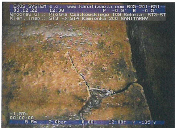
ST3-ST4-foto_nr-114.jpg, 00:13:55, 9.81 m Pęknięcie złożone, widoczne linie pęknięcia, fragmenty nadal obecne na swoim miejscu, szer.: 1mm od 12 godz. do 12 godz., Początek obserwacji
