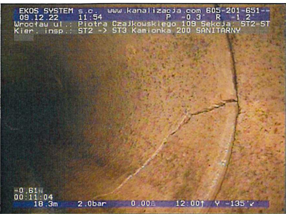
ST2-ST3-foto_nr-105.jpg, 00:11:03, 18.38 m Złamanie obwodowe - wyraźne otwarcie ścian przewodu, fragmenty obecne na swoim miejscu, szer.: 1mm od 1 godz. do 11 godz.
