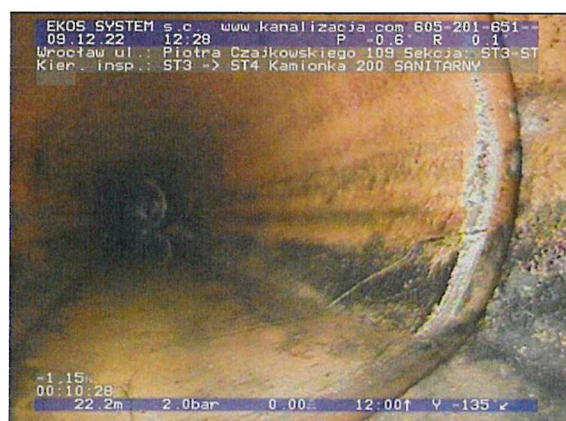
ST3-ST4-foto_nr-127.jpg, 00:10:28, 22.20 m Pęknięcie obwodowo, widoczne linie pęknięcia, fragmenty nadal obecne na swoim miejscu, szer.: 1mm od 4 godz. do 8 godz.
