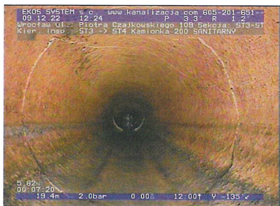
ST3-ST4-foto_nr-122.jpg, 00:07:20, 19.43 m Pęknięcie obwodowo, widoczne linie pęknięcia, fragmenty nadal obecne na swoim miejscu, szer.: 1mm od 12 godz. do 12 godz.
