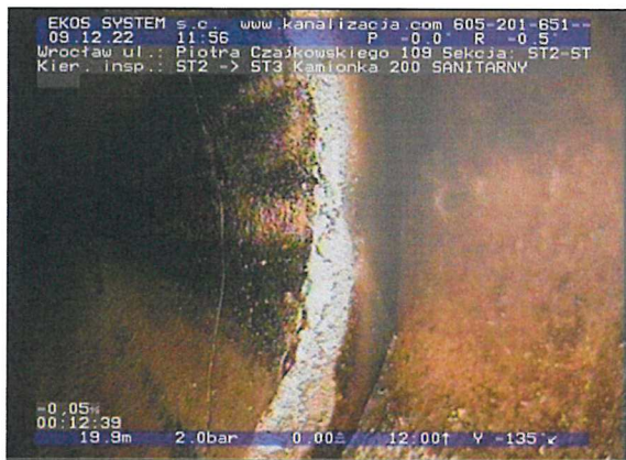
ST2-ST3-foto_nr-109.jpg, 00:12:38, 19.92 m Pęknięcie obwodowo, widoczne linie pęknięcia, fragmenty nadal obecne na swoim miejscu, szer.: 1mm od 5 godz. do 7 godz.
