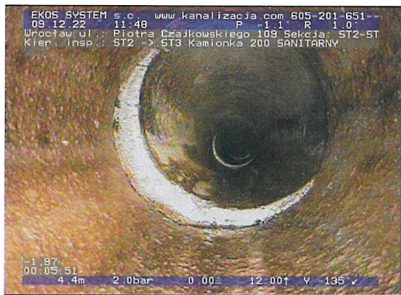
ST2-ST3-foto_nr-101.jpg, 00:05:50, 4.46 m Przemieszczenie złącza - boczne (promieniste) prostopadłe do linii kanału na 8 godz.
