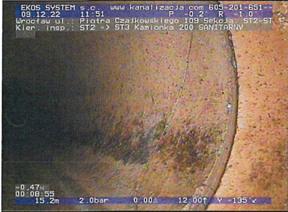
ST2-ST3-foto_nr-103.jpg, 00:08:55, 15.29 m Pęknięcie obwodowo, widoczne linie pęknięcia, fragmenty nadal obecne na swoim miejscu, szer.: 1mm od 1 godz. do 4 godz.
