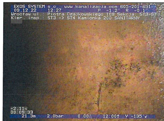
ST3-ST4-foto_nr-125.jpg, 00:09:33, 21.34 m Pęknięcie obwodowo, widoczne linie pęknięcia, fragmenty nadal obecne na swoim miejscu, szer.: 1mm od 12 godz. do 12 godz.
