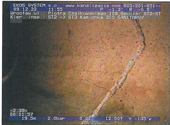
ST2-ST3-foto_nr-107.jpg, 00:11:58, 19.57 m Pęknięcie obwodowo, widoczne linie pęknięcia, fragmenty nadal obecne na swoim miejscu, szer.: 1mm od 12 godz. do 12 godz.
