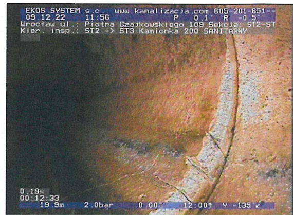
ST2-ST3-foto_nr-108.jpg, 00:12:33, 19.92 m Pęknięcie obwodowo, widoczne linie pęknięcia, fragmenty nadal obecne na swoim miejscu, szer.: 1mm od 5 godz. do 7 godz.
