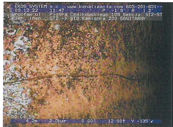
ST2-ST3-foto_nr-100.jpg, 00:04:59, 4.20 m Pęknięcie wzdłużnie, widoczne linie pęknięcia, fragmenty nadal obecne na swoim miejscu, szer.: 1mm na 6 godz.
