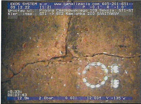
ST1-ST2-foto_nr-089.jpg, 00:07:43, 12.97 m Pęknięcie wzdłużnie, widoczne linie pęknięcia, fragmenty nadal obecne na swoim miejscu, szer.: 1mm na 6 godz., Koniec obserwacji
