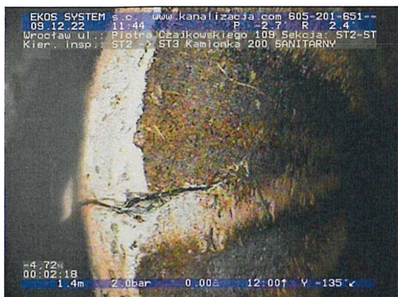
ST2-ST3-foto_nr-097.jpg, 00:02:18, 1.44 m Pęknięcie obwodowo, widoczne linie pęknięcia, fragmenty nadal obecne na swoim miejscu, szer.: 1mm od 6 godz. do 7 godz.
