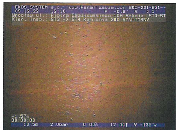
ST3-ST4-foto_nr-115.jpg, 00:13:55, 10.50 m Pęknięcie złożone, widoczne linie pęknięcia, fragmenty nadal obecne na swoim miejscu, szer.: 1mm od 12 godz. do 12 godz., Koniec obserwacji
