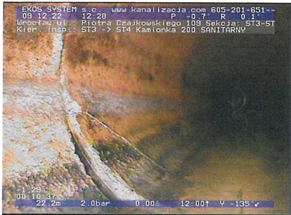
ST3-ST4-foto_nr-128.jpg, 00:10:28, 22.20 m Pęknięcie obwodowo, widoczne linie pęknięcia, fragmenty nadal obecne na swoim miejscu, szer.: 1mm od 4 godz. do 8 godz.
