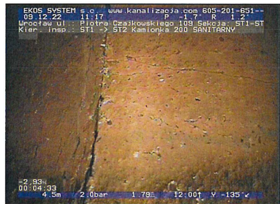
ST1-ST2-foto_nr-084.jpg, 00:04:32, 4.55 m Pęknięcie wzdłużnie, widoczne linie pęknięcia, fragmenty nadal obecne na swoim miejscu, szer.: 1mm na 3 godz., Koniec obserwacji
