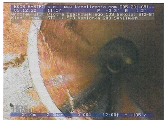
ST2-ST3-foto_nr-110.jpg, 00:13:11, 21.47 m Pęknięcie obwodowo, widoczne linie pęknięcia, fragmenty nadal obecne na swoim miejscu, szer.: 1mm od 6 godz. do 8 godz.
