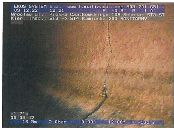
ST3-ST4-foto_nr-120.jpg, 00:05:42, 16.59 m Pęknięcie obwodowo, widoczne linie pęknięcia, fragmenty nadal obecne na swoim miejscu, szer.: 1mm od 12 godz. do 12 godz.
