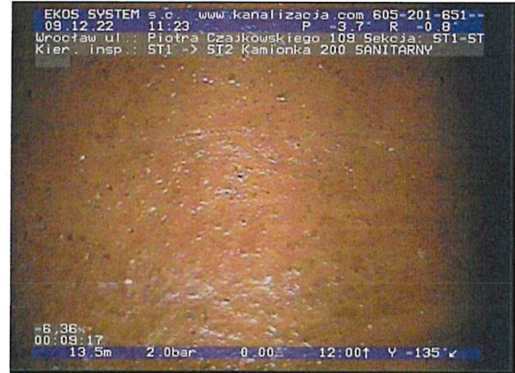
ST1-ST2-foto_nr-091.jpg, 00:09:17, 13.51 m Złamanie złożone - wyraźne otwarcie ścian przewodu, fragmenty obecne na swoim miejscu, szer.: 1mm od 12 godz. do 12 godz., Koniec obserwacji
