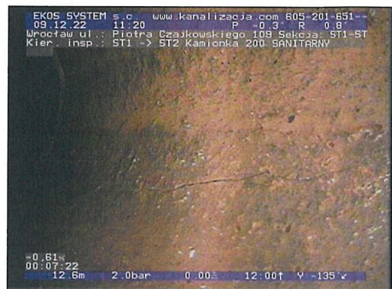
ST1-ST2-foto_nr-086.jpg, 00:07:23, 12.61 m Pęknięcie wzdłużnie, widoczne linie pęknięcia, fragmenty nadal obecne na swoim miejscu, szer.: 1mm na 6 godz., Początek obserwacji
