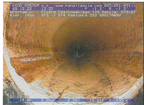
ST3-ST4-foto_nr-119.jpg, 00:05:02, 14.42 m Pęknięcie obwodowo, widoczne linie pęknięcia, fragmenty nadal obecne na swoim miejscu, szer.: 1mm na 6 godz.
