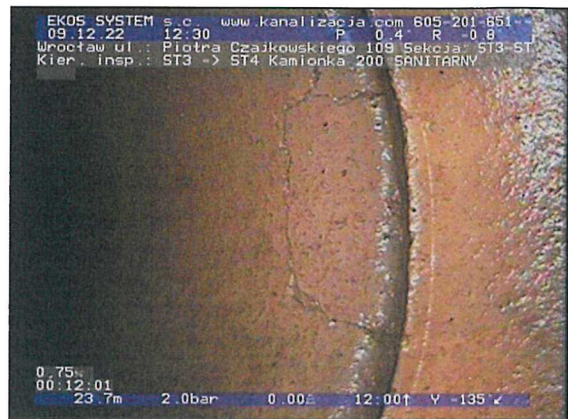
ST3-ST4-foto_nr-129.jpg, 00:12:01, 23.79 m Pęknięcie obwodowo, widoczne linie pęknięcia, fragmenty nadal obecne na swoim miejscu, szer.: 1mm od 12 godz. do 1 godz.
