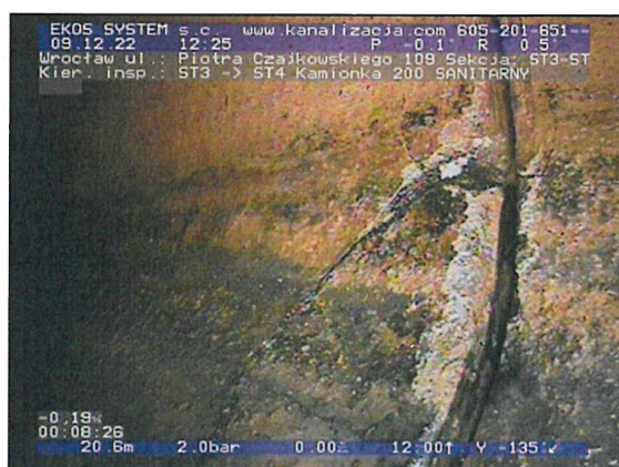
ST3-ST4-foto_nr-123.jpg, 00:08:26, 20.69 m Pęknięcie obwodowo, widoczne linie pęknięcia, fragmenty nadal obecne na swoim miejscu, szer.: 1mm od 4 godz. do 8 godz.
