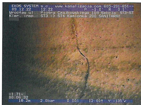
ST3-ST4-foto_nr-121.jpg, 00:06:32, 18.21 m Pęknięcie obwodowo, widoczne linie pęknięcia, fragmenty nadal obecne na swoim miejscu, szer.: 1mm od 12 godz. do 12 godz.
