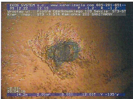
ST3-ST4-foto_nr-118.jpg, 00:04:16, 14.21 m Inne uszkodzenie powierzchniowe, brakująca ściana, przyczyna nie jest jednoznaczna na 10 godz.
