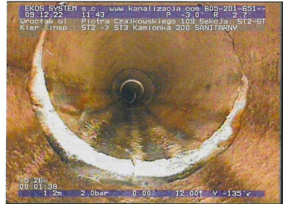
ST2-ST3-foto_nr-096.jpg, 00:01:38, 1.28 m Przemieszczone złącze, odchylenie rur pod kątem na 6 godz.
