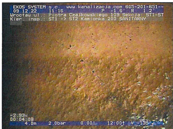
ST1-ST2-foto_nr-083.jpg, 00:04:07, 4.03 m Pęknięcie wzdłużnie, widoczne linie pęknięcia, fragmenty nadal obecne na swoim miejscu, szer.: 1mm na 3 godz., Początek obserwacji
