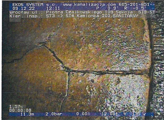
ST3-ST4-foto_nr-116.jpg, 00:00:00, 11.33 m Złamanie złożone - wyraźne otwarcie ścian przewodu, fragmenty obecne na swoim miejscu, szer.: 1mm od 5 godz. do 7 godz.
