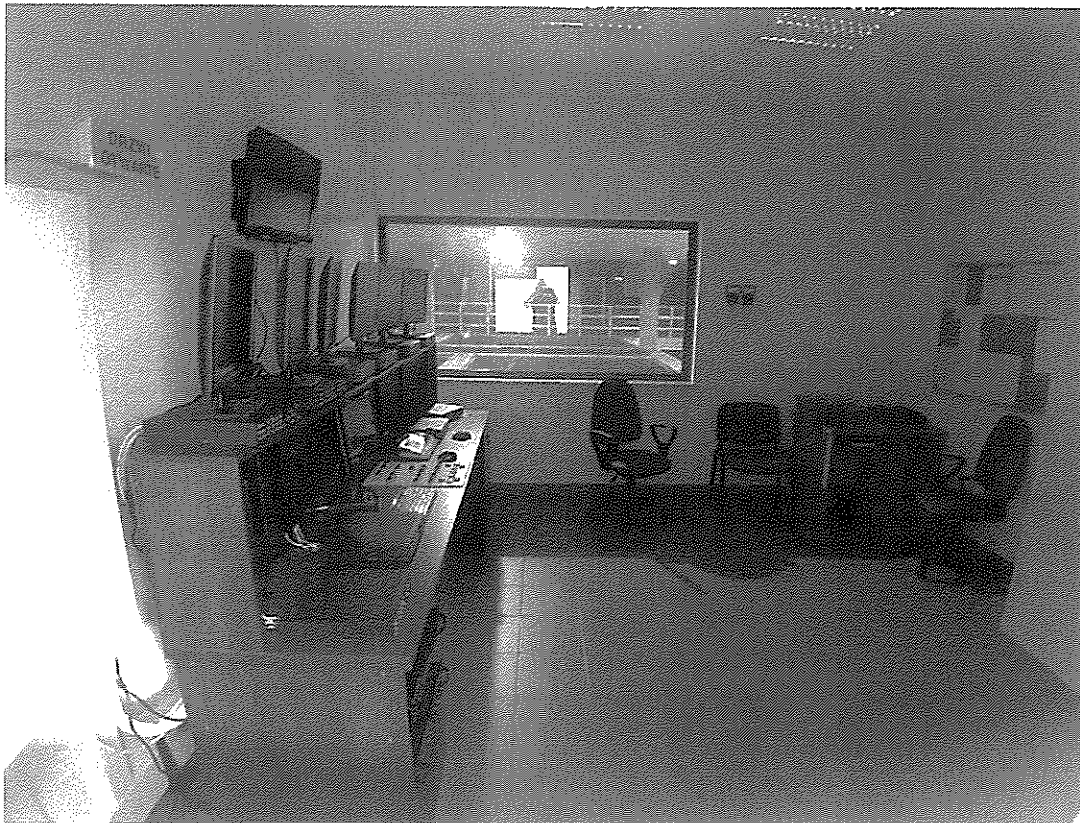
Budynek nr 112 – sterownia oś „T”
