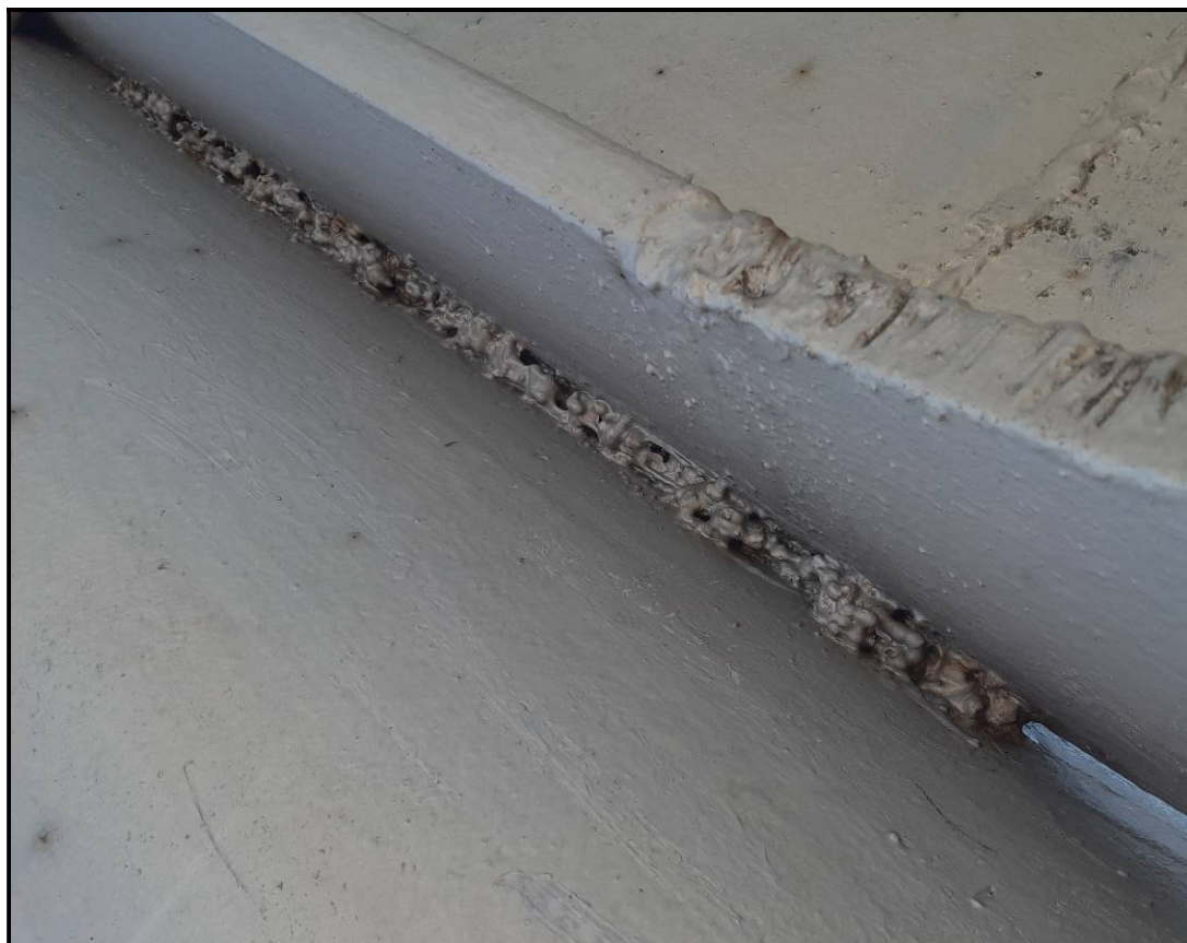
Fot.7 Spoina łącząca słup nr 2 ze środkowym kłosem. Liczne niezgodności złącza spawanego.
