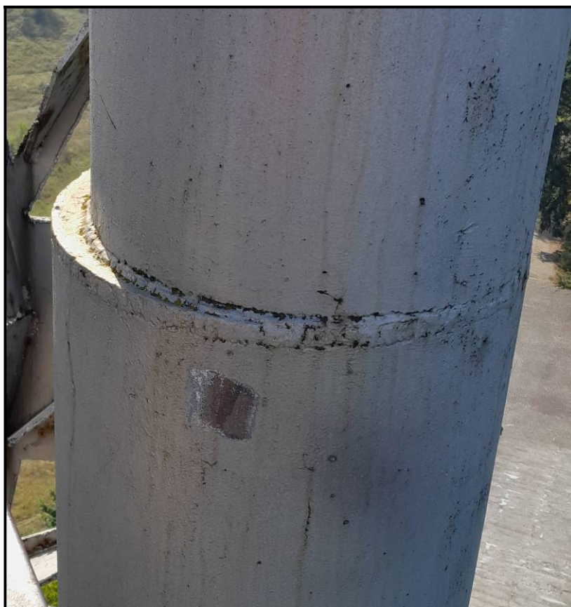
Fot.3 Widok z boku na łączenie segmentów 1-2 na słupie nr 1. Widoczne punktowe ogniska korozji.
