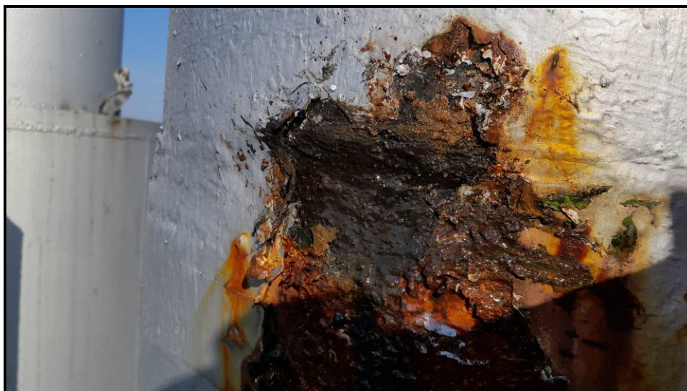
Fot.4 Widok z boku na łączenie segmentów 1-2 na słupie nr 2. Widoczne bardzo silne ognisko korozji.
