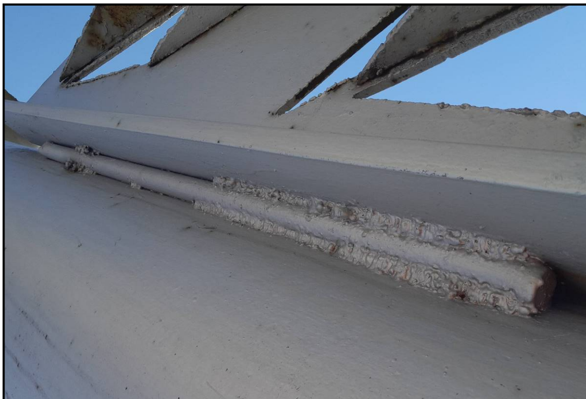
Fot.6 Spoina łącząca słup nr 2 ze środkowym kłosem. Niedopuszczalna jakość wykonania złącza spawanego.
