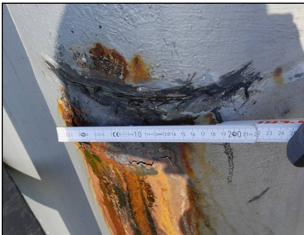
Fot.11 Pomiar długości pęknięcia spoiny
