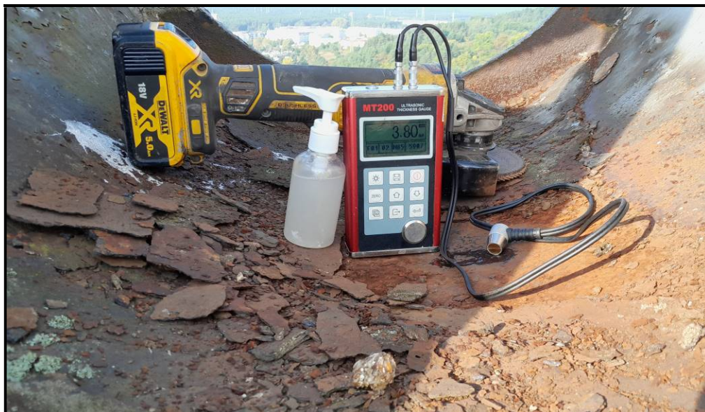
Fot.14 Badania grubości stali grubościomierzem ultradźwiękowym w miejscu największej korozji łoża kłosa nr 1
