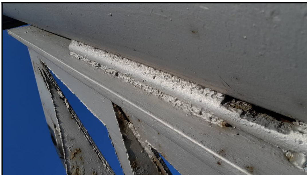
Fot.8 Spoina łącząca słup nr 3 ze środkowym kłosem. Niedopuszczalna jakość wykonania złącza spawanego.
