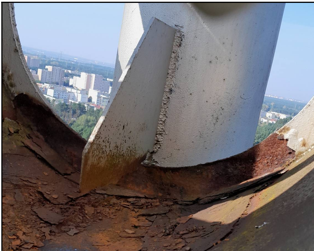
Fot.5 Widok z na łożo kłosa między słupami 1-2-3. Widoczne bardzo silne ognisko korozji łoża oraz zerwanie ciągłości żebra scalającego konstrukcję.
