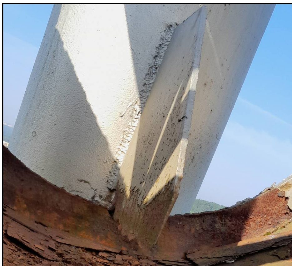
Fot.9 Niepoprawnie wykonane spoiny żebra scalającego kłos między słupami 1-2-3.
