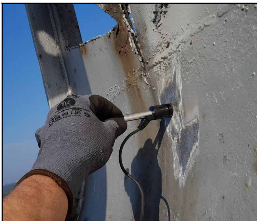
Fot.16 Badania twardości stali w miejscu referencyjnym na ścianie pionowej kłosa nr 1
