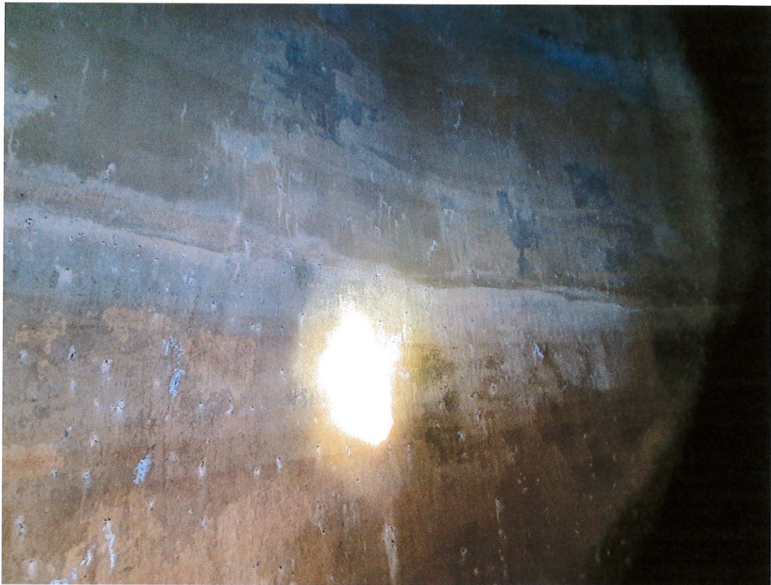
Zdjęcie 11. Ściana zewnętrzna – widoczne drobne ślady przecieków
