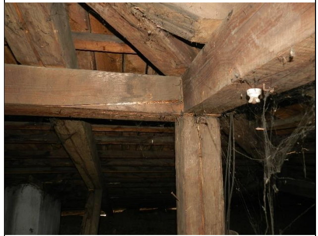
Fot. 20. Uszkodzona płatew na połączeniu połaci wschodniej oraz północnej.
