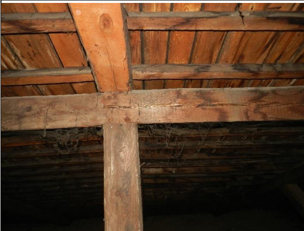
Fot. 21. Uszkodzenie płatwi na ramie stolcowej południowej.
