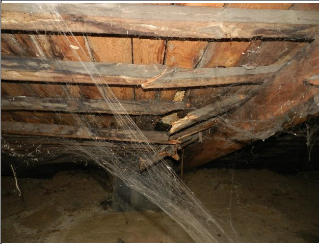
Fot. 17. Uszkodzenie deskowania na połaci południowej.
