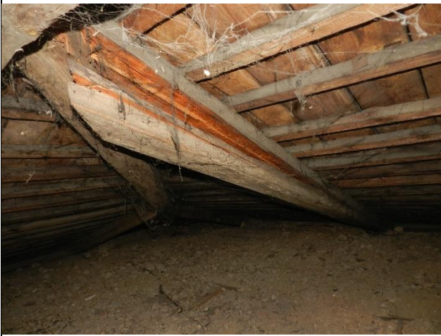
Fot. 19. Uszkodzenie krokwi na połaci wschodniej.
