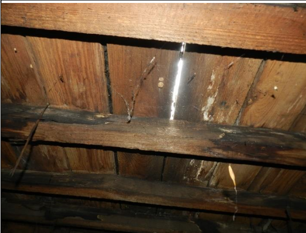
Fot. 23. Nieszczelności pokrycia dachowego na połaci północnej.
