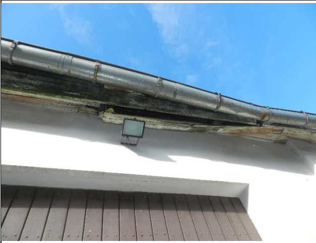
Fot. 05. Widok uszkodzonej rynny na elewacji wschodniej.
