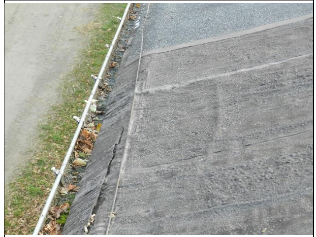
Fot. 06. Widok orynnowania na budynku, znacząco zanieczyszczone.
