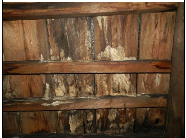
Fot. 22. Gniska korozji biologicznej na połaci północnej.
