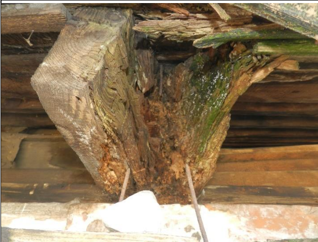
Fot. 27. Uszkodzenie końcówki belki stropowej w wyniku korozji biologicznej.
