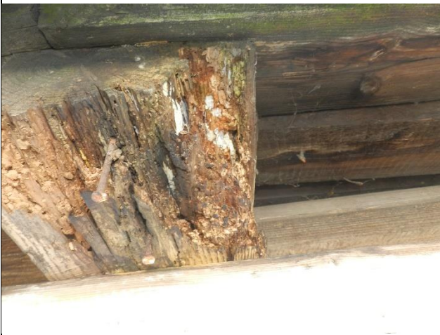
Fot. 25. Uszkodzenie końcówek belek stropowych na ścianach zewnętrznych.
