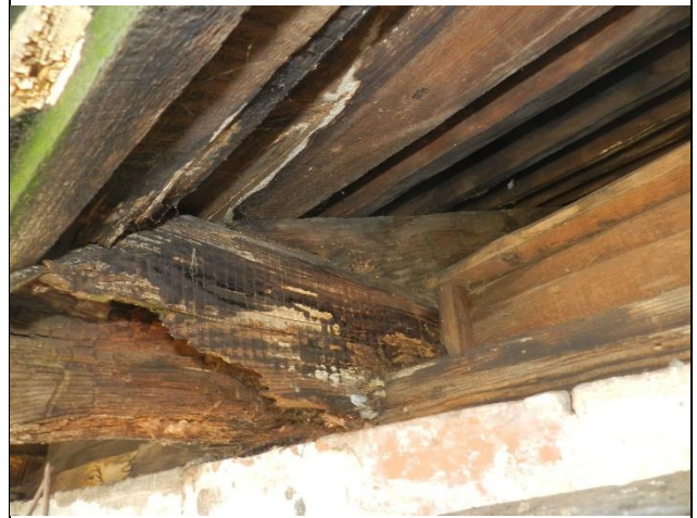
Fot. 26. Widok oparcia krokwi na belce stropowej (element uszkodzony – korozja biologiczna)
