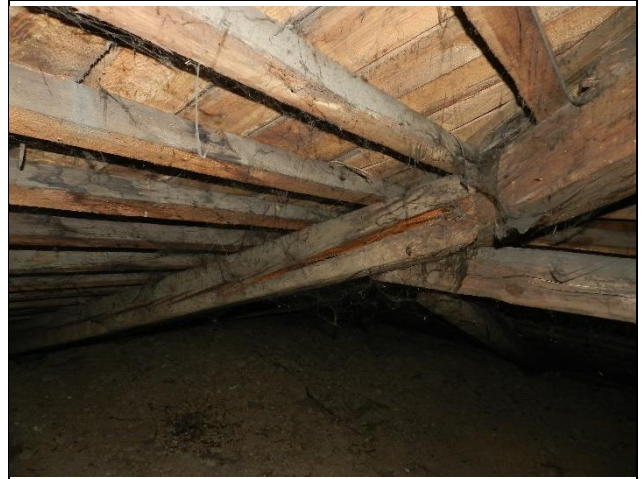
Fot. 18. Uszkodzenie krokwi na połaci północnej.
