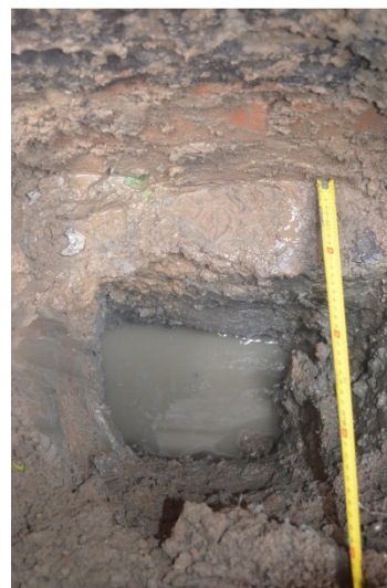
Fot. 3 – Brak izolacji poziomej, Woda gruntowa od ciśnieniem. Brak izolacji pionowej na warstwie podmurówki.
