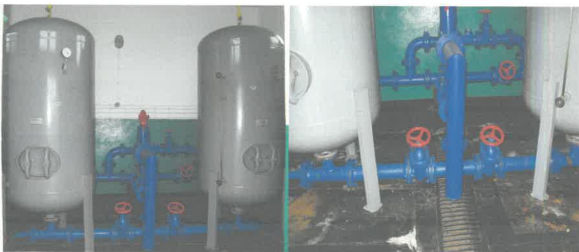
Zdj. nr 7 i 8. Zbiorniki hydroforowe V = 1500 l.
