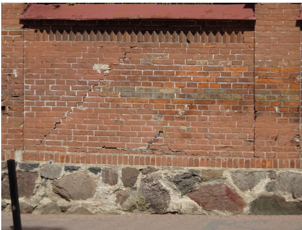
Fot. 18. Elewacja od strony ul. Armii Krajowej – widoczne pęknięcia muru, ubytki cegieł oraz spoinowania muru.
