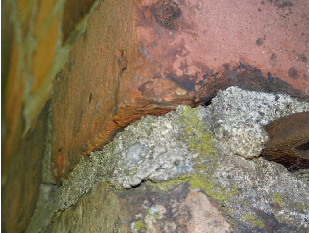
Fot. 37. Elewacja od strony wewnętrznej – widoczne mocne, wtórne spoinowanie oraz fragment mocowania bramy.
