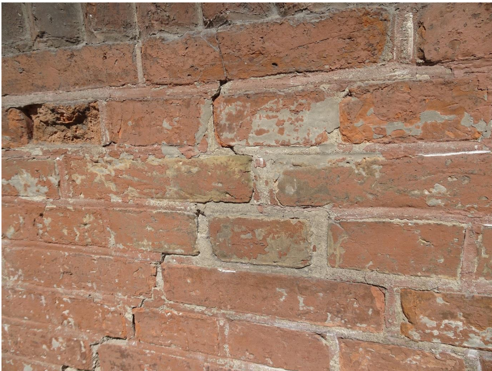
Fot. 22. Elewacja od strony ul. Armii Krajowej – widoczne spękania muru, wtórne spoinowanie zaprawą cementową oraz luszczące się warstwy wtórnej farby.
