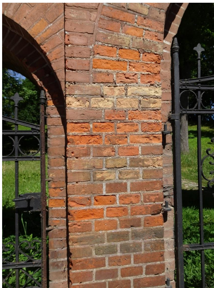
Fot. 24. Elewacja od strony ul. Armii Krajowej – widoczne zniszczenia cegieł na skutek wykonania cementowej, szczelnej spoiny.
