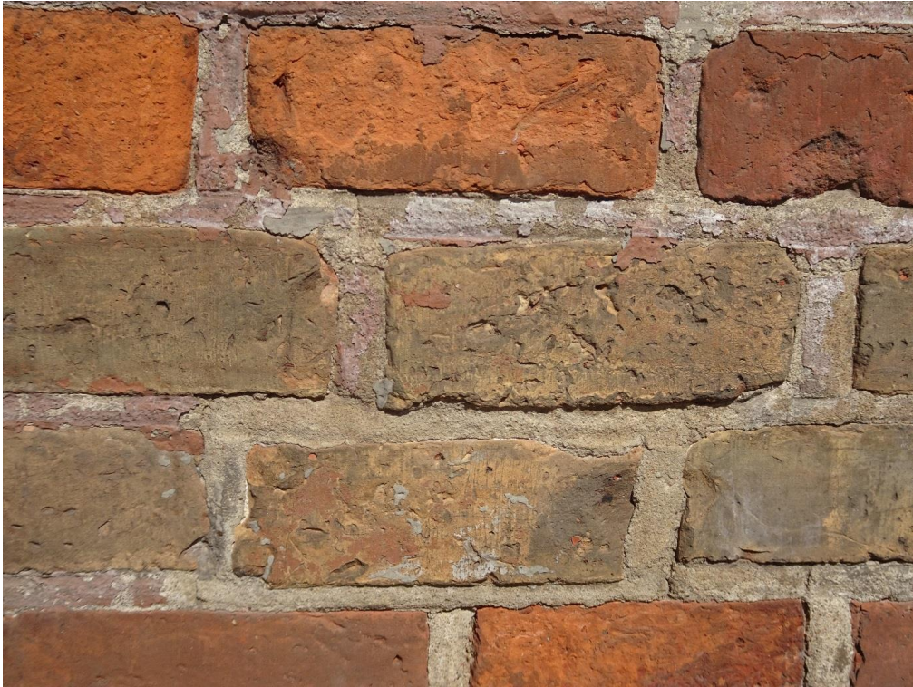
Fot. 21. Elewacja od strony ul. Armii Krajowej – spod przemalowań widać pasy dekoracji z żółtej cegły.
