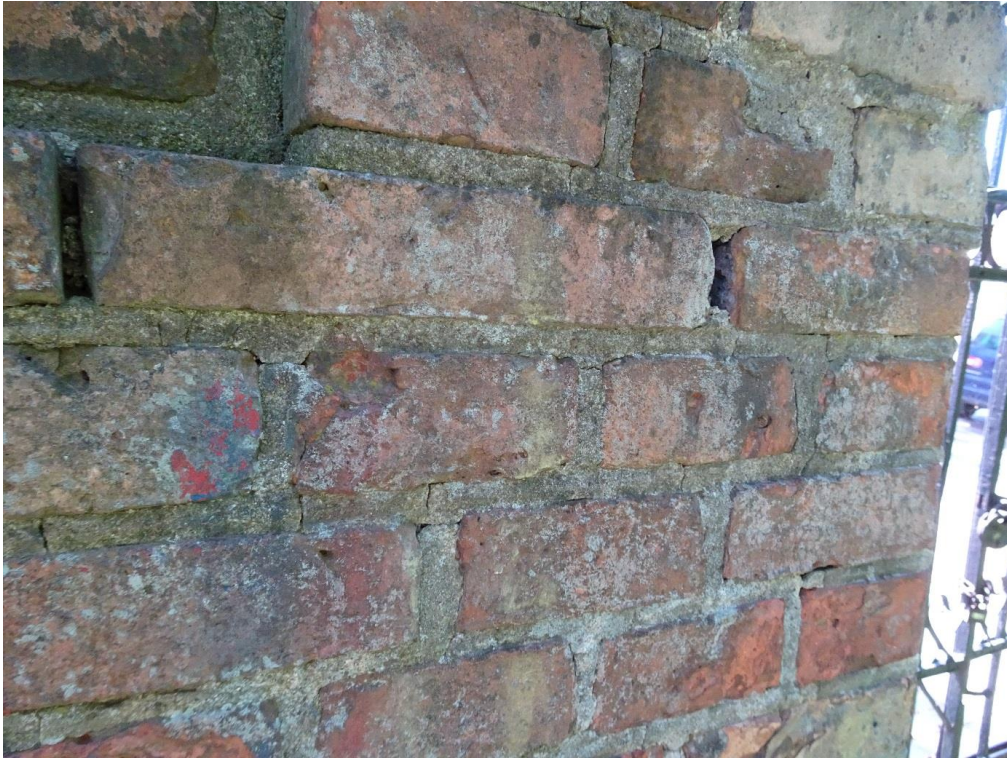
Fot. 31. Elewacja od strony wewnętrznej – widoczne wtórne spoinowanie, ubytki spoin oraz łuszcząca się farba. Ponadto elewacje pokrywają kolonie mikroorganizmów.
