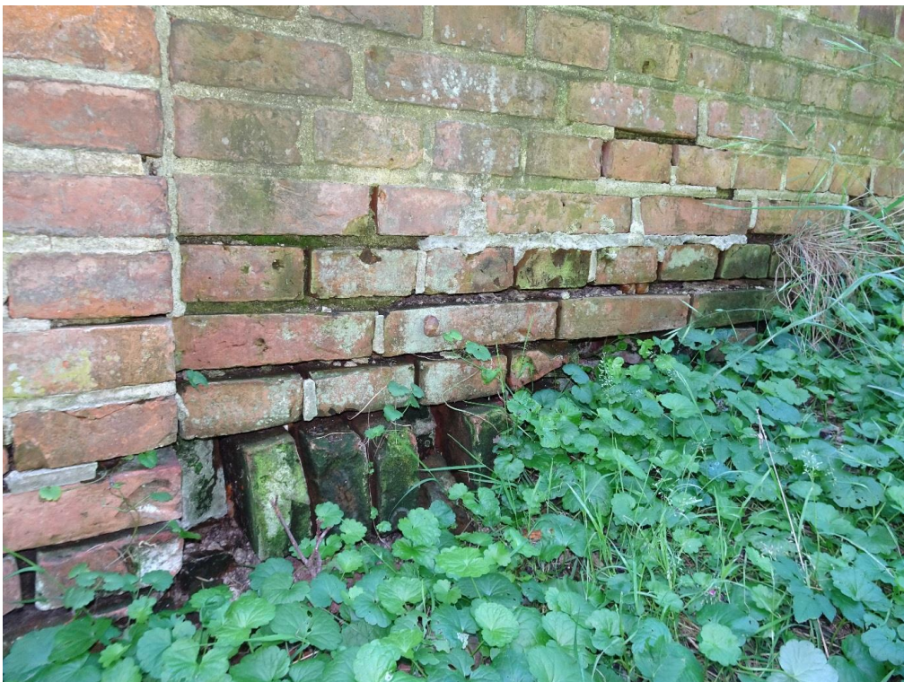
Fot. 32. Elewacja od strony wewnętrznej – widoczne wtórne spoinowanie, ubytki spoin oraz dezintegracja muru. Ponadto elewacje pokrywają kolonie mikroorganizmów.
