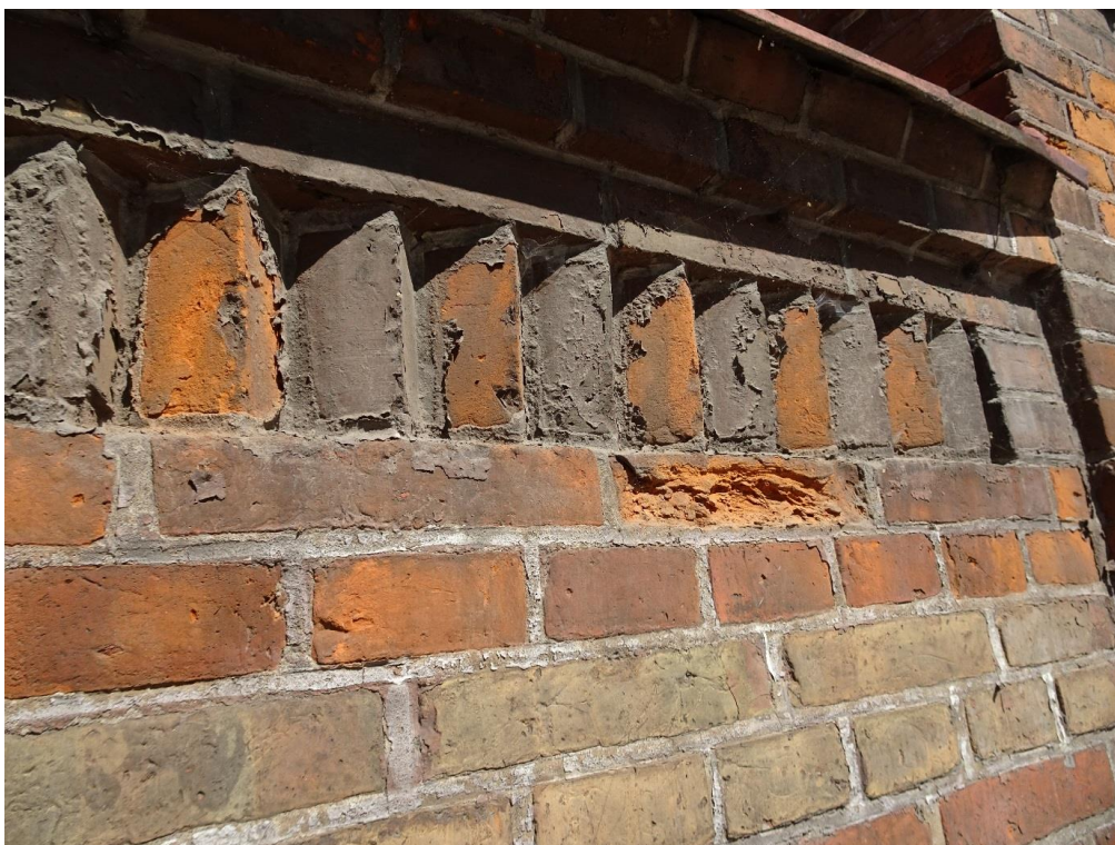
Fot. 33. Elewacja od strony zewnętrznej – widoczne wtórne spoinowanie oraz luszcząca się farba. Szczelne spoinowanie spowodowało zniszczenie cegieł.
