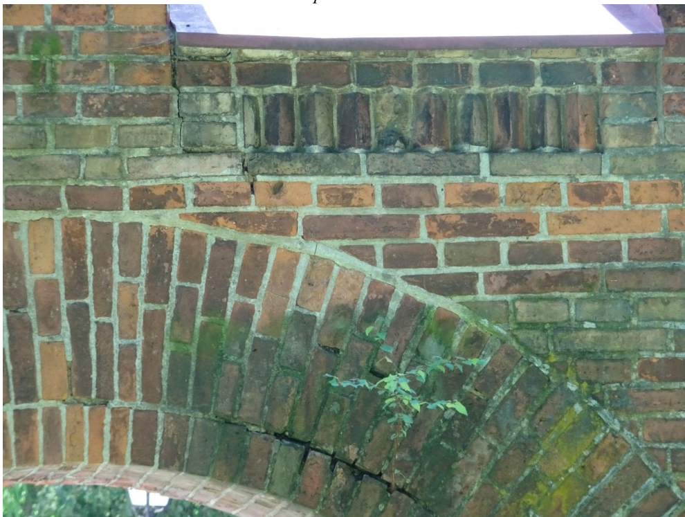
Fot. 28. Elewacja od strony wewnętrznej – widoczne ciemne zawilgocenia murów oraz ekspansja glonów i porostów. Mur porastają krzewinki, wilgoć tworzy sprzyjające rozwoju grzyba domowego.
