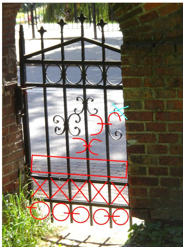
Fot. 6. Ogródzenie cmentarza – furtka prawa. Zaznaczone miejsca ubytków ażurowej dekoracji wypełniającej.
