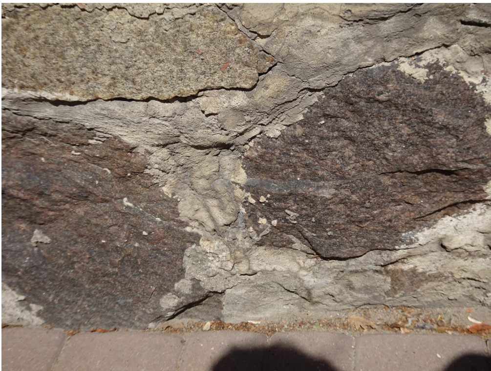
Fot. 36. Elewacja od strony zewnętrznej – widoczne wtórne spoinowanie kamiennego fundamentu. Spoina ulega systematycznej degradacji.
