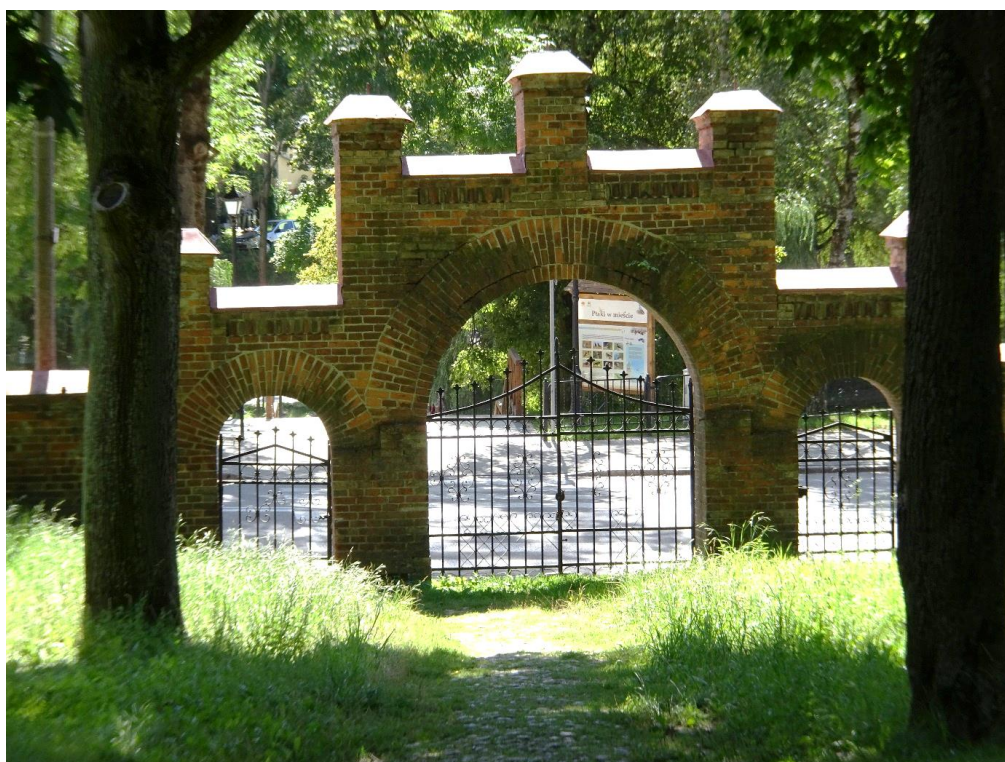
Fot. 26. Elewacja od strony wewnętrznej – widoczne ciemne zawilgocenia murów oraz ekspansja glonów i porostów.
