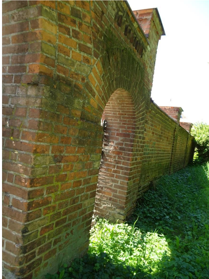
Fot. 27. Elewacja od strony wewnętrznej – widoczne ciemne zawilgocenia murów oraz ekspansja glonów i porostów.
