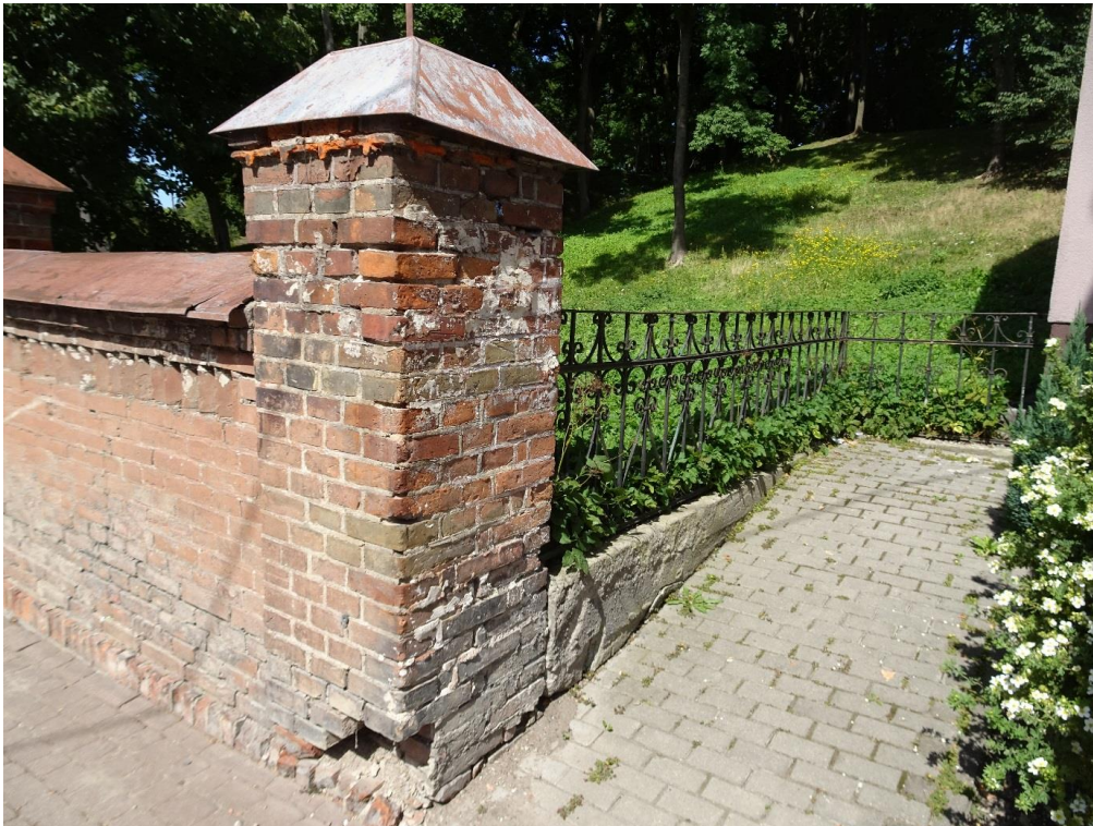
Fot. 19. Elewacja od strony ul. Armii Krajowej oraz ogrodzenie boczne wykonane z przęsł ogrodzeń kwater cmentarnych, posadowione na fundamencie betonowym.
