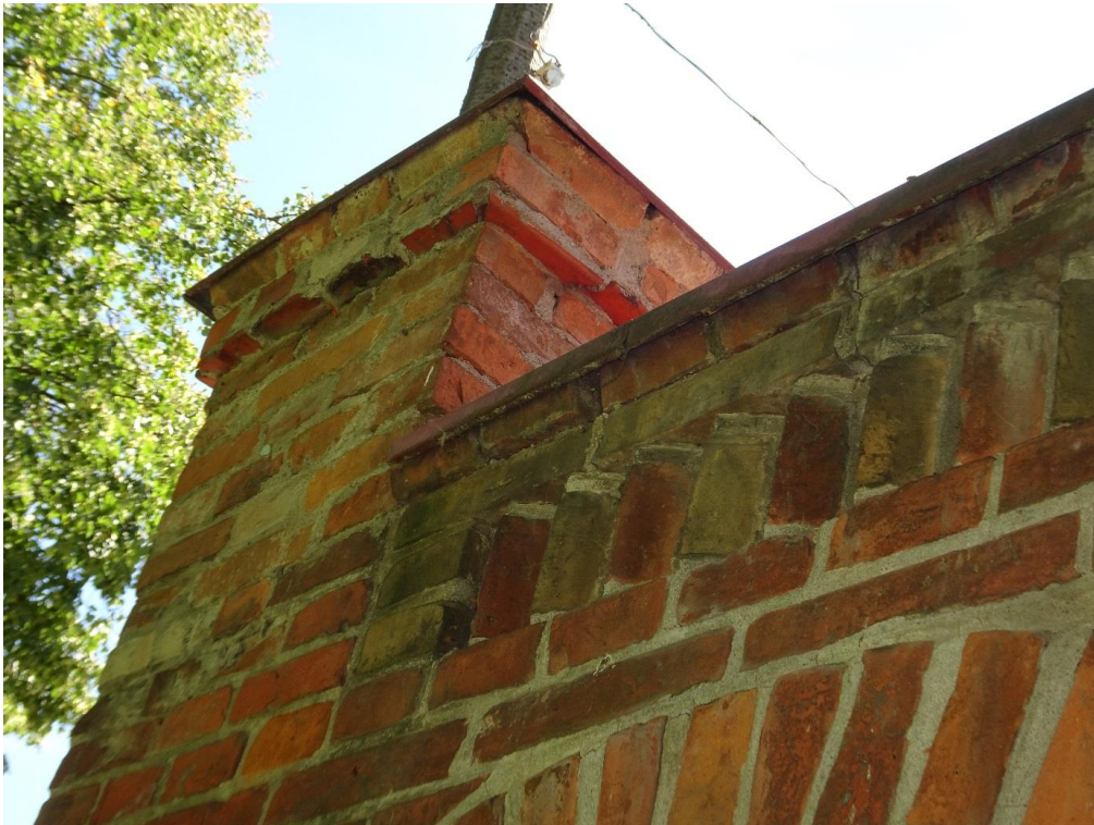
Fot. 29. Elewacja od strony wewnętrznej – widoczne przemurowania sterczyny oraz porosty i grzyby.
