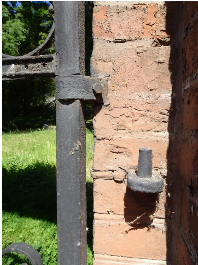
Fot. 40. Elewacja od strony zewnętrznej – kuta brama oraz fragmenty mocowania bramy. Element pionowy i obecne mocowanie - wtórne.
