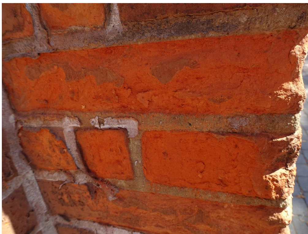
Fot. 34. Elewacja od strony zewnętrznej – widoczne wtórne spoinowanie oraz luszcząca się farba z namalowanymi spoinami. Szczelne spoinowanie spowodowało zniszczenie cegieł i zaprawy.
