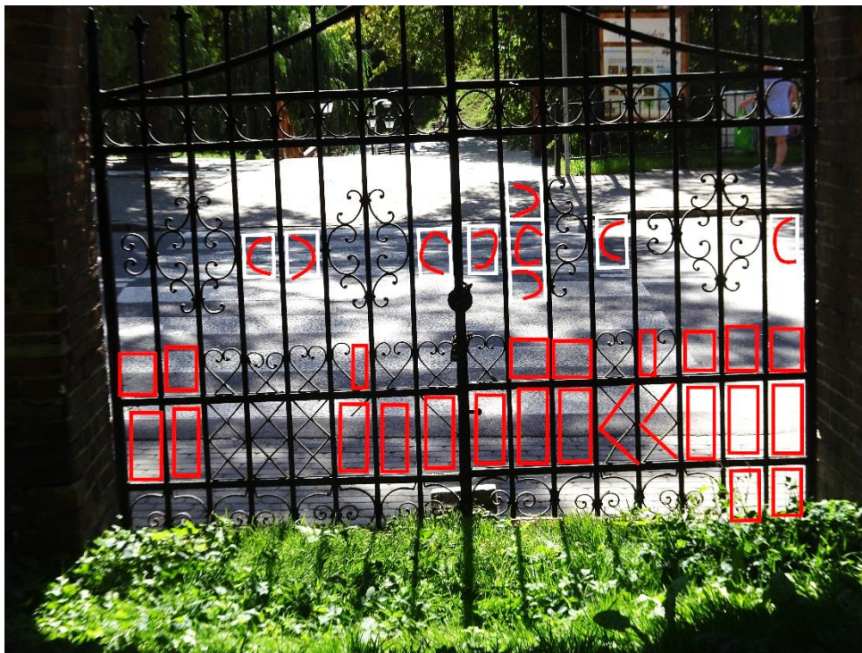
Fot. 5. Ogródzenie cmentarza – żeliwna brama wejściowa. Zaznaczone miejsca ubytków ażurowej dekoracji wypełniającej: wolut, rombów, esownic.
