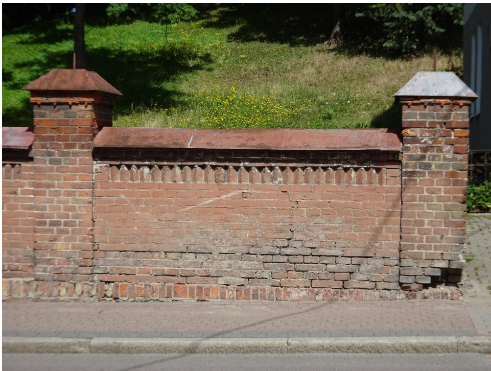
Fot. 17. Elewacja od strony ul. Armii Krajowej – widoczne pęknięcia muru, braki cegieł w narożniku oraz spoinowania muru.
