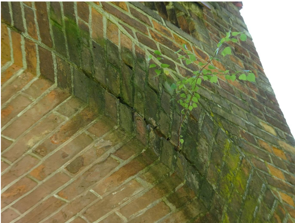
Fot. 30. Elewacja od strony wewnętrznej – widoczne ciemne zawilgocenia murów oraz ekspansja glonów i porostów. Mur porastają krzewinki, wilgoć tworzy sprzyjające rozwoju grzyba domowego.
