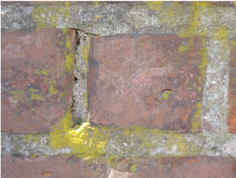
Fot. 38. Elewacja od strony wewnętrznej – widoczne mocne, wtórne spoinowanie oraz kolonie porostów.
