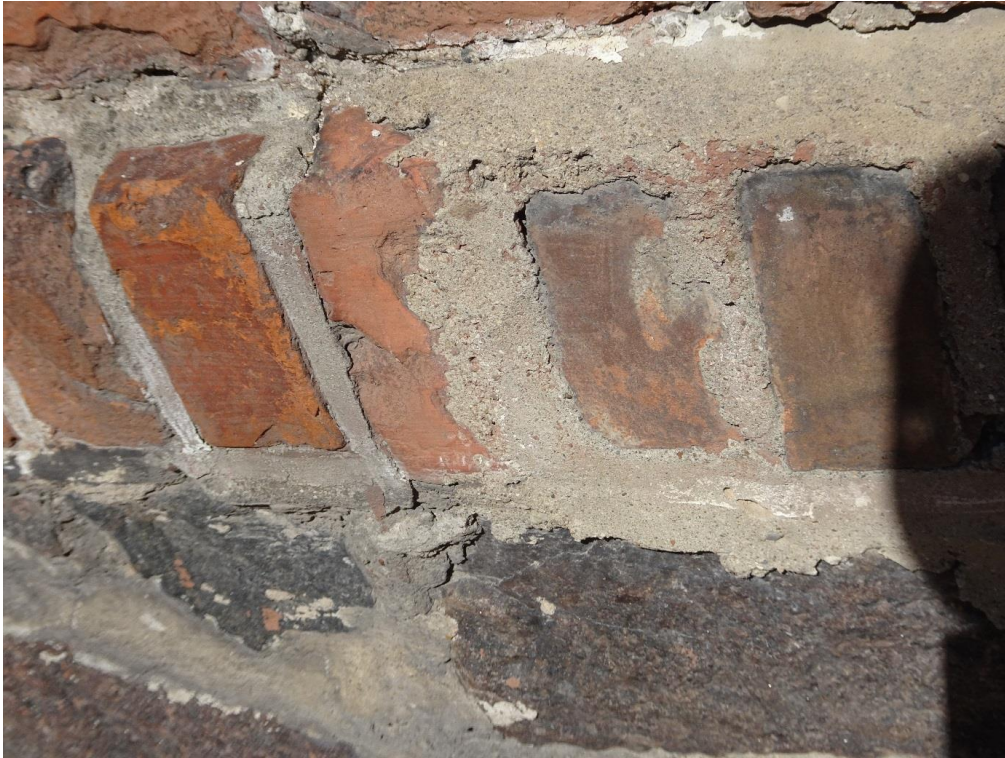
Fot. 35. Elewacja od strony zewnętrznej – widoczne wtórne spoinowanie wykonywane w różnych okresach. Fugi odspajają się.
