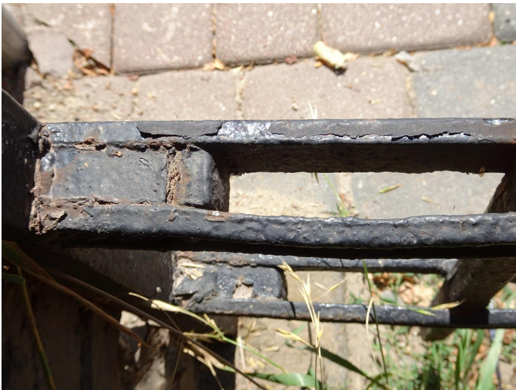
Fot. 44. Furtka lewa – widoczne wtórne luszczące się powłoki malarskie i ogniska korozji.
