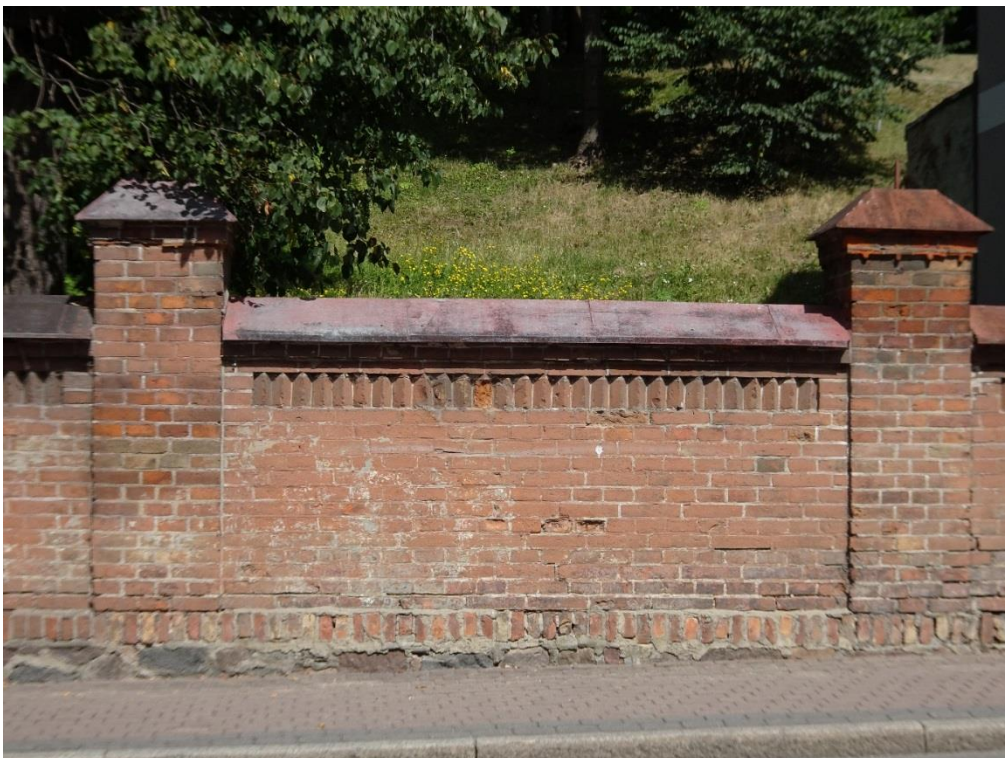
Fot. 16. Elewacja od strony ul. Armii Krajowej – widoczne zniszczenia cegieł i spoinowania oraz drzewo rosnące tuż przy murze.
