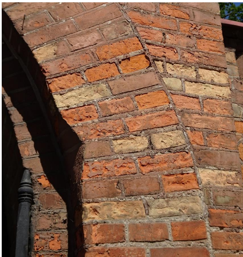
Fot. 25. Elewacja od strony ul. Armii Krajowej – widoczne zniszczenia cegieł na skutek wykonania cementowej, szczelnej spoiny. Wtórnie położona farba złuszcza się.
