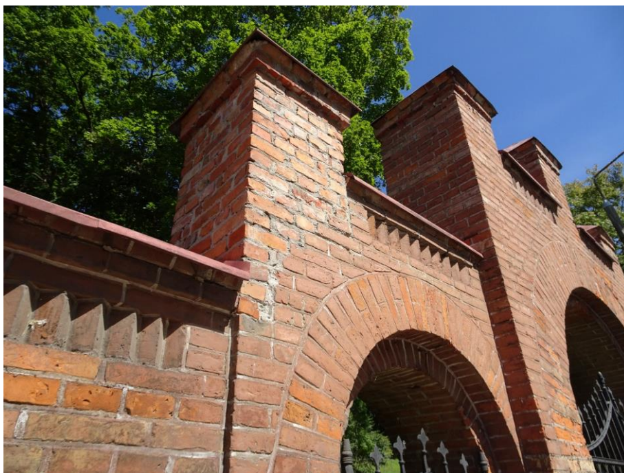
Fot. 23. Elewacja od strony ul. Armii Krajowej – widoczne przemurowanie sterczyny bramy wejściowej na cmentarz.
