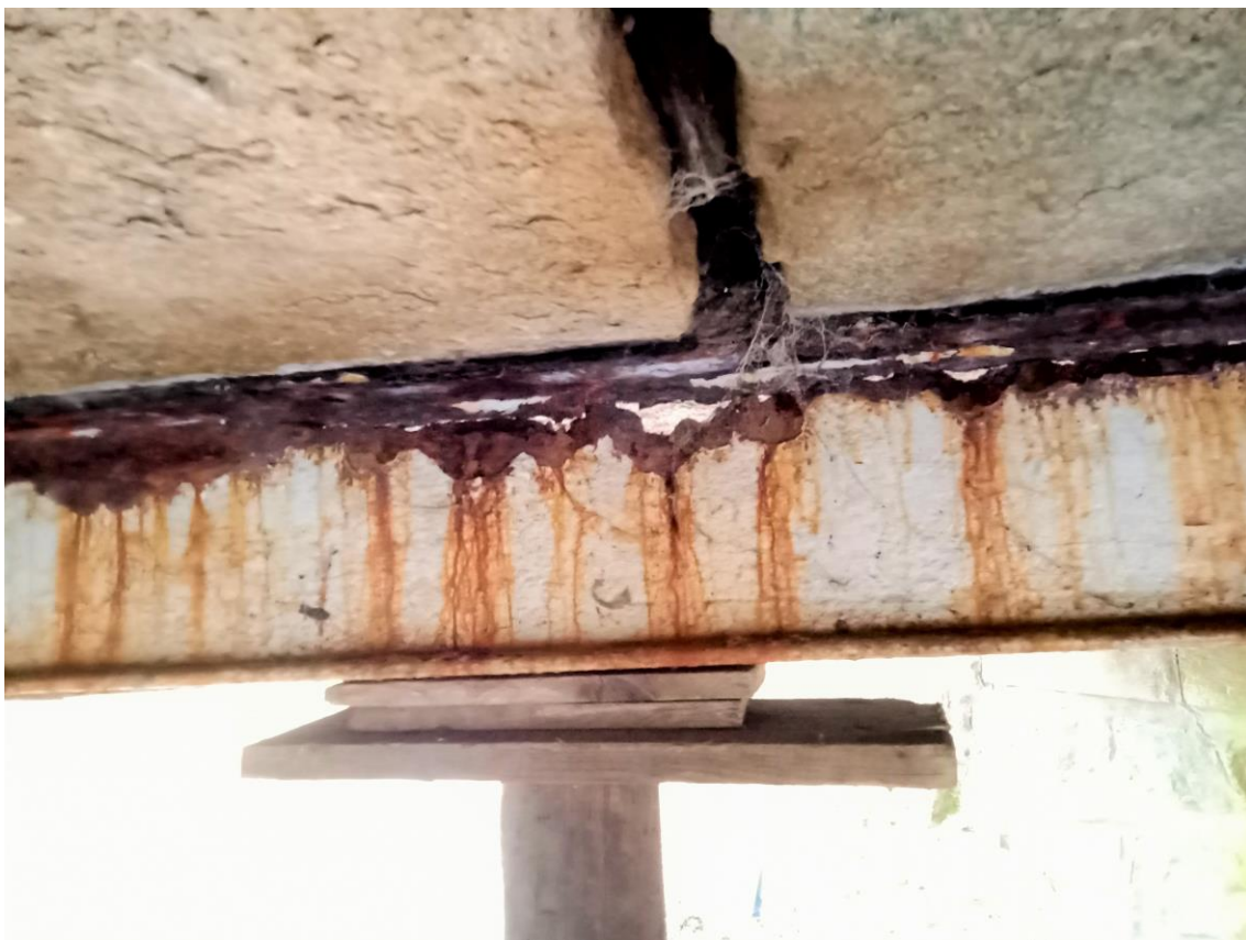
Foto nr 6. Dźwigar stalowy niosący. Ubytki średnicy, zniszczona struktura materiału, korozja stali;
