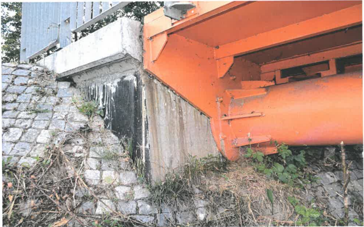
Fot. 11. Zanieczyszczenia betonu przyczółka.
