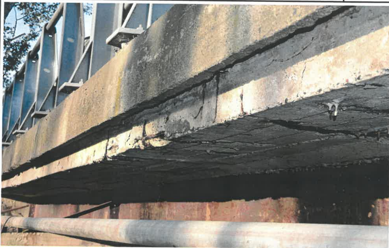
Fot. 5. Rysy i ubytki betonu oraz korozja stali zbrojeniowej konstrukcji pomostu.
