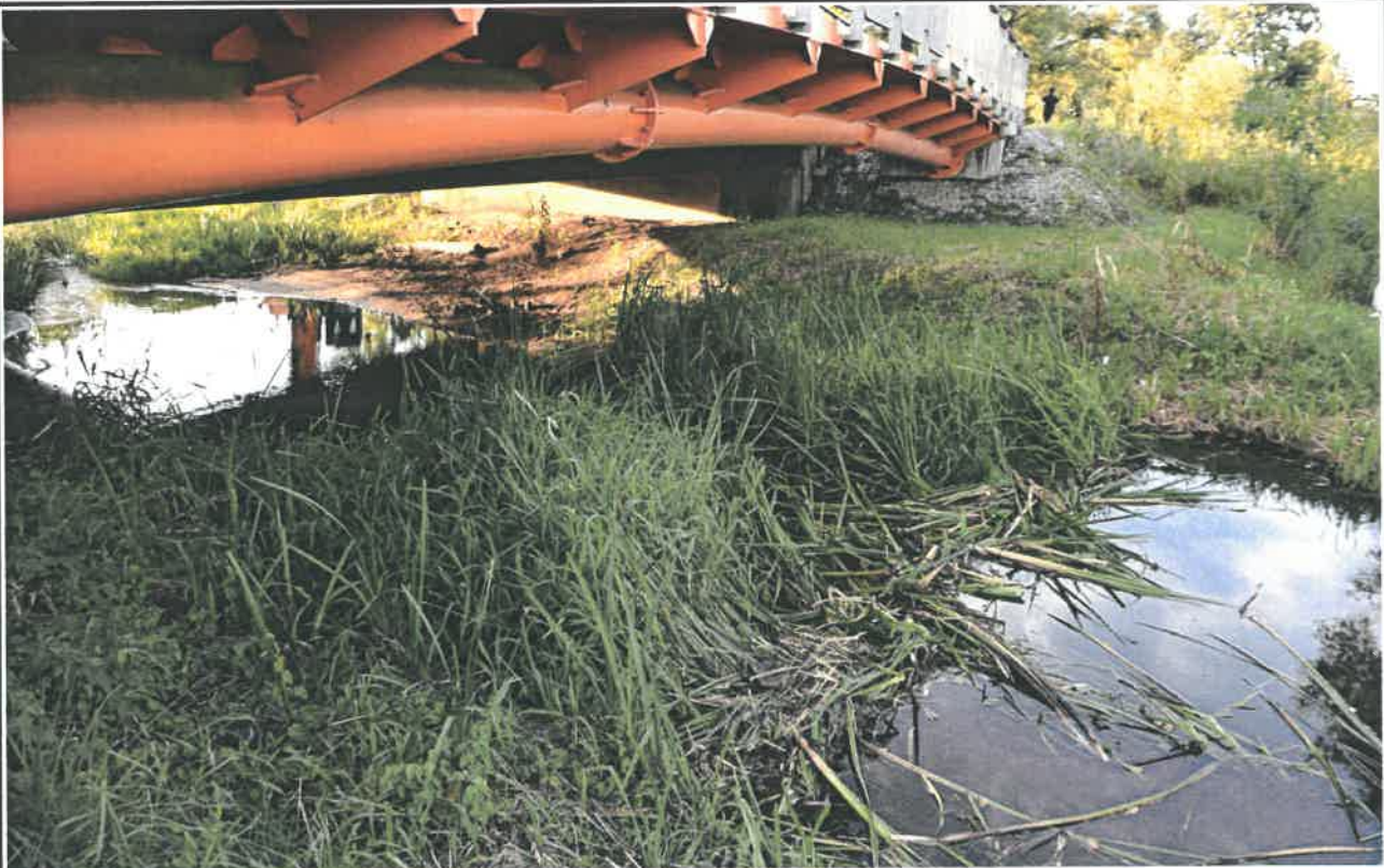
Fot. 12. Wegetacja roślinności w przestrzeni pod obiektem.
