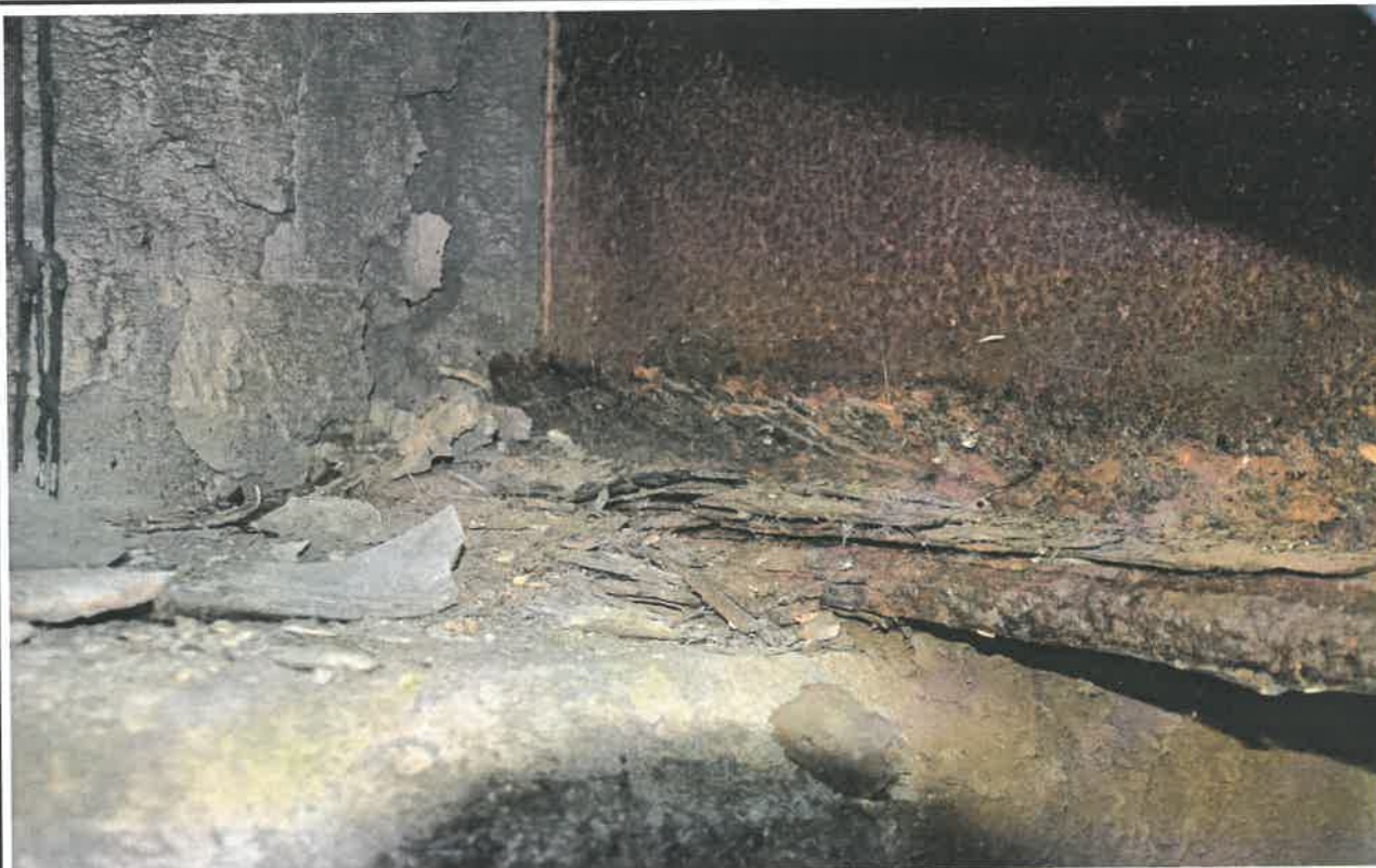
Fot. 7. Zniszczenie struktury materiału półki dolnej skrajnego dźwigara.
