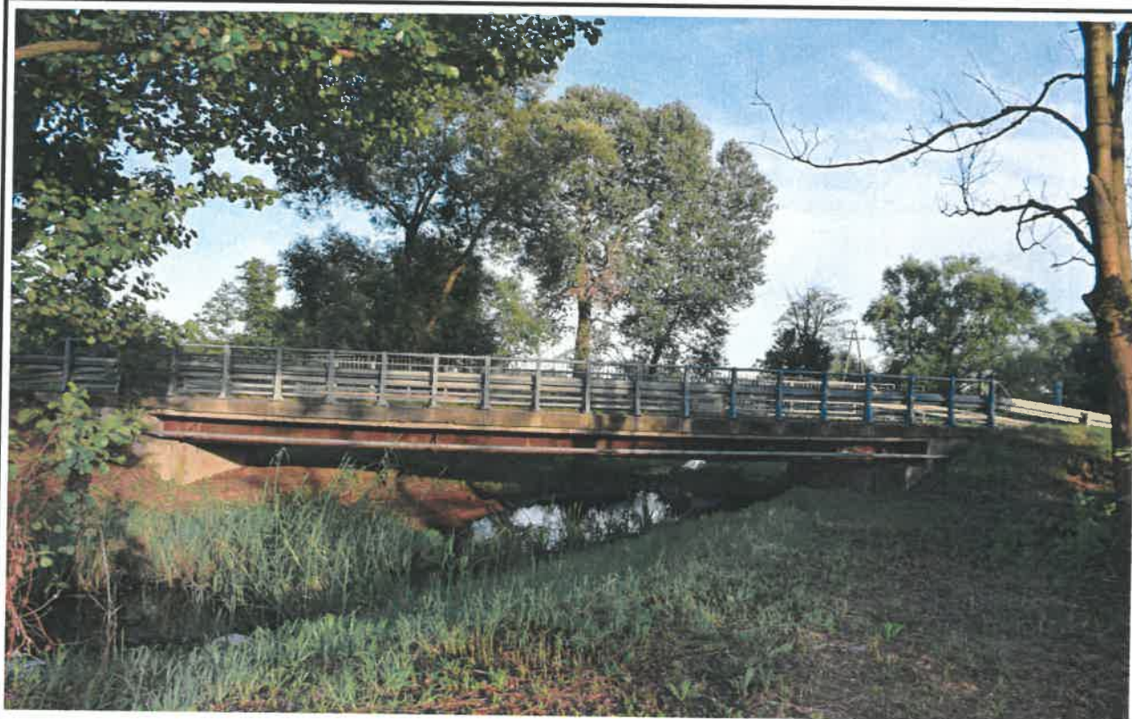
Fot. 2. Widok z boku od strony zachodniej.
