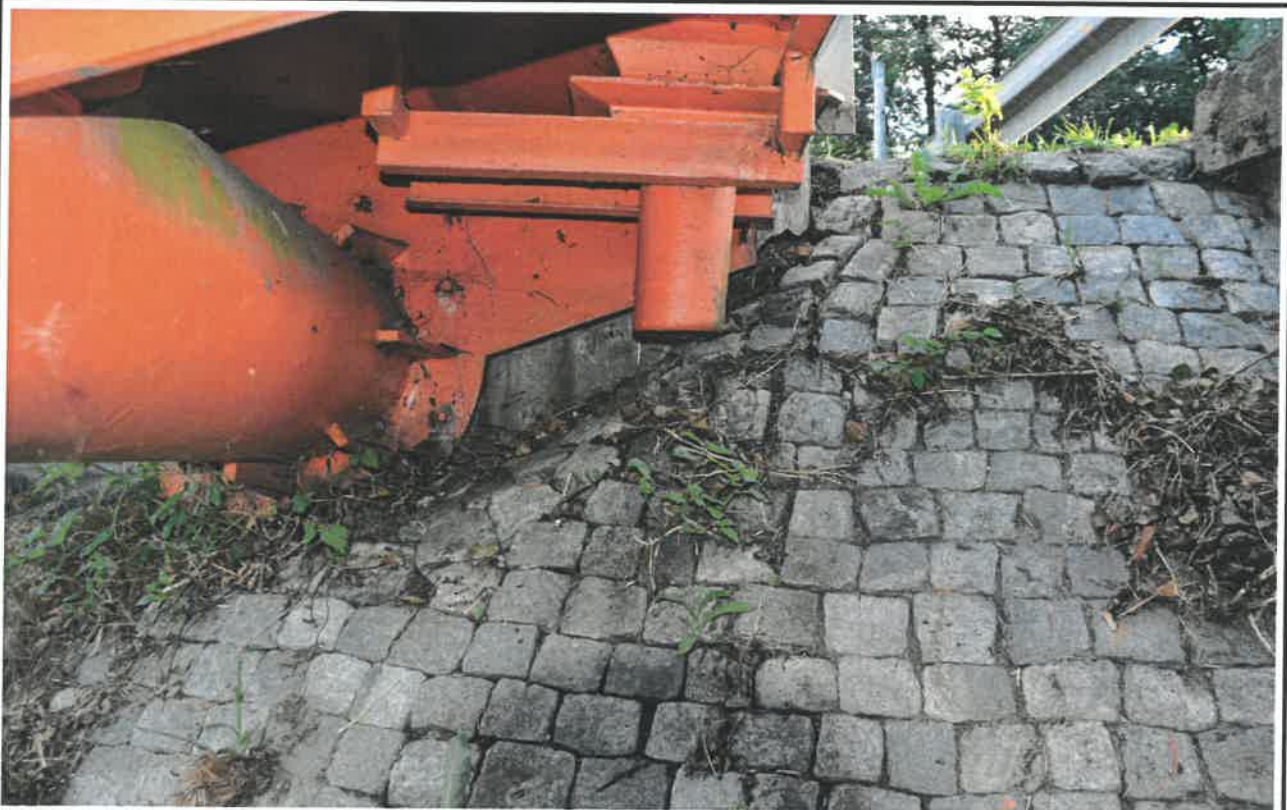
Fot. 10. Ubytki spoin kamiennego umocnienia skarp.
