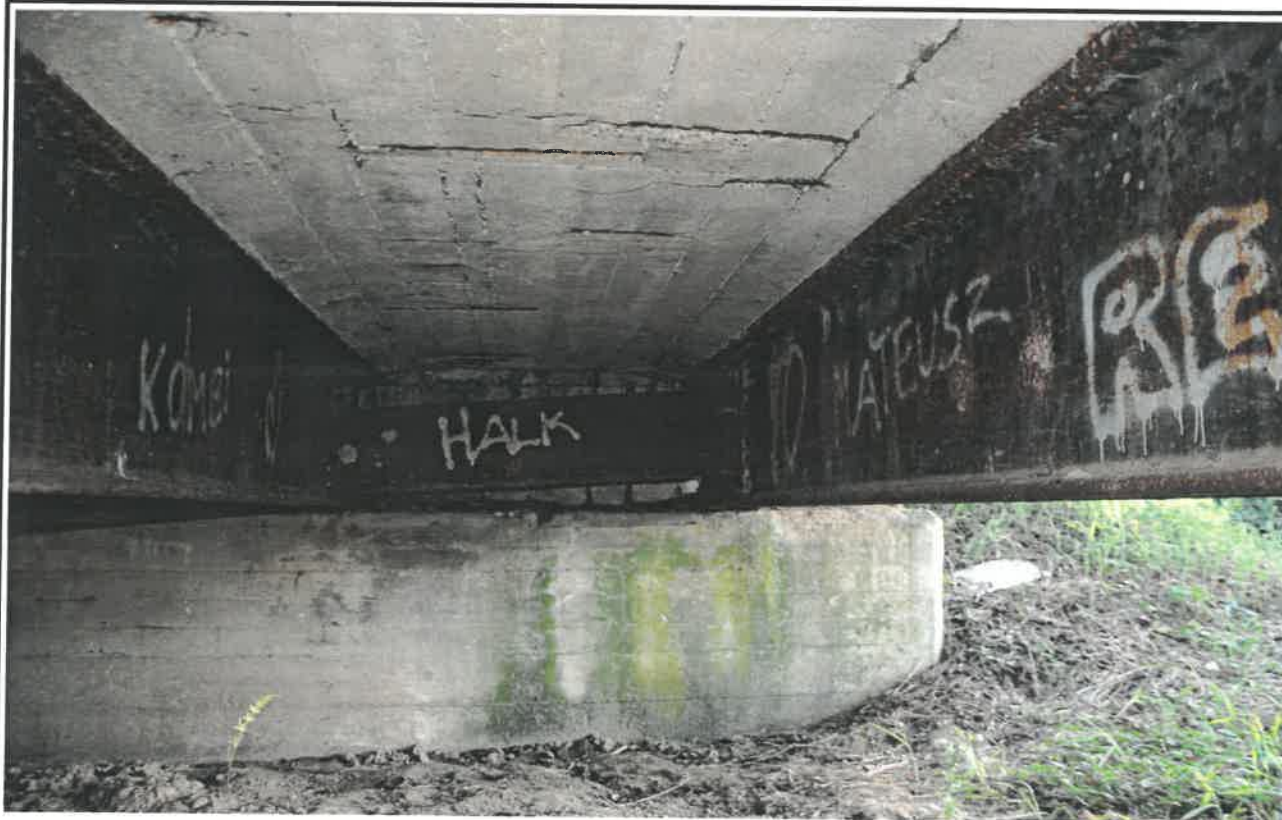
Fot. 6. Zanieczyszczenia (graffiti) oraz intensywna korozja dźwigarów stalowych.
