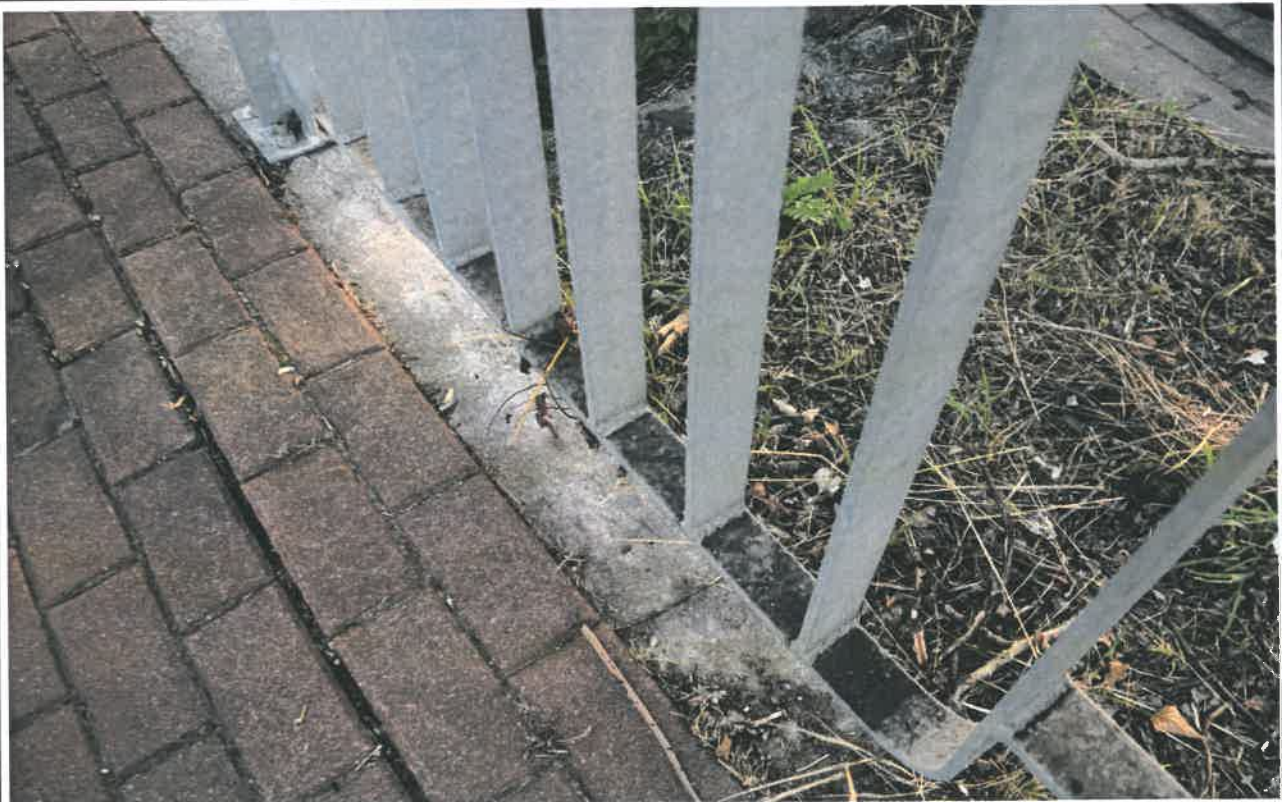
Fot. 7. Zanieczyszczenia balustrady.
