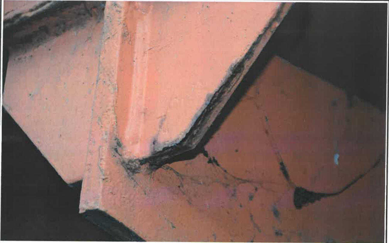
Fot. 9. Korozja dźwigara stalowego.
