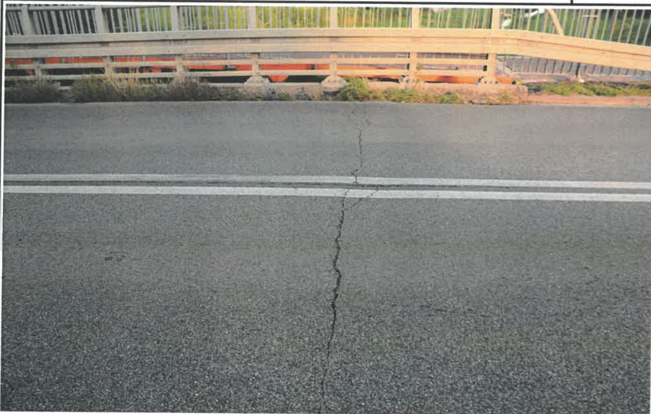
Fot. 9. Rysy nawierzchni bitumicznej w strefie dylatacji.
