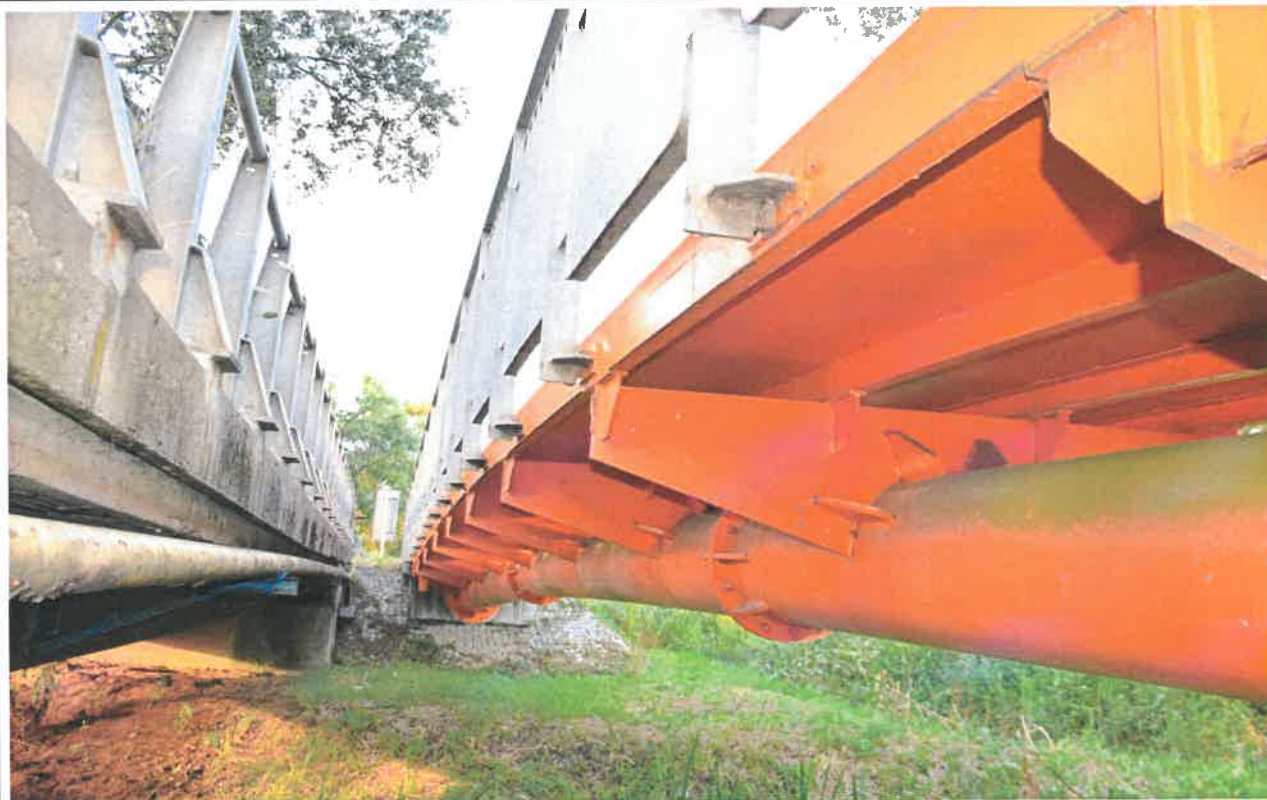
Fot. 3. Widok z boku od strony zachodniej.
