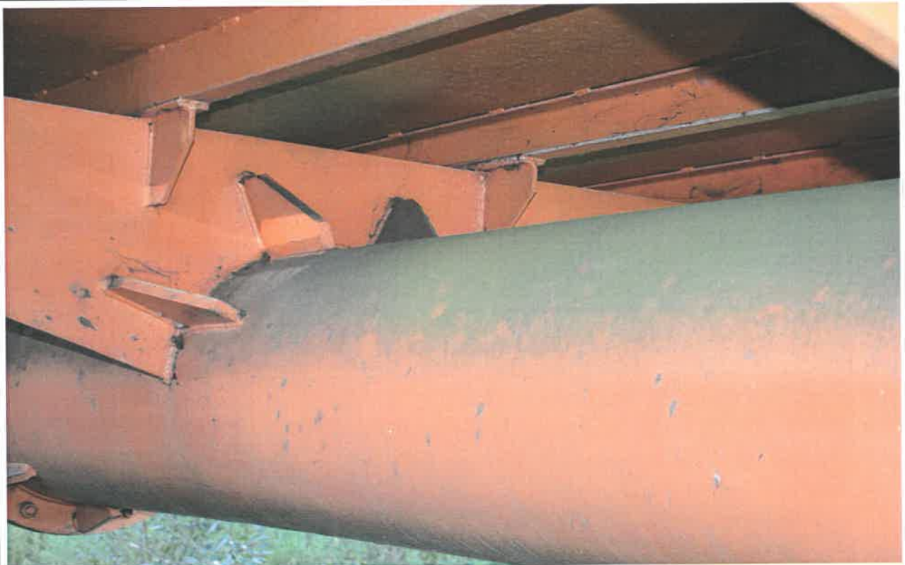
Fot. 8. Zanieczyszczenia dźwigara.
