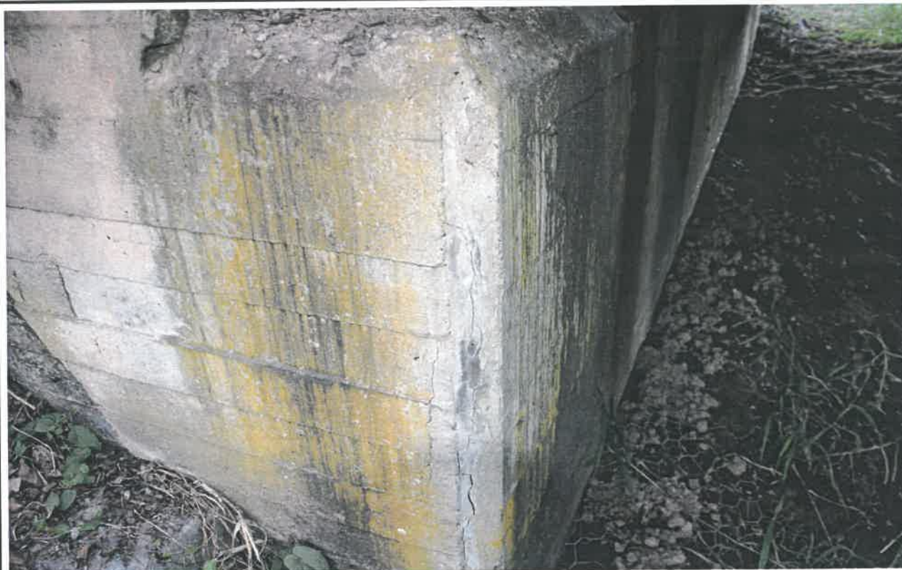
Fot. 8. Wegetacja porostów oraz rysy betonu przyczółka.
