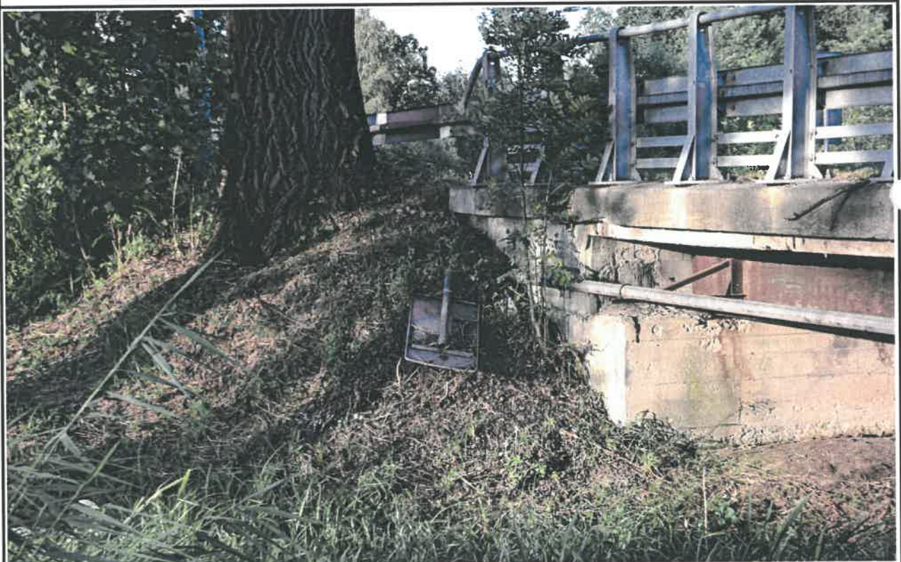
Fot. 12. Wegetacja roślinności oraz przewrócony znak U-9 na skarpie.
