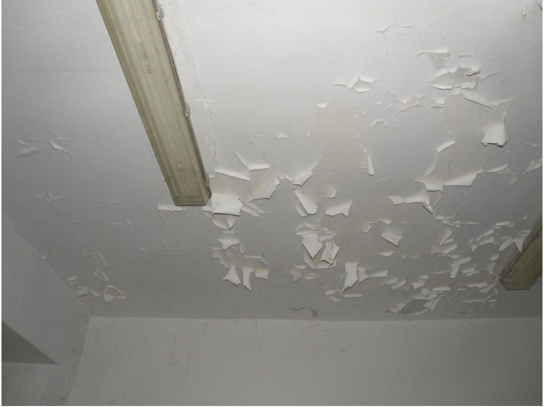
fot. 18 Widoczne uszkodzenia powłok malarskich sufitów
