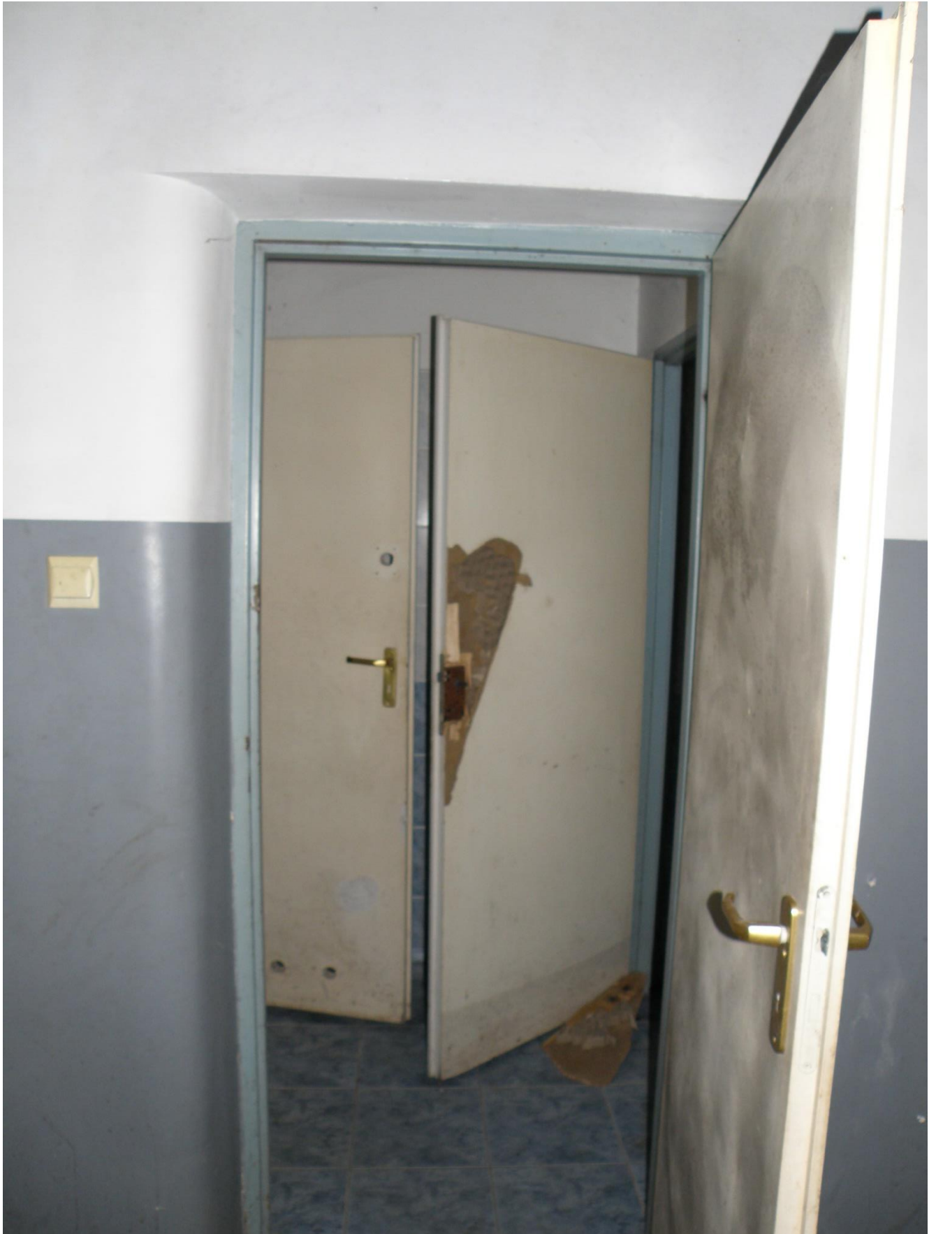
fot.17 Widoczne uszkodzenia stolarki drewnianej wewnętrznej
