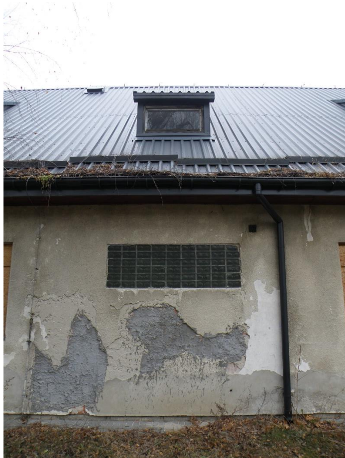
fot.16 Widoczne uszkodzenia tynków zewnętrznych
