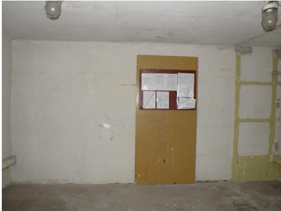
fot.13 Brak wykończenia warstwy posadzkowej oraz uszkodzenia wypraw wewnętrznych.
