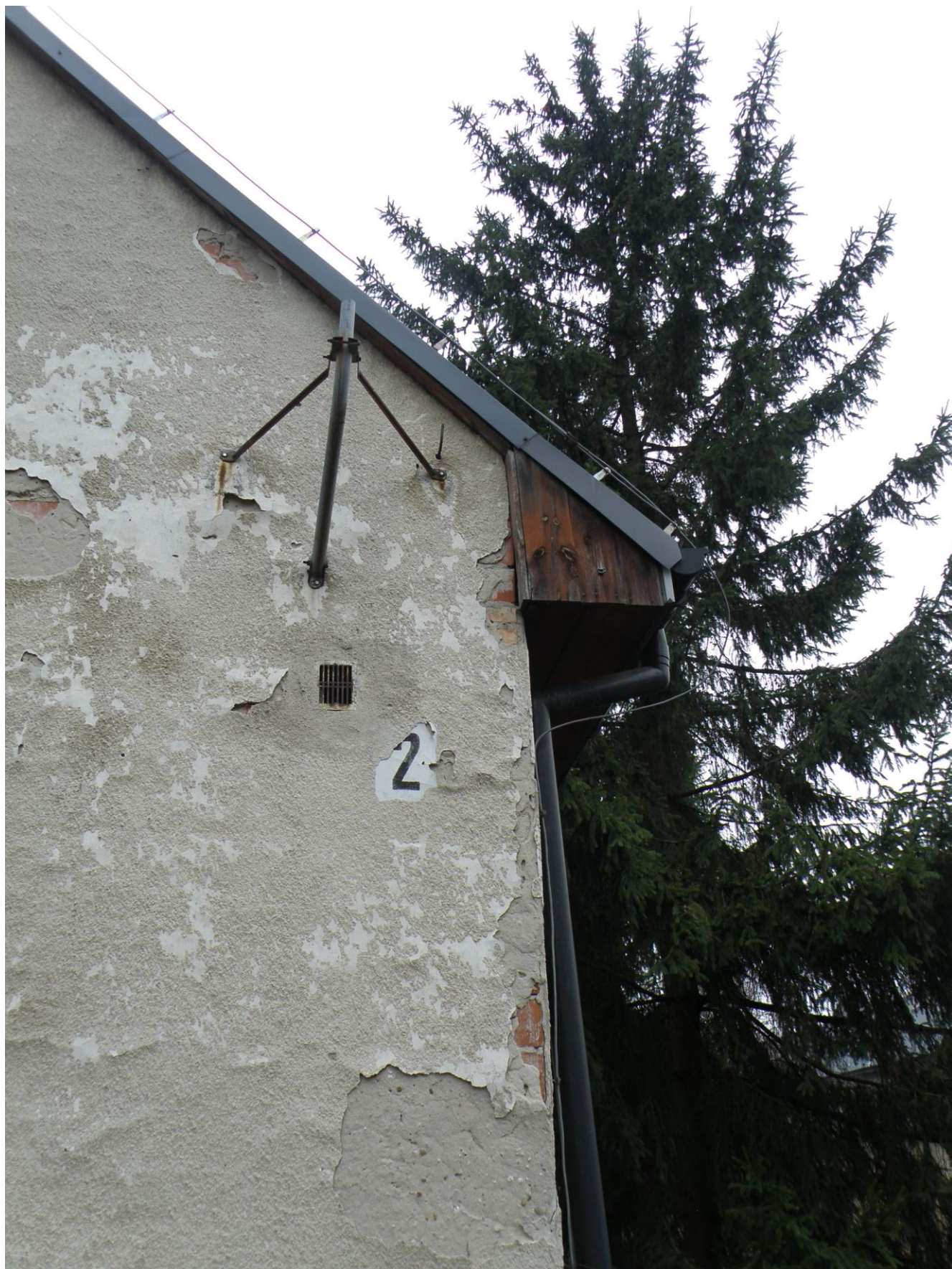
fot.2 Widok narożnika budynku od strony elewacji szczytowej – widoczne uszkodzenia tynków zewnętrznych. Obróbka blacharska oraz orynowanie w stanie Zadowolającym.
