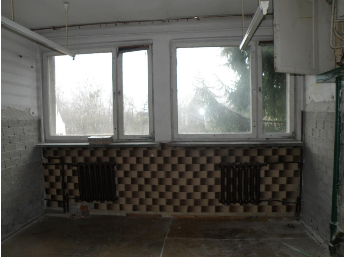
fot.7 Widoczny brak wypraw (tynków) wewnętrznych oraz okuć stolarki okiennej.
