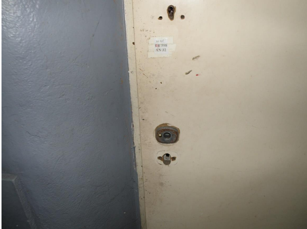
fot.23 Brak okuć stolarki wewnętrznej
