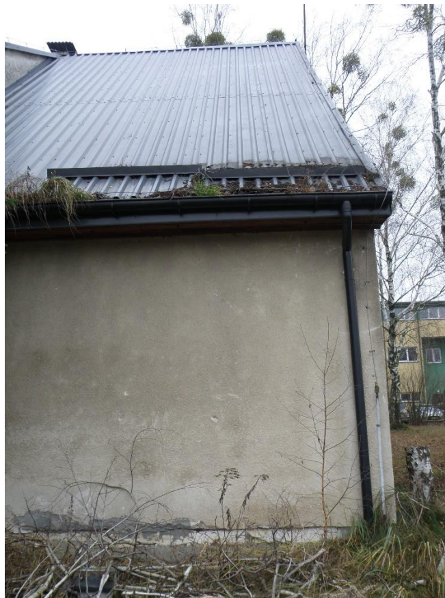
fot.4 Widok elewacji tylnej - widoczne uszkodzenia i naprawy tynków w strefie przycokołowej.
