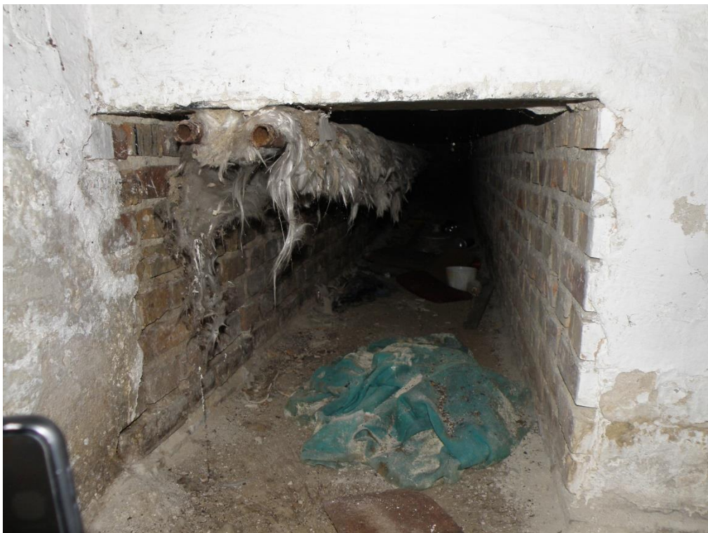
fot.21 Widoczna degradacja i korozja instalacji centralnego ogrzewania w obrębie kanału technicznego.
