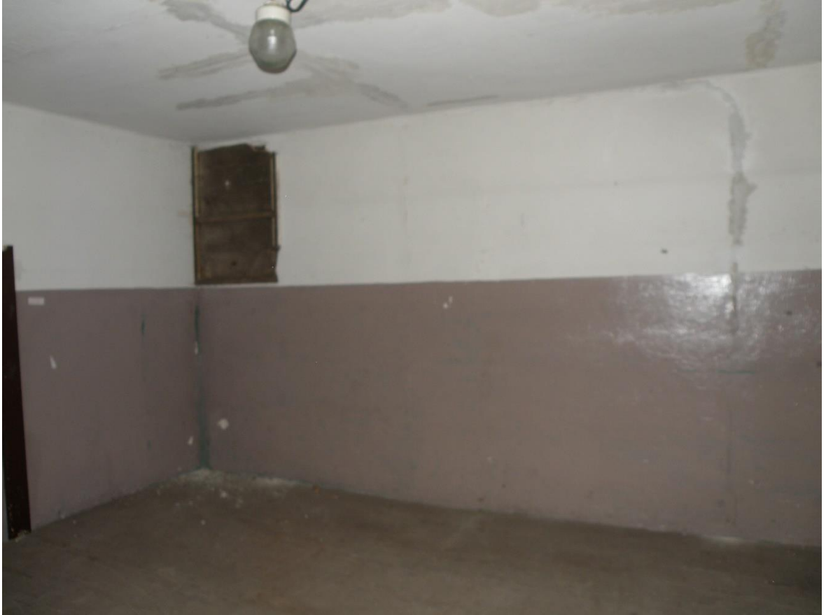
fot.9 Widoczne uszkodzenia i naprawy wypraw wewnętrznych.
