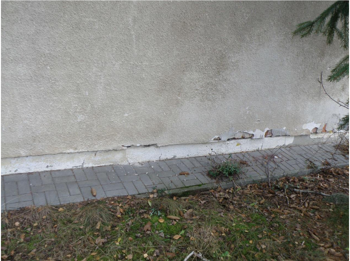
fot.5 Uszkodzenia strefy przycokołowej
