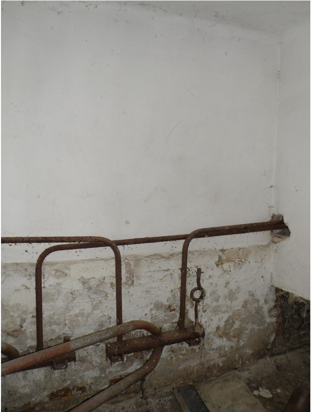
fot.20 Widoczna korozja elementów instalacji centralnego ogrzewania
