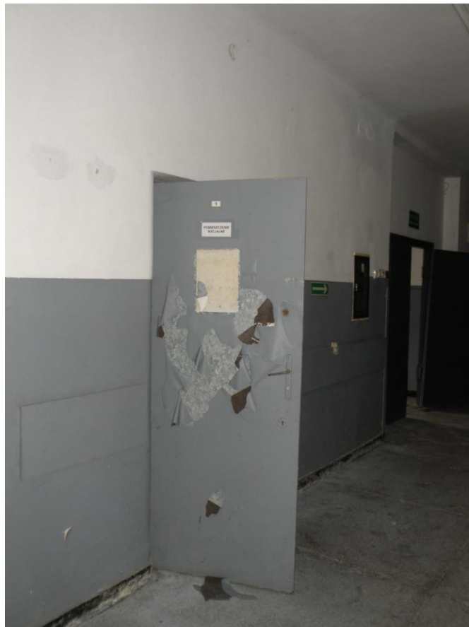
fot.24 Uszkodzenia stolarki drzwiowej wewnętrznej
