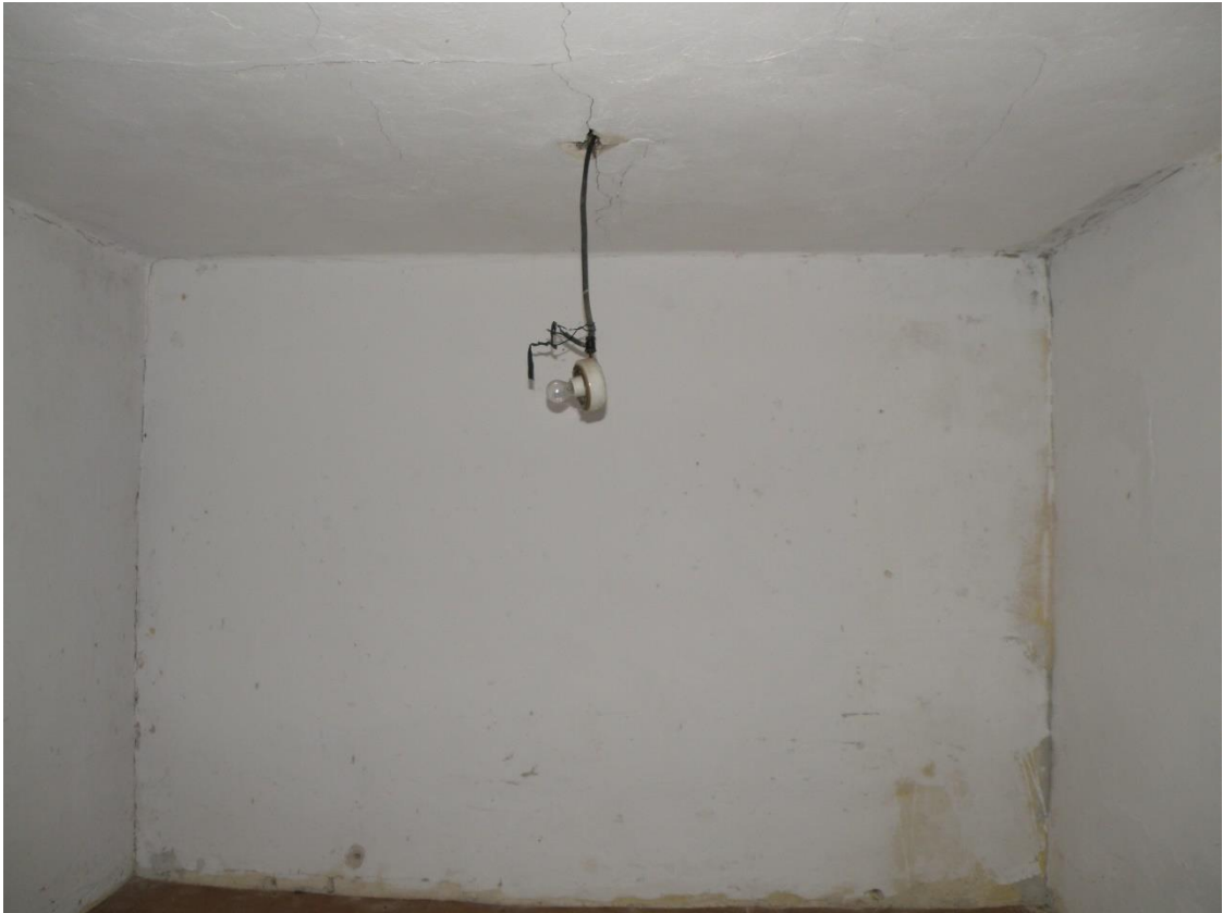
fot.11 Widok degradacji instalacji elektrycznej. Na ścianach widoczne przebarwienia i uszkodzenia ścian wewnętrznych działowych poddasza.
