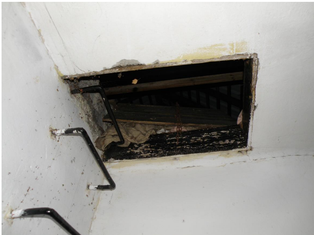
fot.12 Widoczna degradacja wyłazu dachowego.
