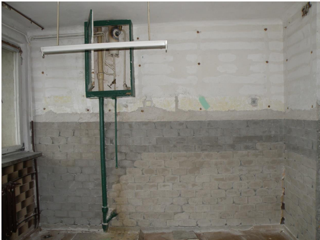
fot.8 Widoczny brak wypraw wewnętrznych (tynków) oraz uszkodzenia żeliwnej instalacji kanalizacji sanitarnej.
