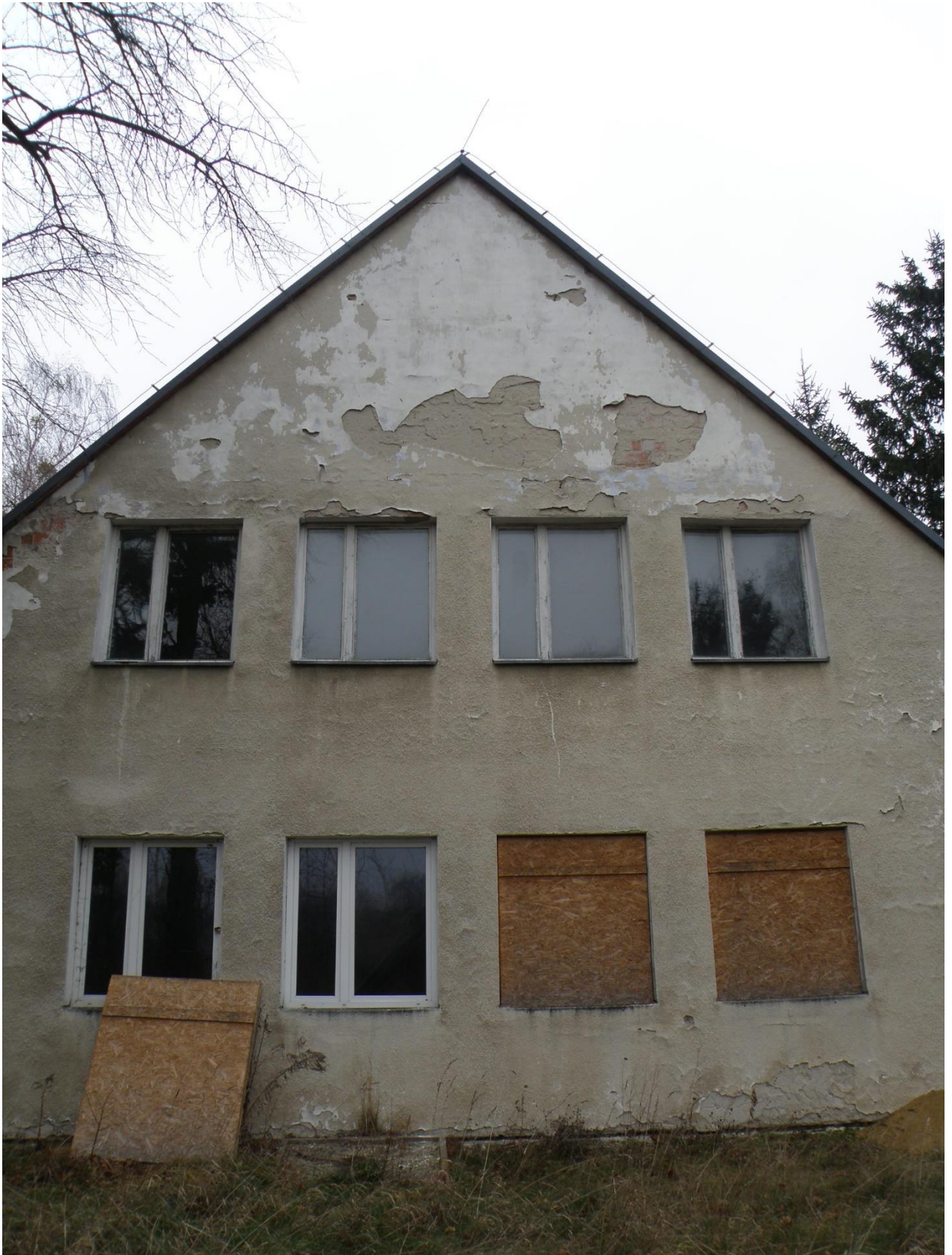
fot.1 Widok elewacji szczytowej – widoczne uszkodzenia tynków zewnętrznych.
