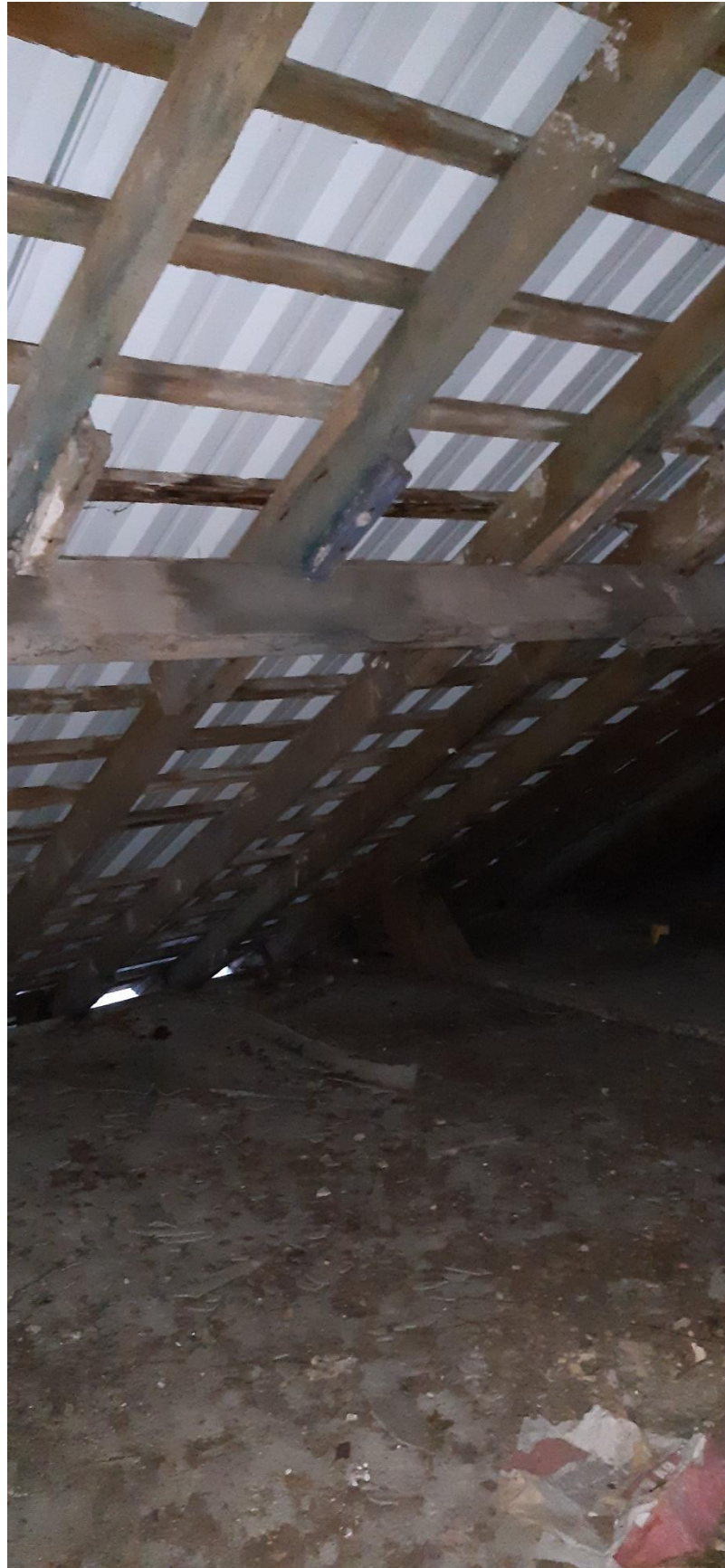
fot.26 Widok więźby dachowej z prowizorycznym wzmocnieniem elementów konstrukcyjnych.
