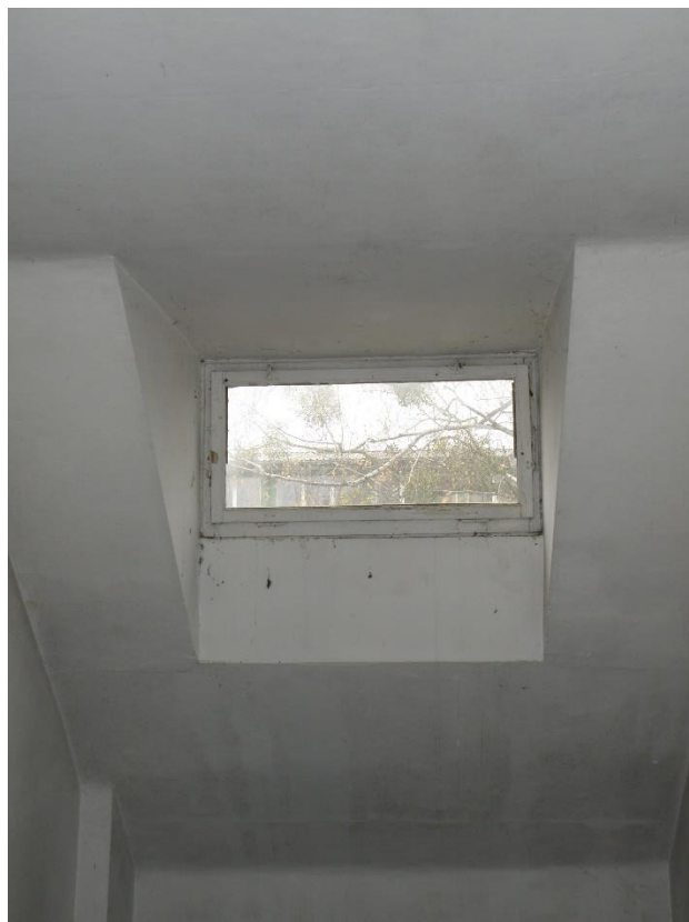
fot.6 Stolarka okienna klatki schodowej – widoczne również ślady przemarzania budynku
