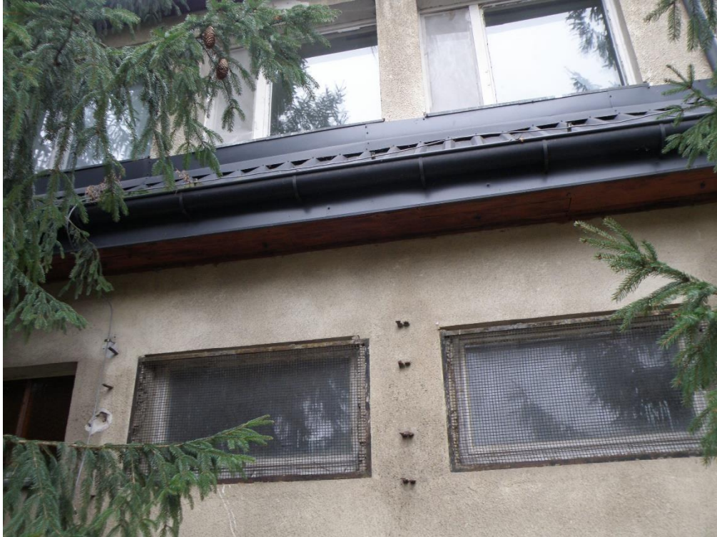
fot.3 Widok elewacji szczytowej – widoczny brak zwodów instalacji odgromowej. Stolarka okienna drewniana do wymiany.
