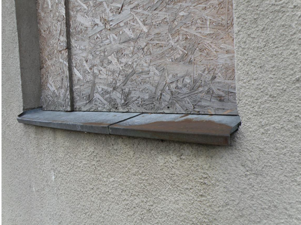
fot.15 Widoczna korozja parapetów zewnętrznych
