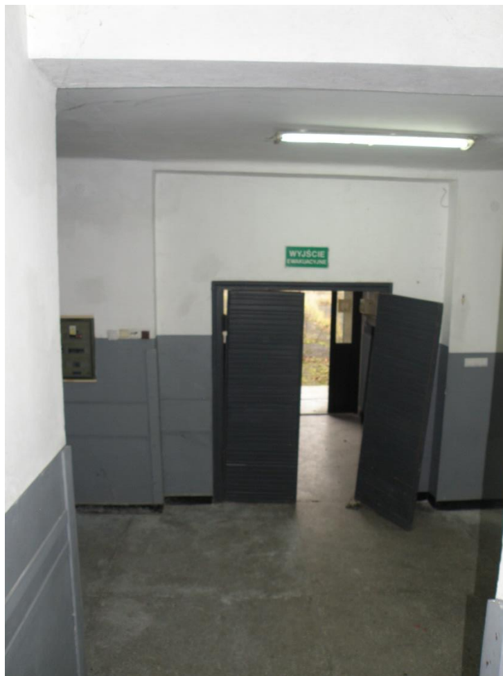
fot.14 Uszkodzenia drewnianej stolarki strefy wejścia głównego.
