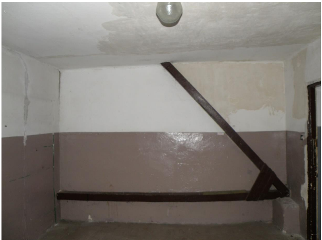
fot.10 Widoczne naprawy rys w ścianach działowych poddasza oraz uszkodzenia wypraw wewnętrznych
