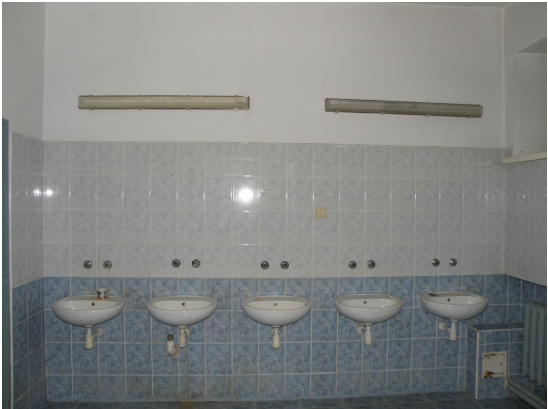
fot. 19 Widoczne braki armatury instalacji wodociągowej.
