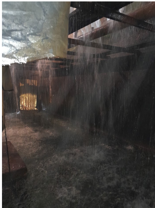
RYСУNEK 17 PRACUJĄCĘ ZŁOŻĘ FILTRACYJNE W STACJI SUW W PARKU MIEJSKIM W JAWORZE
