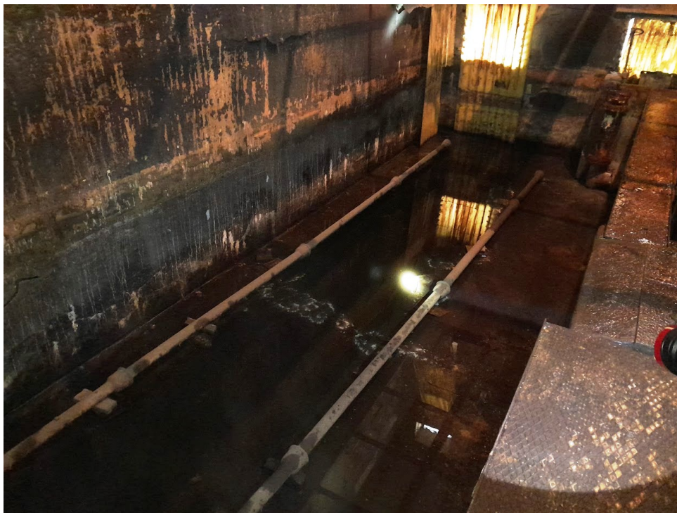
RYSUNEK 18 NIEUŻYTKOWANA KOMORA FILTARCYJNA W STACJI SUW W PARKU MIEJSKIM W JAWORZE
