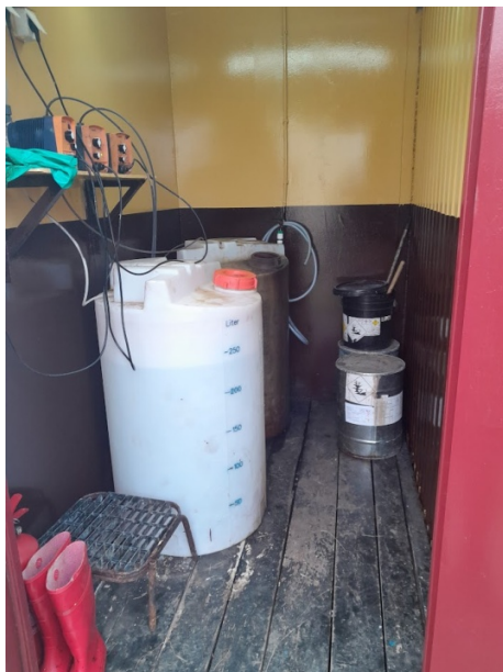
RYSUNEK 15 POMIESZCZENIE Z E ZBIORNIKAMI NADMANGANIANEM POTASU ORAZ PODCHLORYNEM SODU
