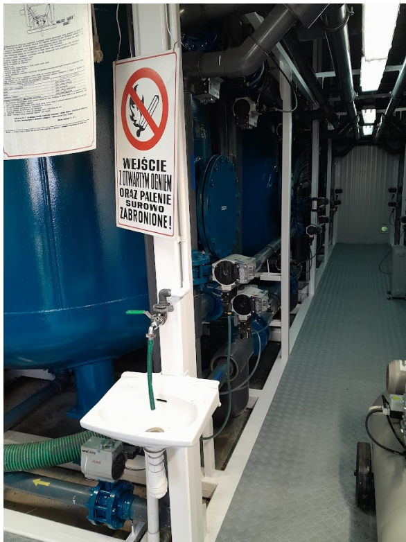
RYSUNEK 13 WNĘTRZE BUDYNKU STACJI UZDATNIANIA NR 1
