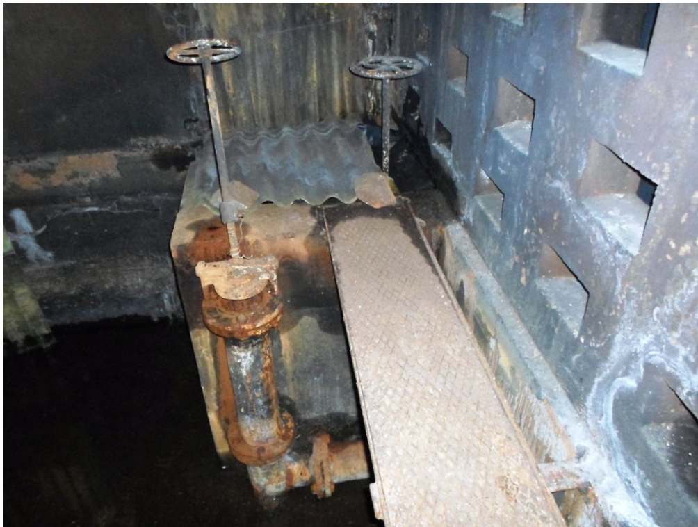
RYSUNEK 21 KOMORA FILTRACYJNA – WIDOK STUDZIENKI ZBIORCZEJ WODY Z ARMATURĄ
