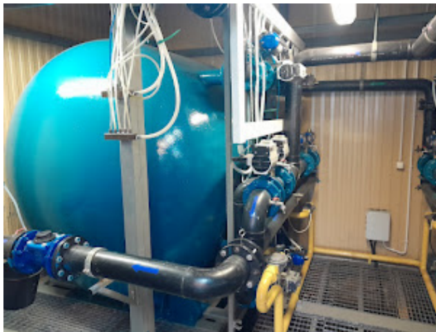
RYSUNEK 14 WNĘTRZE BUDYNKU STACJI UZDATNIANIA NR 2
