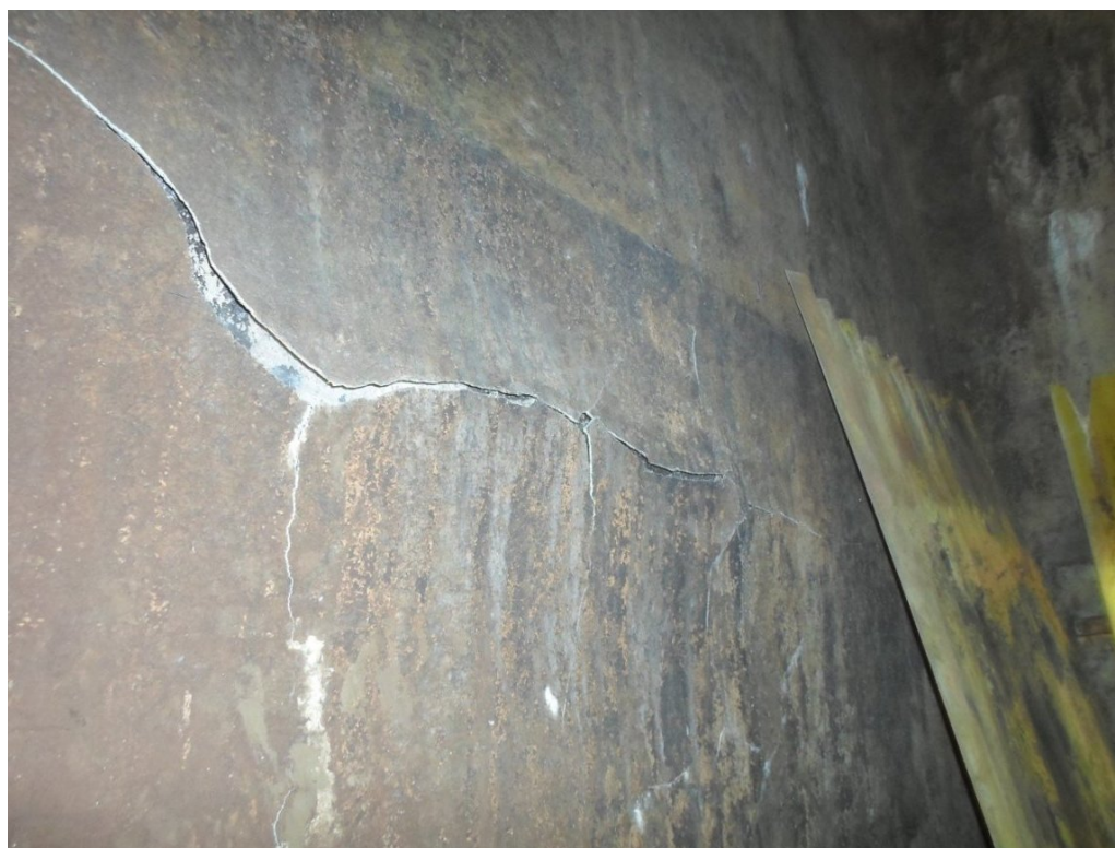
RYSUNEK 23 STAN ŚCIAN KOMORY NAPOWIETRZANIA
