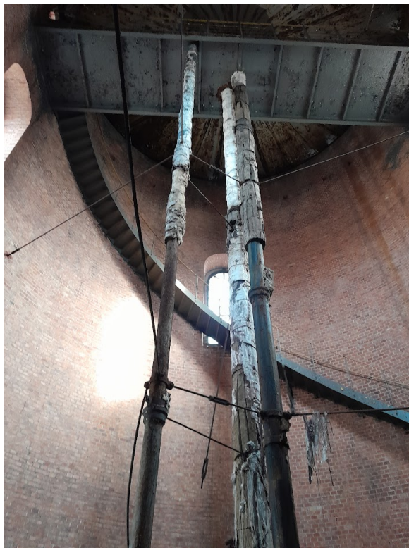
RYСУNEK 26 RUCIĄGI ZASILAJĄCE ZBIORNIK W WIEŻY CIŚNIEŃ
