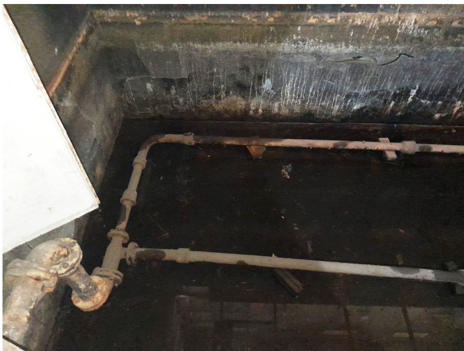
RYSUNEK 19 NIEUŻYTKOWANA KOMORA FILTARCYJNA W STACJI SUW W PARKU MIEJSKIM W JAWORZE
