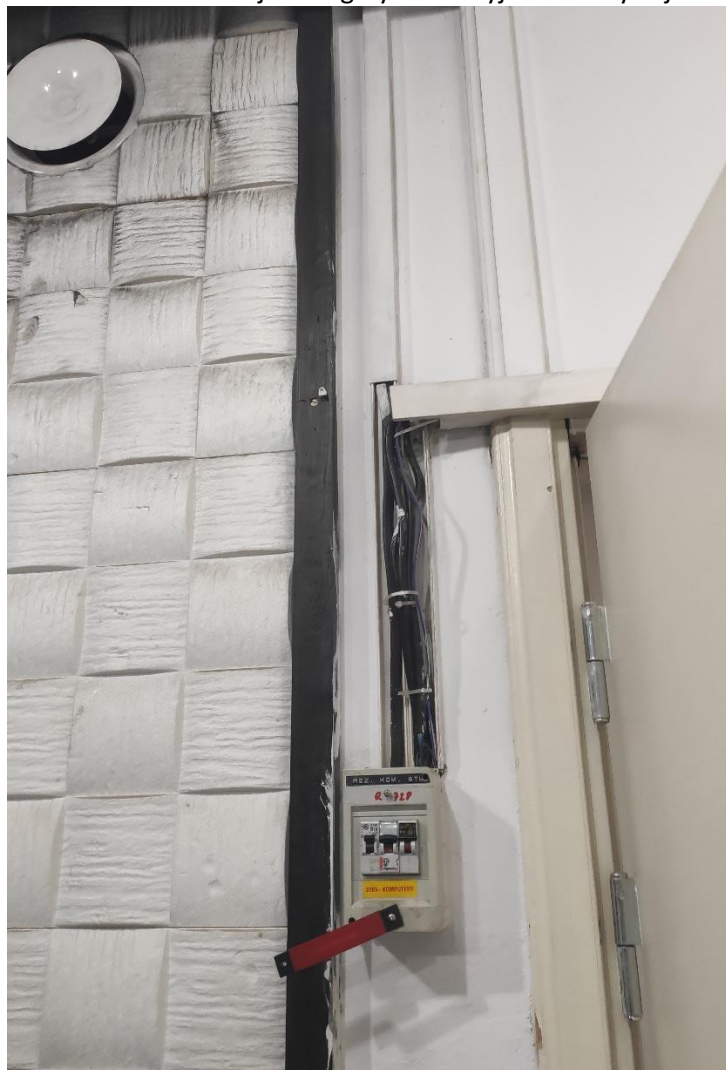
Aktualna instalacja energetyczna i wyjście wentylacji.
