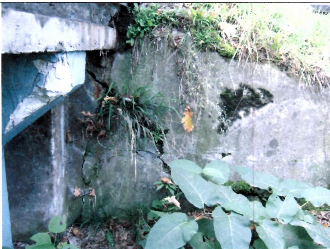
Fot. 10 Widoczne pęknięcie i odspojenie skrzydełka od przyczółka.
