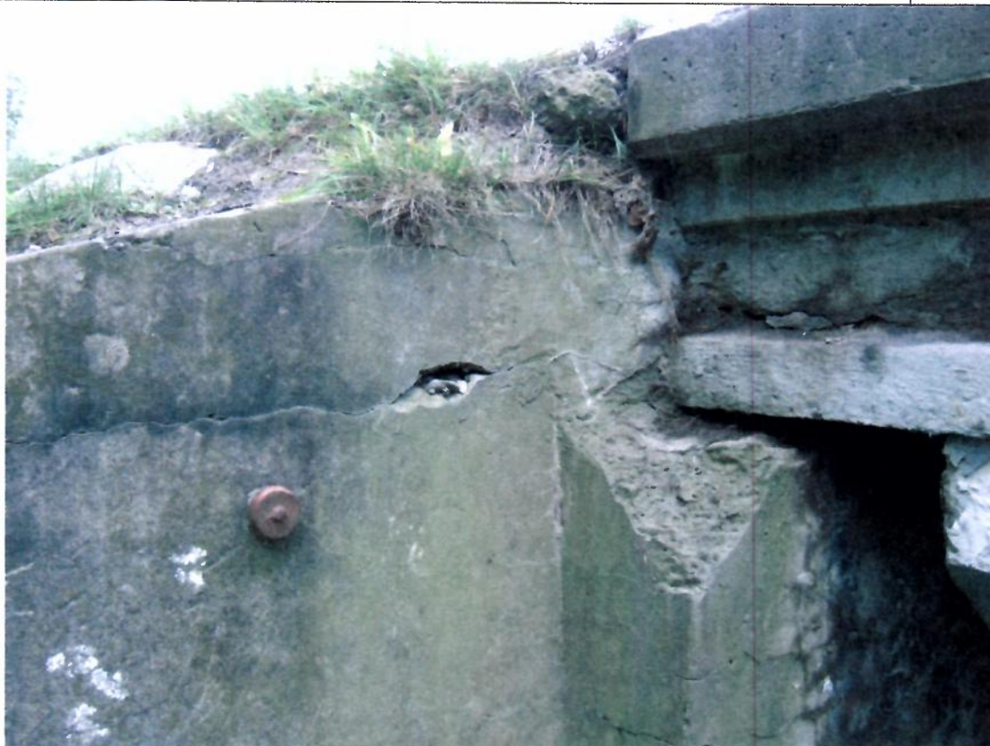
Fot. 9. Pęknięcia i ubytki betonu na skrzydełkach .
