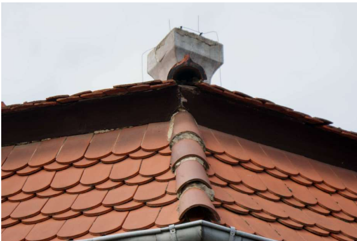
Fot.6. Nieszczelności w pokryciu dachowym.
