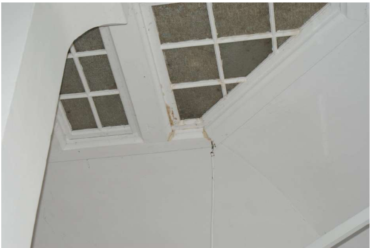
Fot.2. Lekkie zawilgocenie ramy okiennej naświetla.
