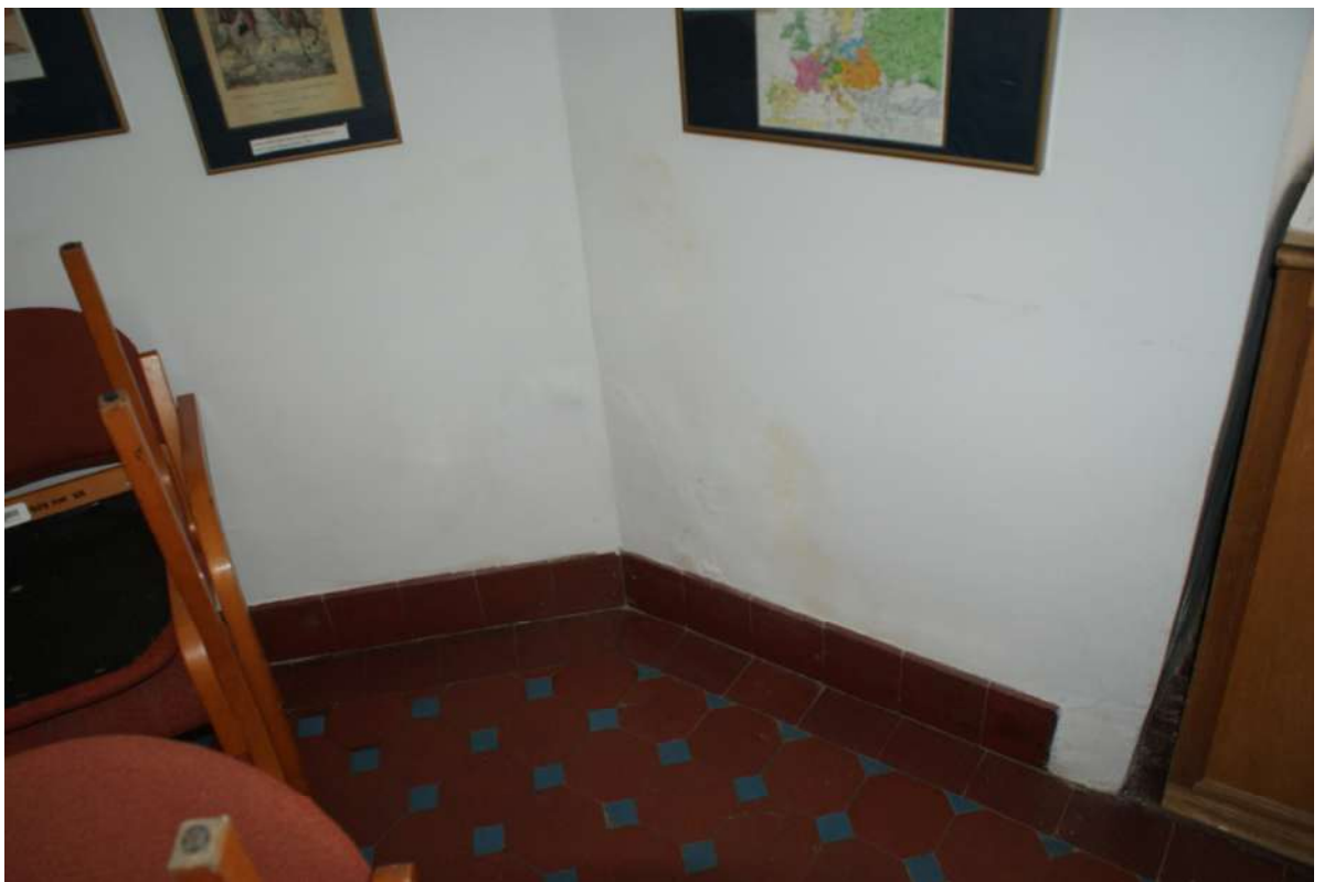
Fot.4. Lekkie zawilgocenie i zagrzybienie ściany na prawo od wejścia.
