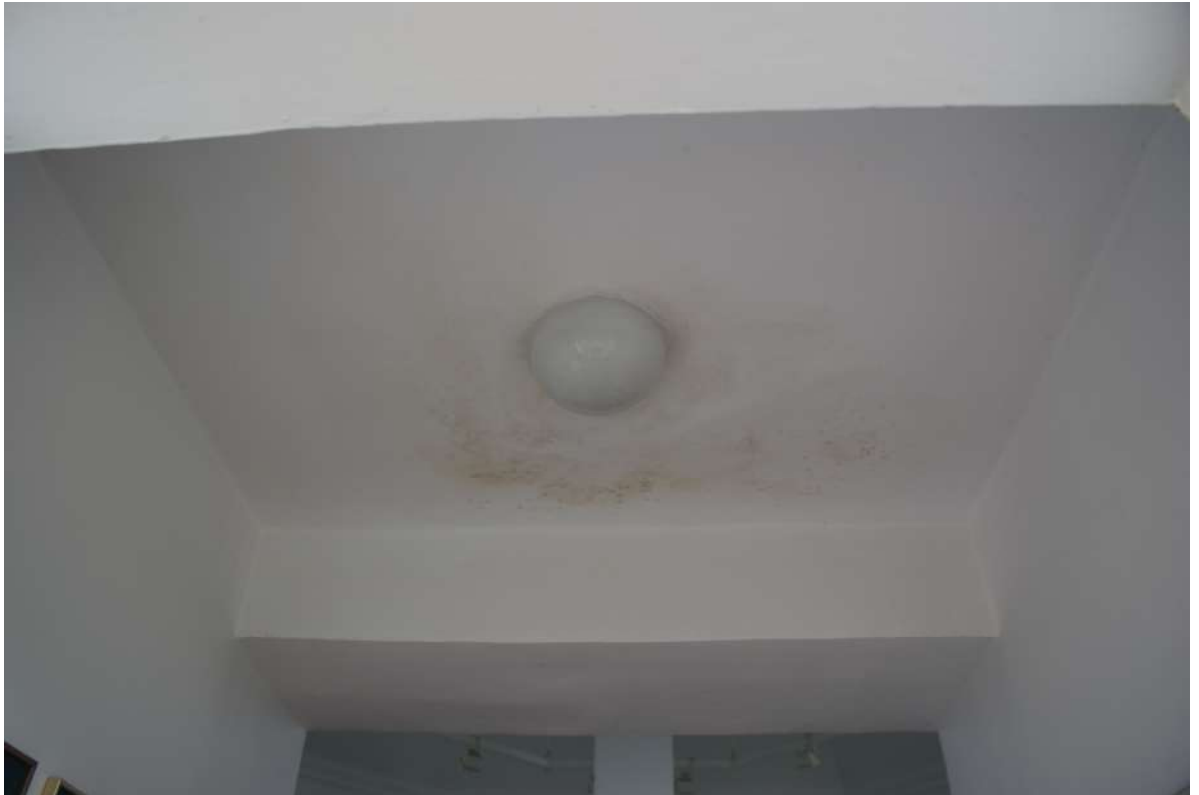
Fot.3. Zawilgocenie sufitu w przedsionku.
