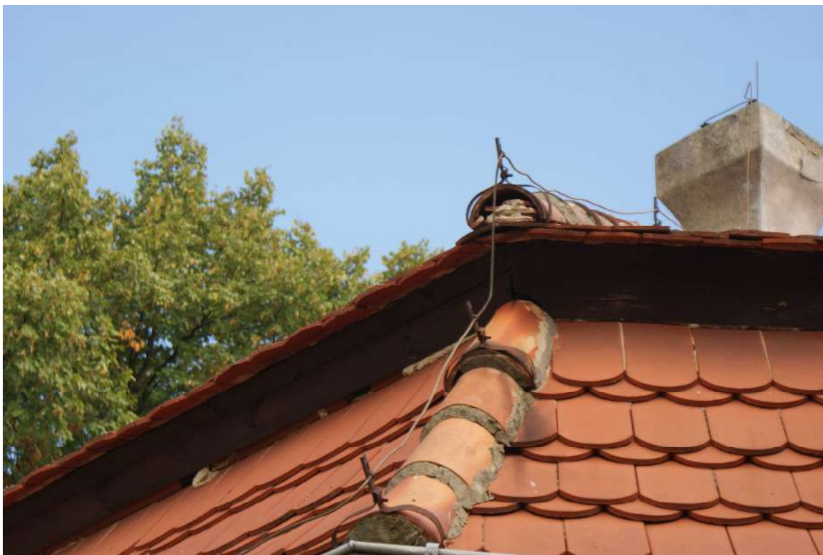
Fot.5. Nieszczelności w pokryciu dachowym.
