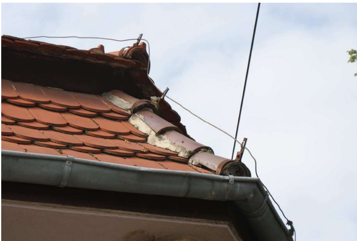
Fot.8. Nieszczelności w pokryciu dachowym.
