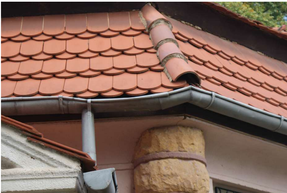
Fot.7. Nieszczelności w pokryciu dachowym. Uszkodzona rynna.
