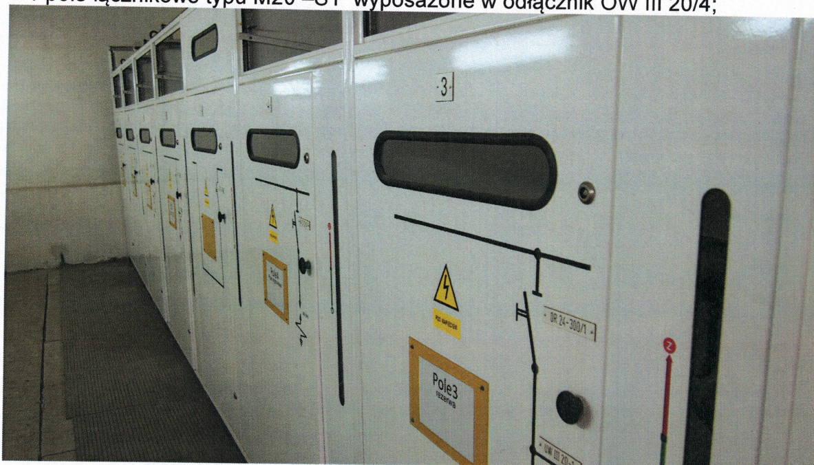
Rys. nr 1 – Rozdzielnica SN.
