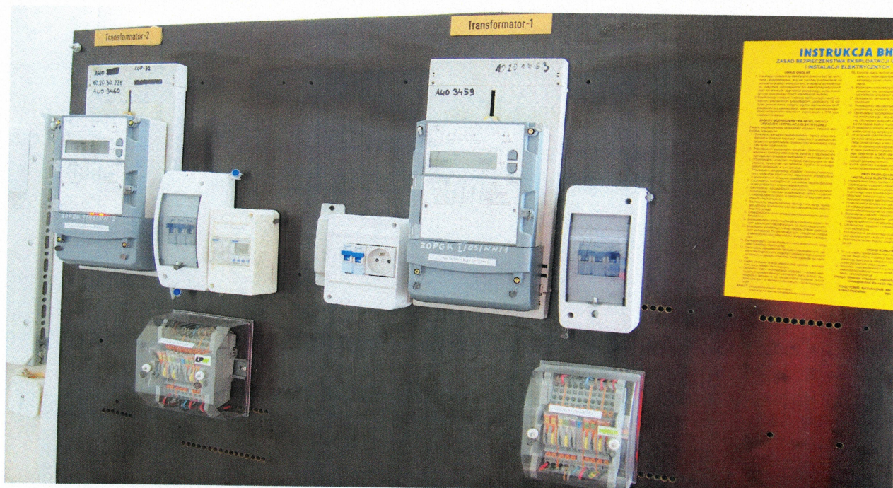
Rys. nr 4 – Widok istniejących układów pomiarowych po stronie nN.
