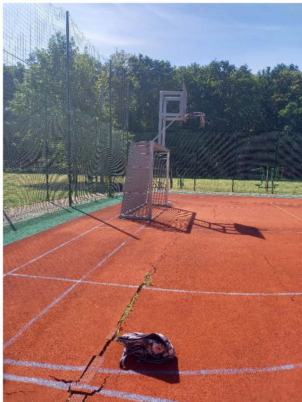
Ryc. 3 Widok na boisko – zniszczona nawierzchnia Źródło: archiwum własne z dn. 28.07.2022 r.
