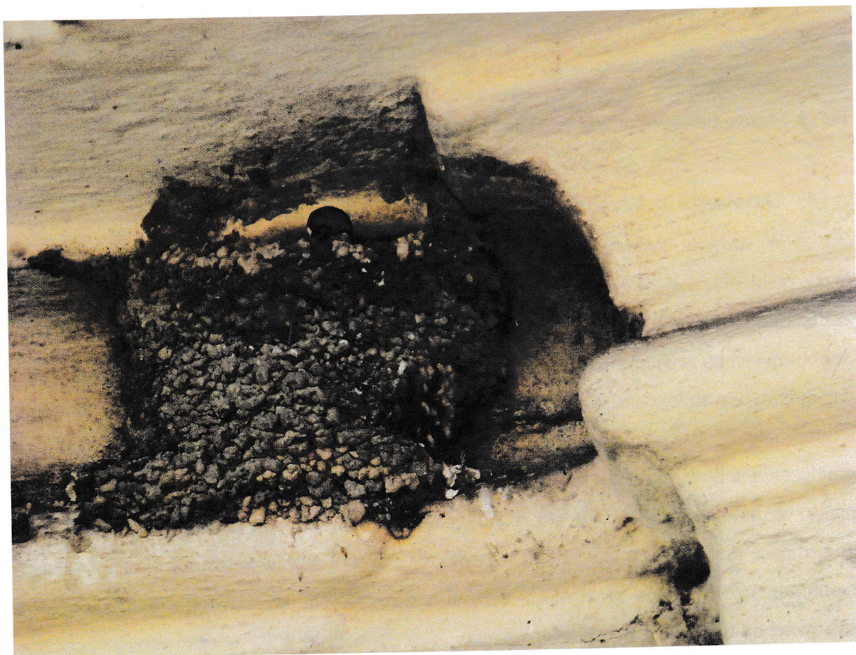
Fot. 1. Zajęte gniazdo jaskółki oknówki na gzymsie pod dachem na elewacji frontowej.
