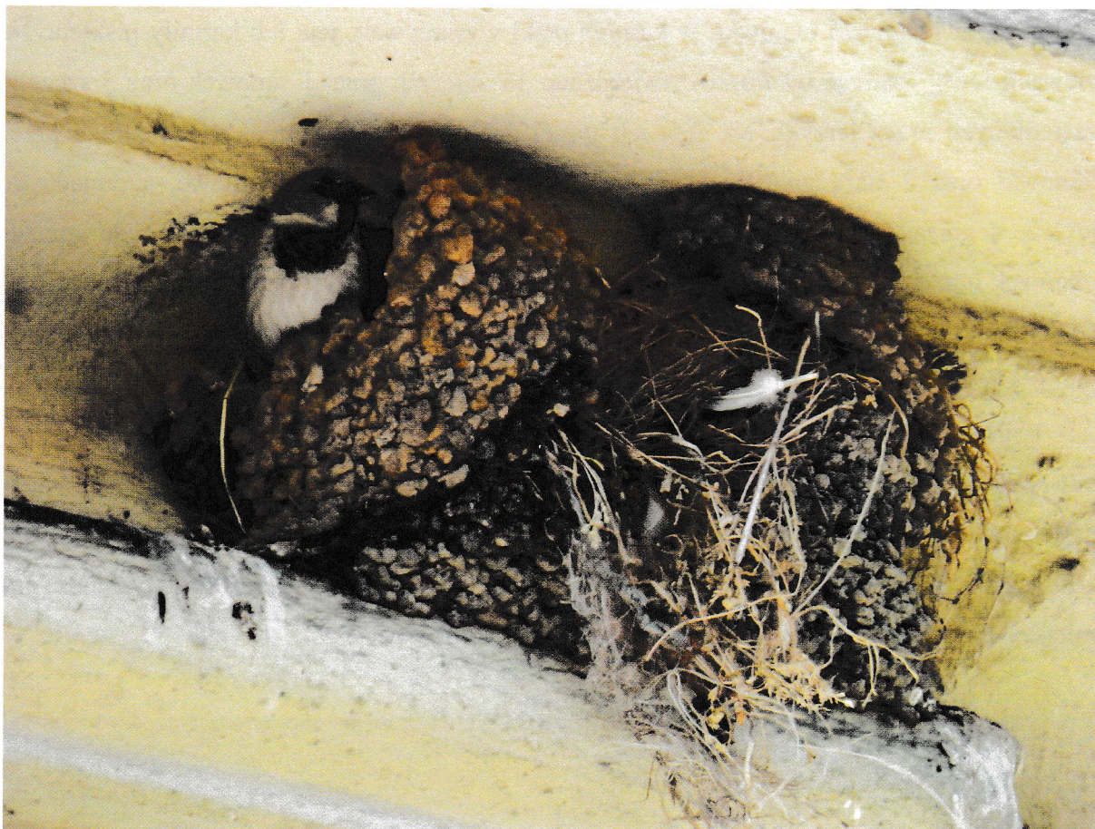
Fot. 2. Stare gniazdo oknówek zasiedlone przez parę wróbli na elewacji tylnej.
