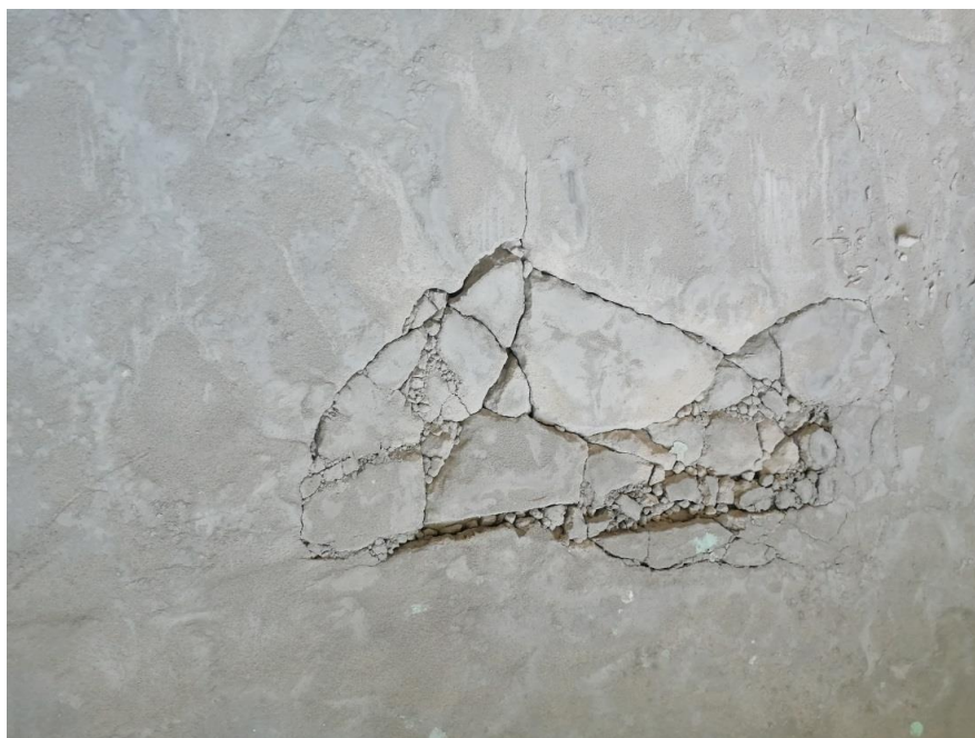
Fot. 11 Miejscowo wykruszony podkład w bibliotece
