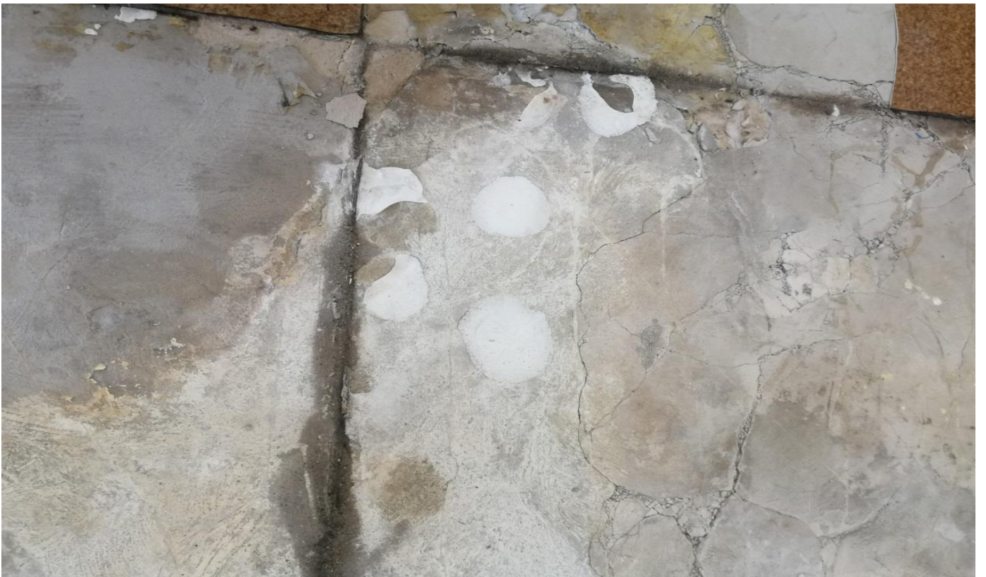
Fot. 6. Wykruszony podkład w pomieszczeniu czytelnicy
