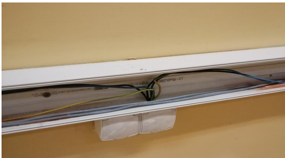
Fot. 8 Korytka kablowe
