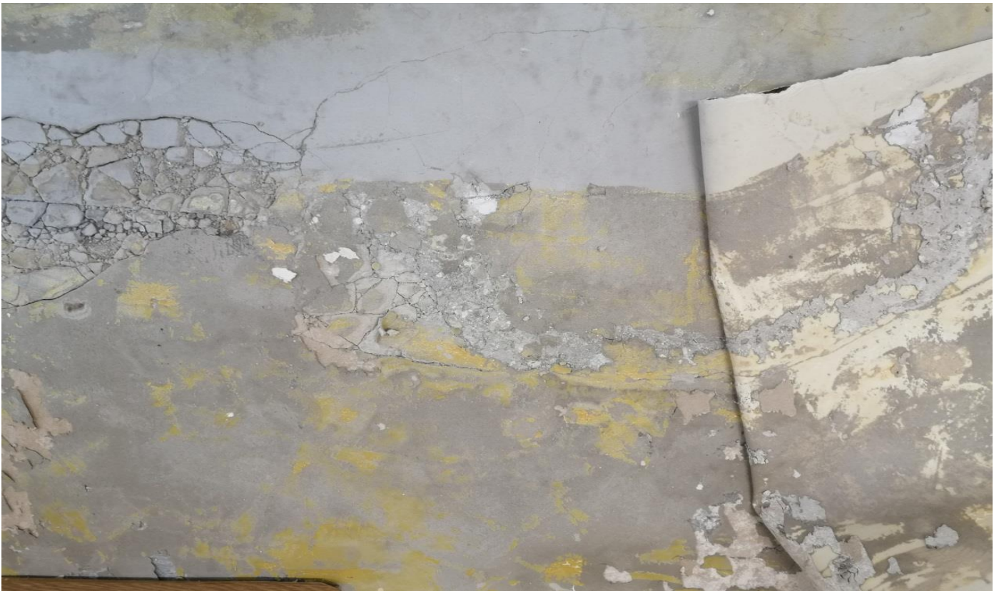
Fot.5. Wykruszony podkład w pomieszczeniu czytelnicy
