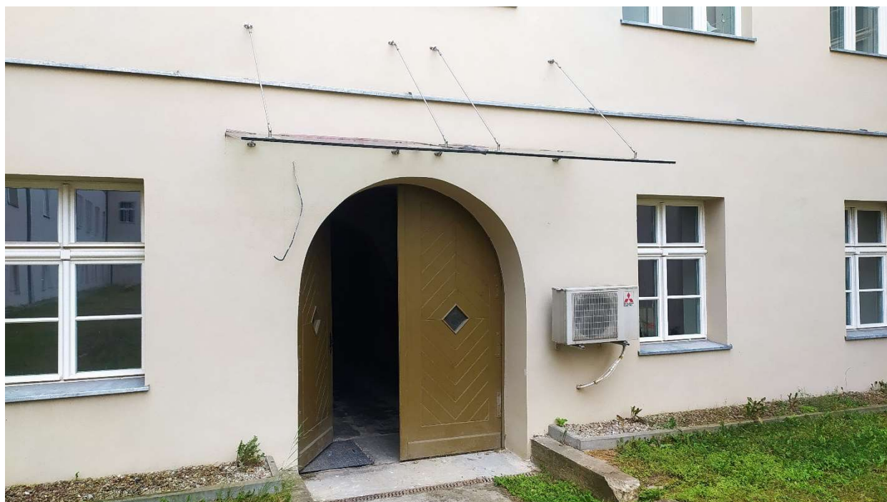
Fot. nr 3: Działanie nr 1 - Elewacja „C” – zadanie do demontażu na czas robót
