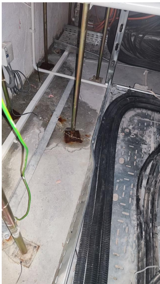
Korytarz przy Serwerowni Chmura
