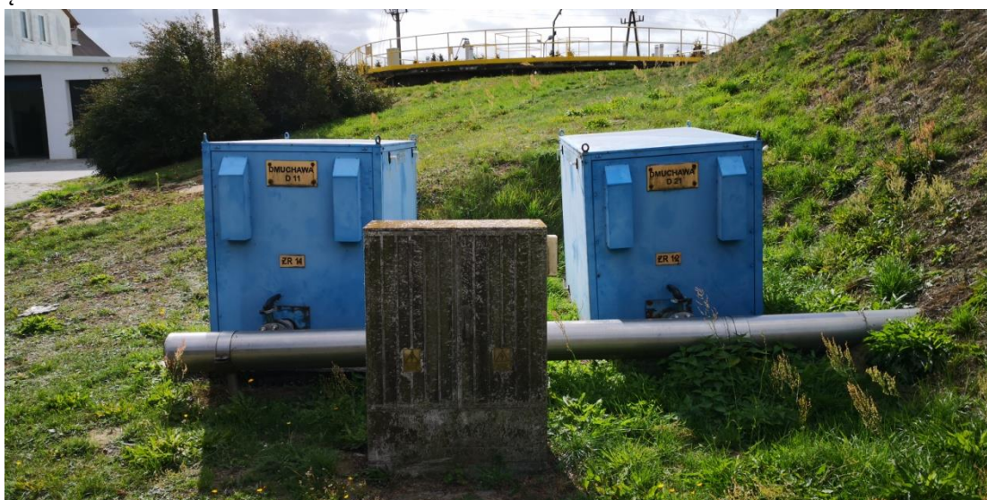
Fot. 14 Stacja dmuchaw
