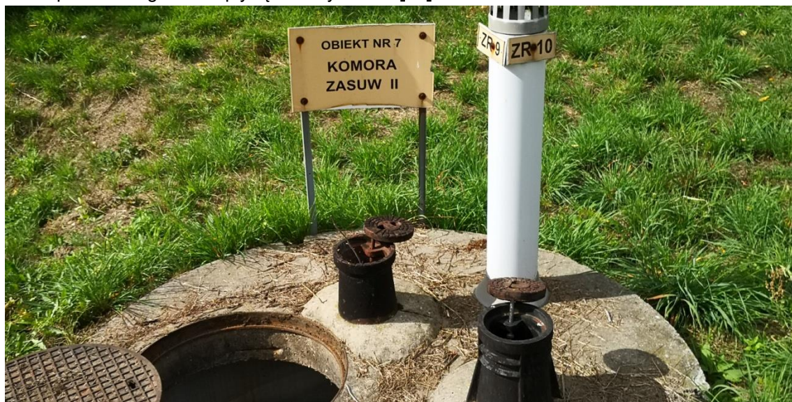
Fot. 12 Komora zasuw
