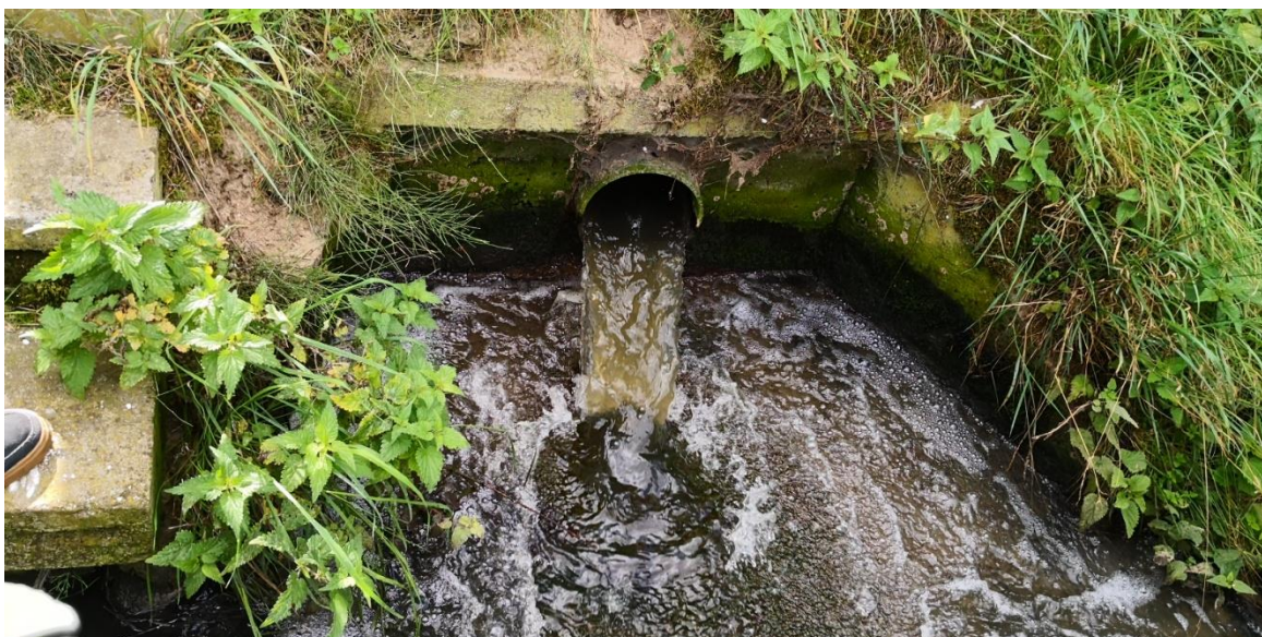
Fot. 13 Wylot do odbiornika
