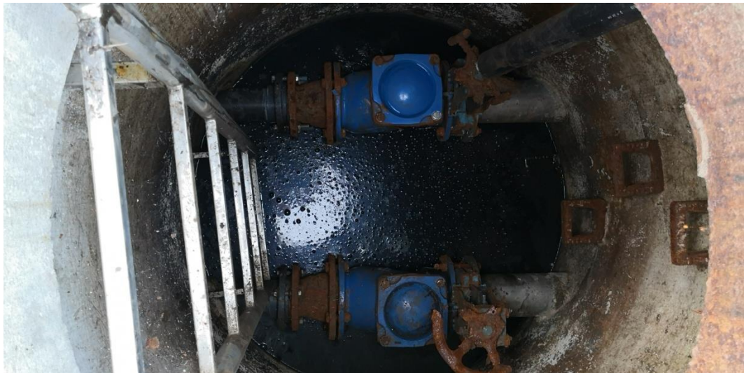
Fot. 3 Komora zasuw
