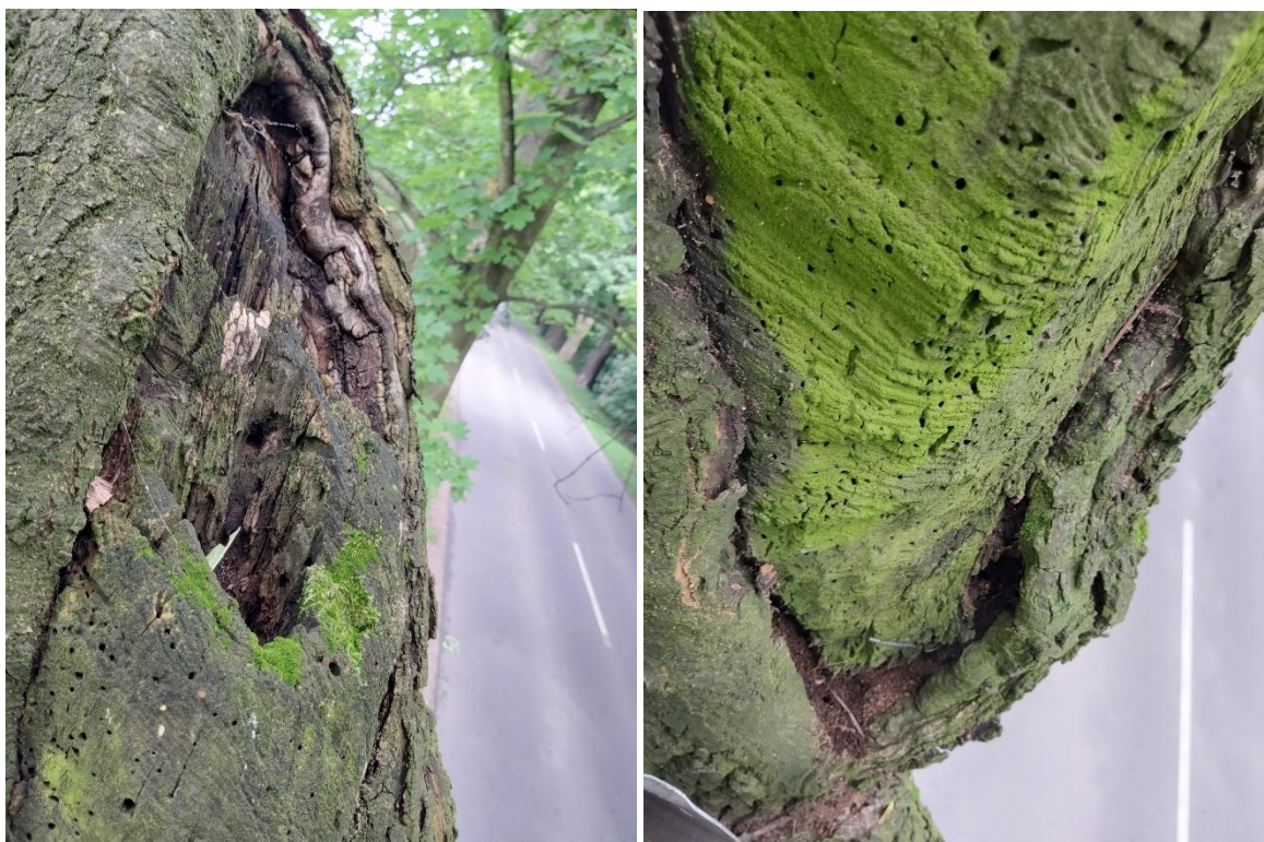
Fot. 277, 278 Jesion nr 51- inspekcja w koronie wykazała, że ścianki ubytku są twarde, bez oznak świeżego rozkładu
