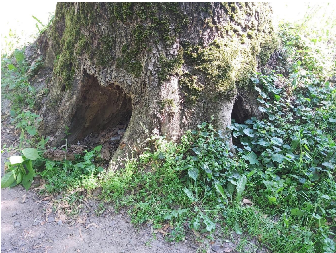
Fot. 196 Jesion nr 35– nasada pnia -widok od strony południowej -widoczne zaawansowane wypróchnienie
