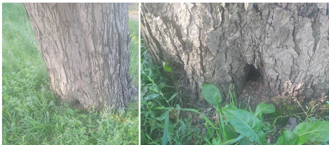
Fot. 334, 335 Klon srebrzysty nr 59 – Od strony wschodniej między nabiegami ubytek wgłębny - sondowanie wykazało, że ścianki ubytku są twarde bez postępującego rozkładu
