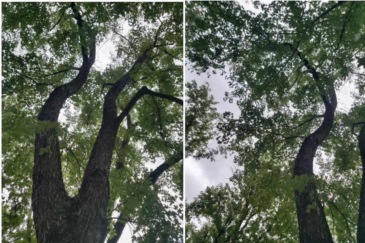
Fot. 356, 357 Klon srebrzysty nr 63 – rozgałęzienie na 2 główne konary konstrukcyjne na wysokości ok. 5m U-kształtne bez zakorka; konary posiadają nieco zdeformowaną konstrukcję, co czyni je bardziej podatnymi na złamania (skręcające) podczas uderzeń wiatrów
