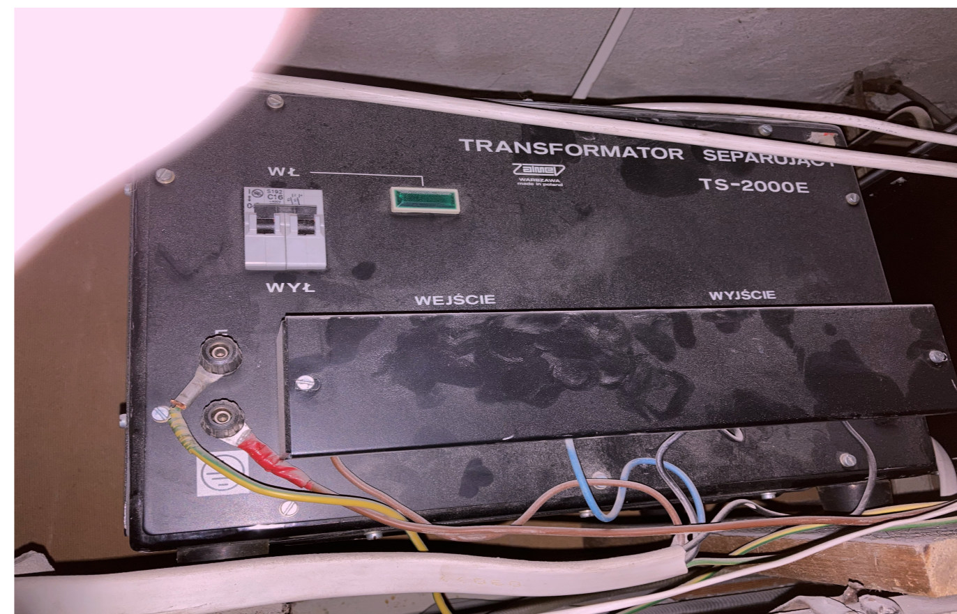
WIDOK FRONTU TRANSFORMATORA IZOLACYJNEGO
