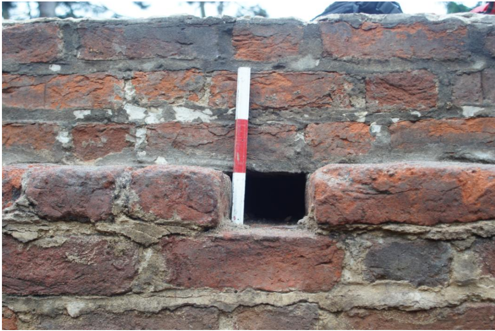
Il.18. Mur B. Strona S. widoczny otwór odprowadzający wodę. Fot. P. Alagierski.
