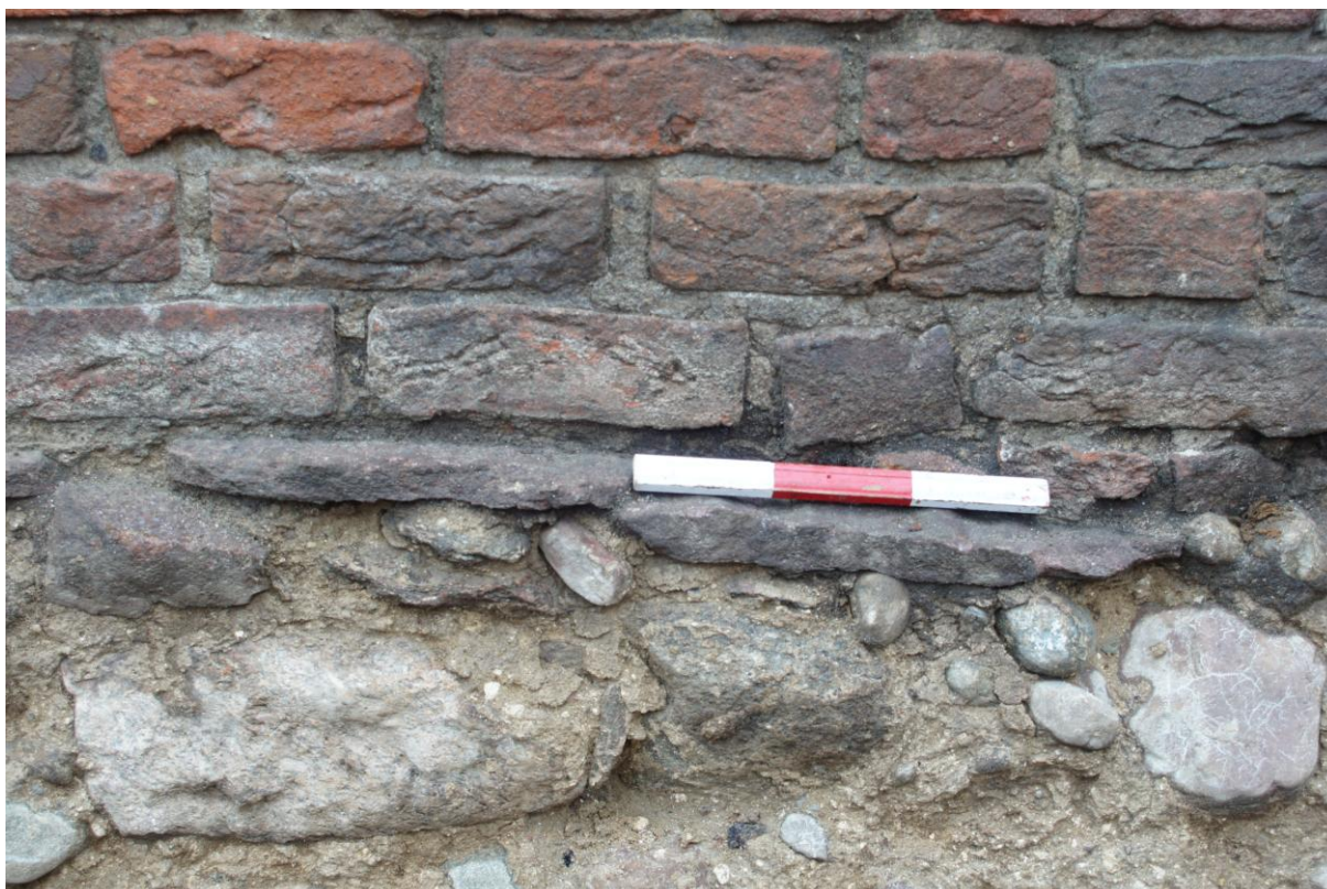
Il. 14. Fundament XIII w. muru A wraz z widoczną rolką wyrównującą wyprowadzoną poprzez użycie płyt piaskowców jotnickich. Fot. P. Alagierski.
