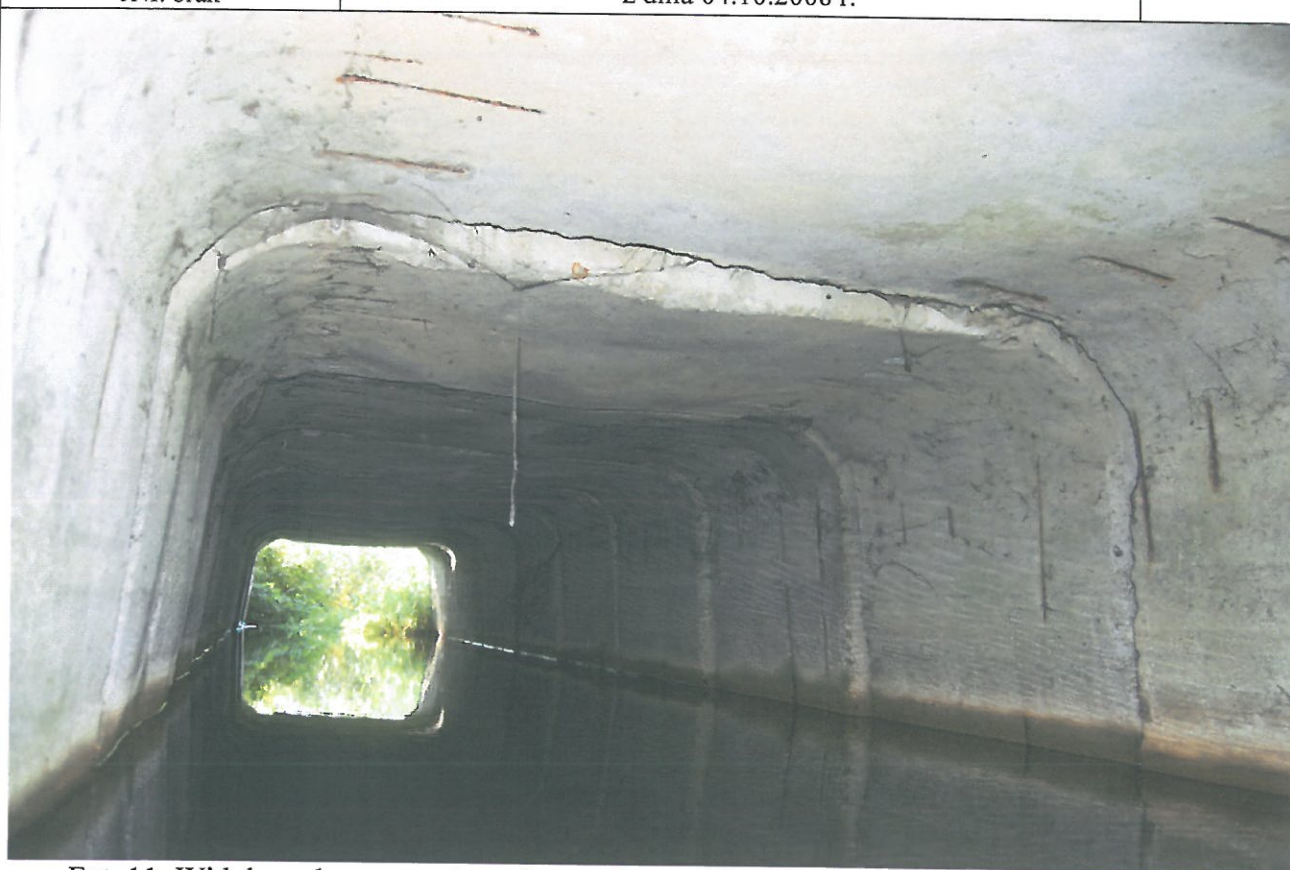
Fot. 11. Widok oczka przepustu z elementów prefabrykowanych, ubytki otuliny, widoczne skorodowane zbrojenie, niesprawną izolacją
