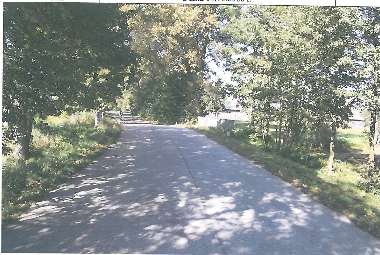
Fot. 5. Widok nawierzchni na przepuście i dojazdach, zanieczyszczenia i wegetacja roślin wzdłuż poręczy i w rejonie przepustu
