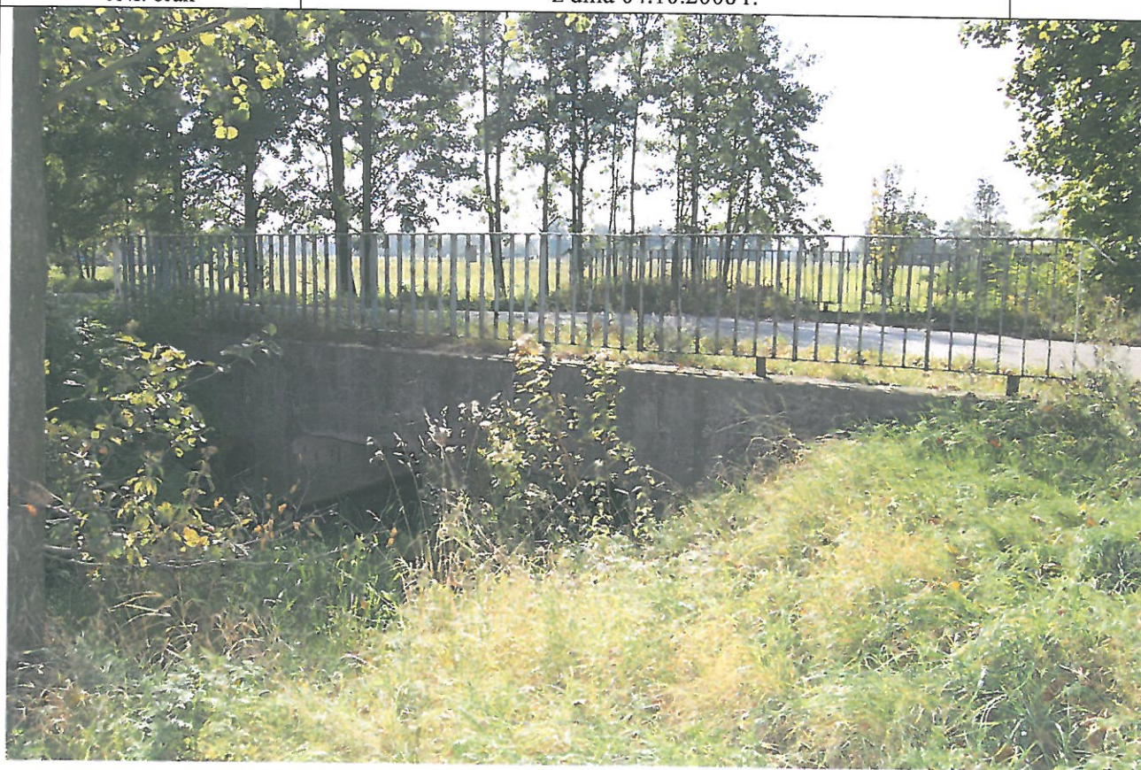
Fot. 7. Wegetacja roślin w rejonie przepustu utrzymująca wilgoć na konstrukcji
