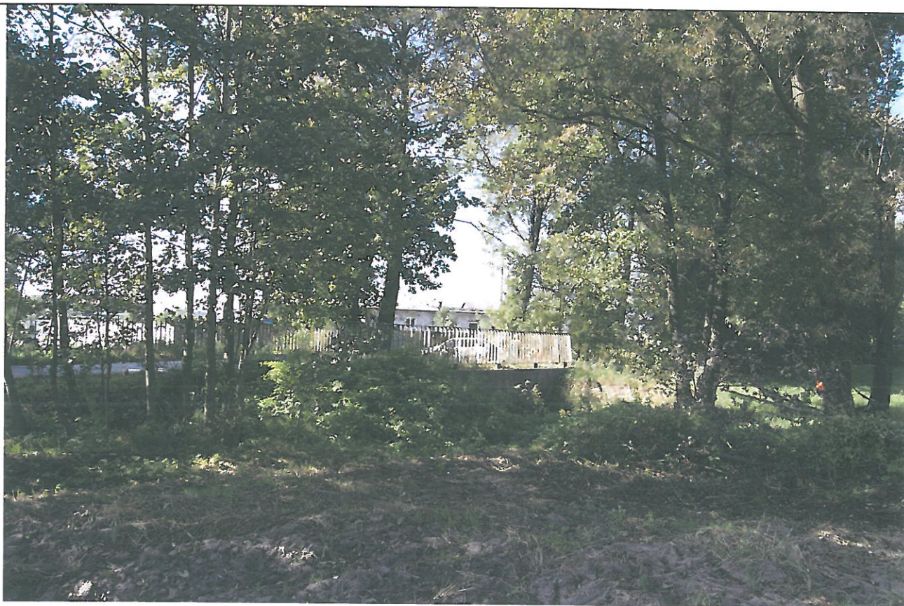
Fot. 16. Bujna roślinność w rejonie przepustu utrzymująca wilgoć na konstrukcji obiektu
