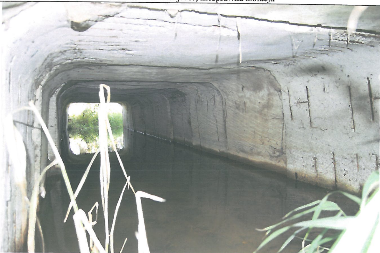
Fot. 12. Widok oczka przepustu z elementów prefabrykowanych, ubytki otuliny, widoczne skorodowane zbrojenie
