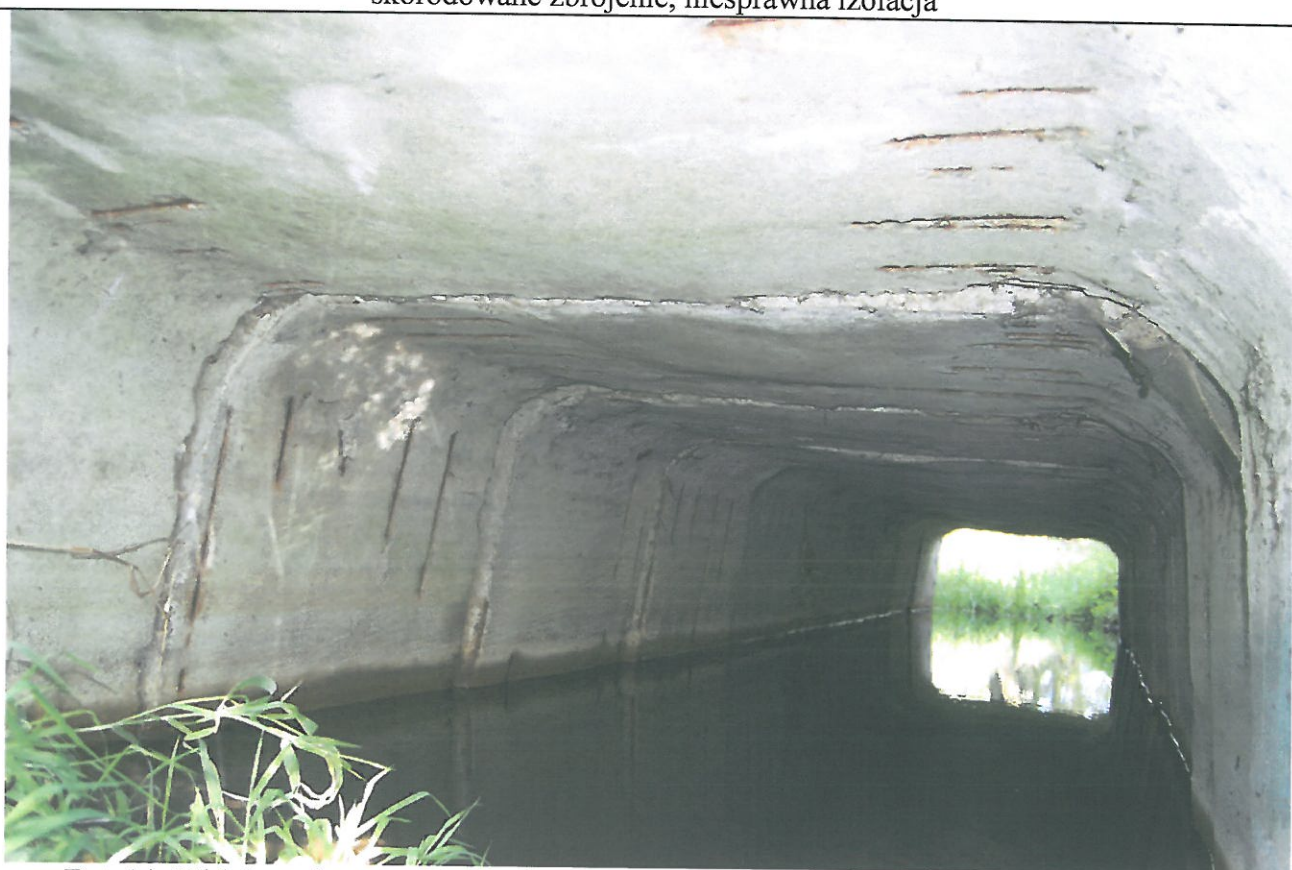
Fot. 14. Widok oczka przepustu z elementów prefabrykowanych, ubytki otuliny, widoczne skorodowane zbrojenie, niesprawna izolacja
