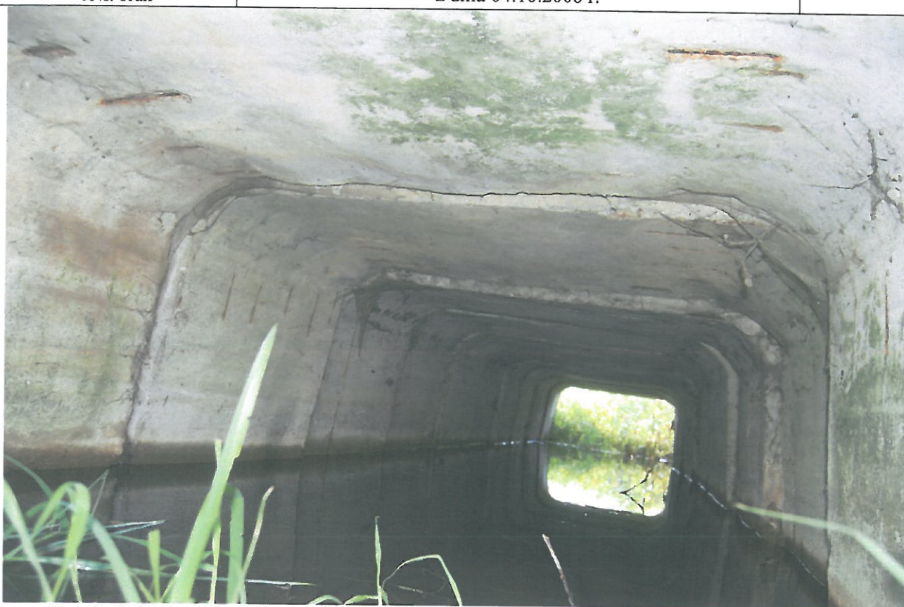
Fot. 9. Widok oczka przepustu z elementów prefabrykowanych, ubytki otuliny, widoczne skorodowane zbrojenie, niesprawną izolacją
