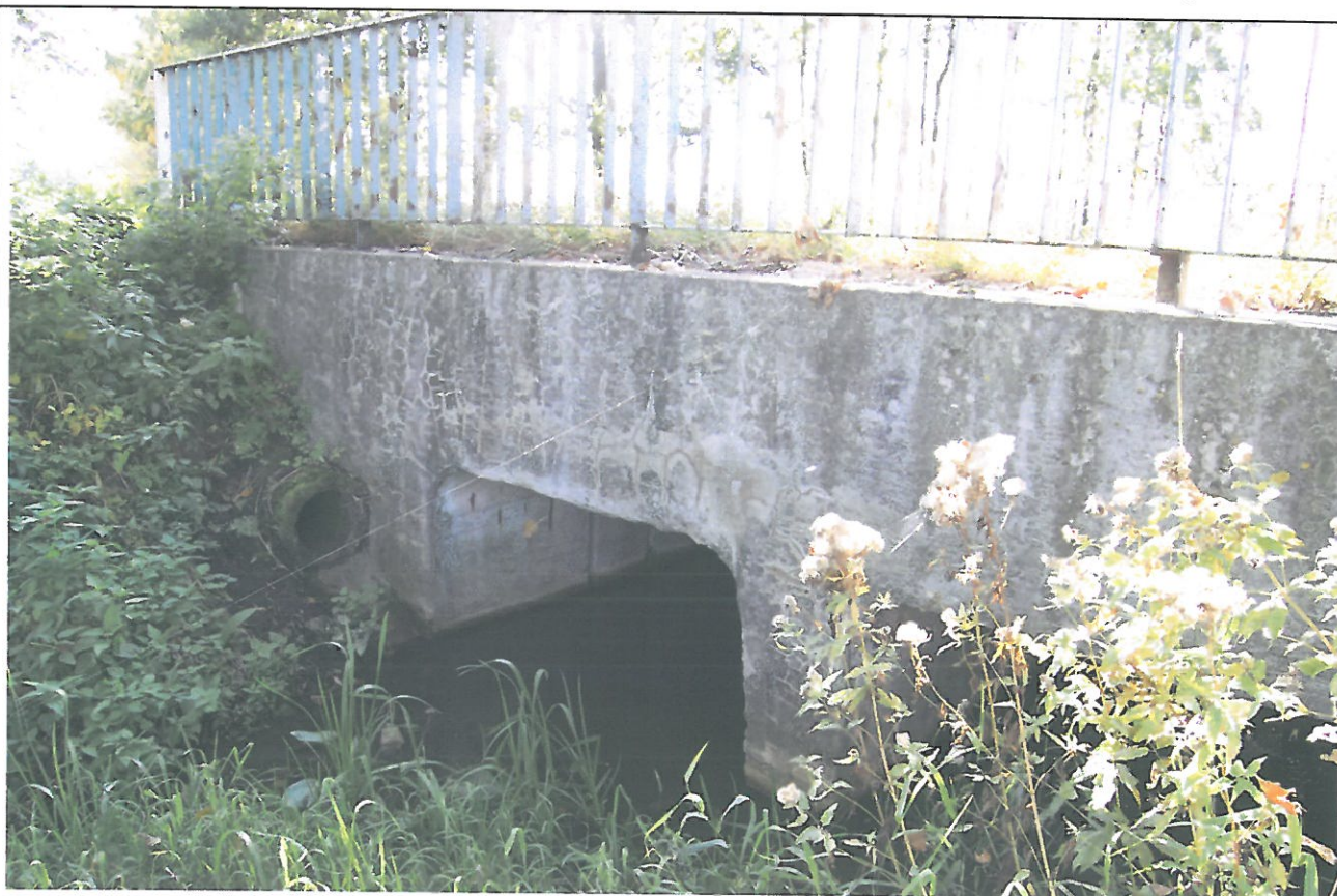
Fot. 8. Widok ścianki czołowej korozja poręczy
