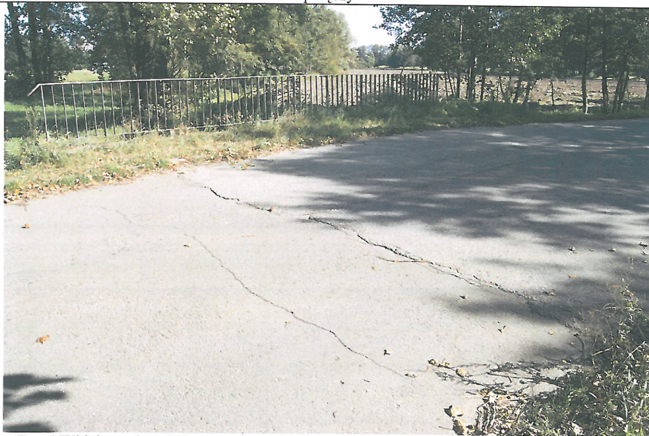
Fot. 4 Widok nawierzchni na przepuście i dojazdach – spękania poprzeczne, zanieczyszczenia i wegetacja roślin wzdłuż poręczy
