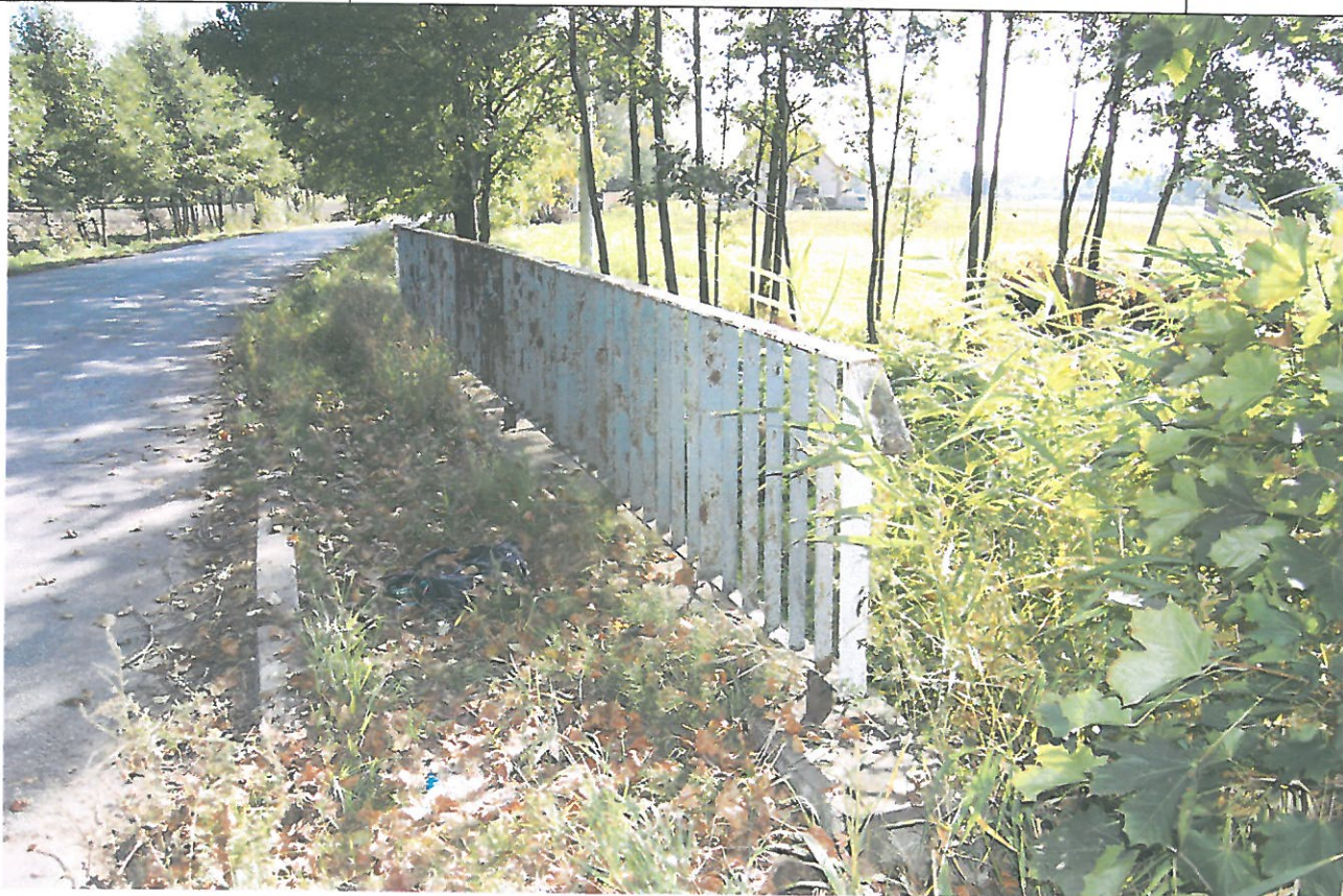
Fot. 15. Zanieczyszczenia i wegetacja roślin wzdłuż poręczy i rejonie obiektu
