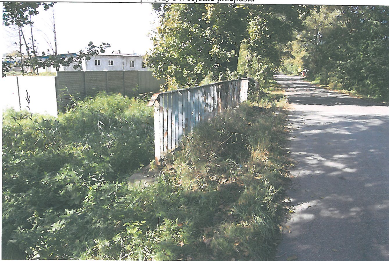
Fot. 6. Widok nawierzchni na przepuście, zanieczyszczenia i wegetacja roślin wzdłuż poręczy
