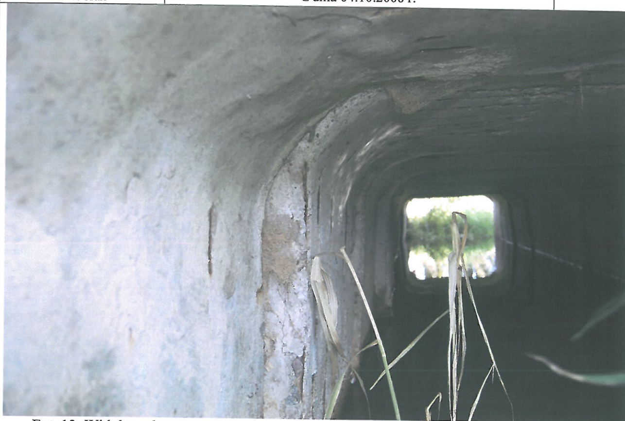
Fot. 13. Widok oczka przepustu z elementów prefabrykowanych, ubytki otuliny, widoczne skorodowane zbrojenie, niesprawna izolacja
