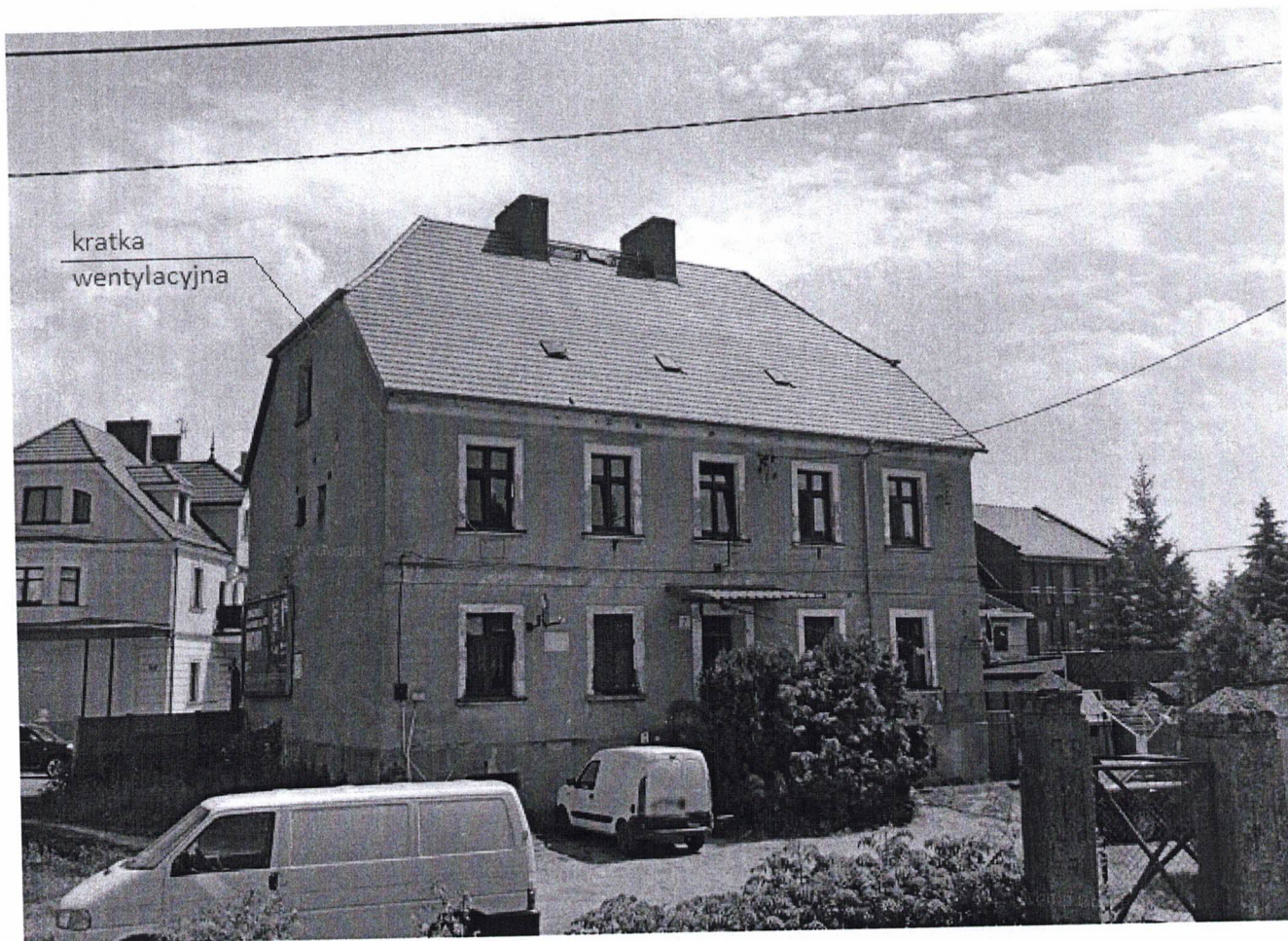
Fot. 2 Umieszczenie projektowanej instalacji nawiewnej (frontowa ściana budynku)
