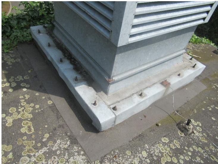
Zdj. nr 17. Stacja transformatorowa przy pompowni P2.– Wykonać uszczelnienie pokrycia dachowego na kołnierzu wyrzutni powietrza
