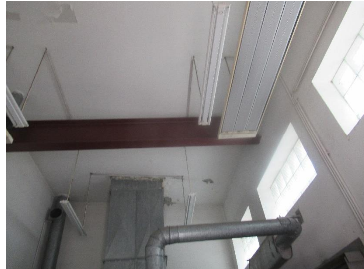
Zdj. nr 18. Stacja transformatorowa przy pompowni P2.– miejsca przecieków przy wyrzutni powietrza.
