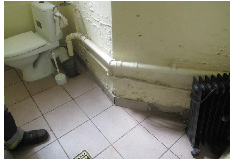
Zdj. nr 8. Pomieszczenie socjalne w pompowni P1 – skucie zmurszałych tynków, odgrzybianie, uzupełnienie tynków, wiercenie otworu na kratkę wentylacyjną, uzupełnienie terakoty oraz cokolików, wymiana drzwi na aluminiowe, malowanie pomieszczenia.
