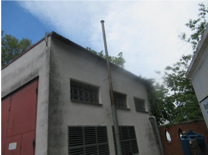
Zdj. nr 15. Stacja transformatorowa przy pompowni P2.
