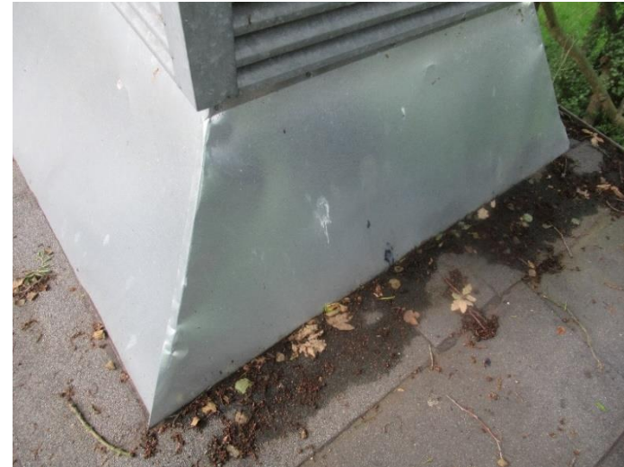
Zdj. nr 2. Wyrzutnia powietrza stacji transformatorowej przy pompowni P1. – wymagane uszczelnienie łączeń papą termozgrzewalną.
