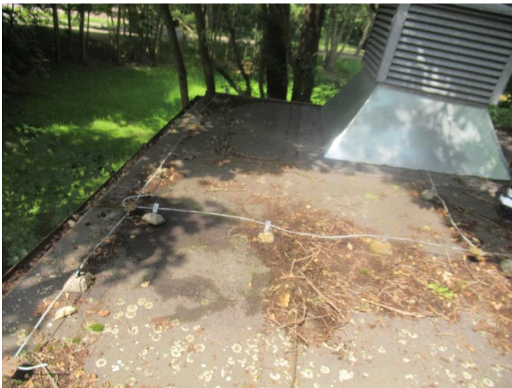
Zdj. nr 3. Wyrzutnia powietrza stacji transformatorowej przy pompowni P1.
