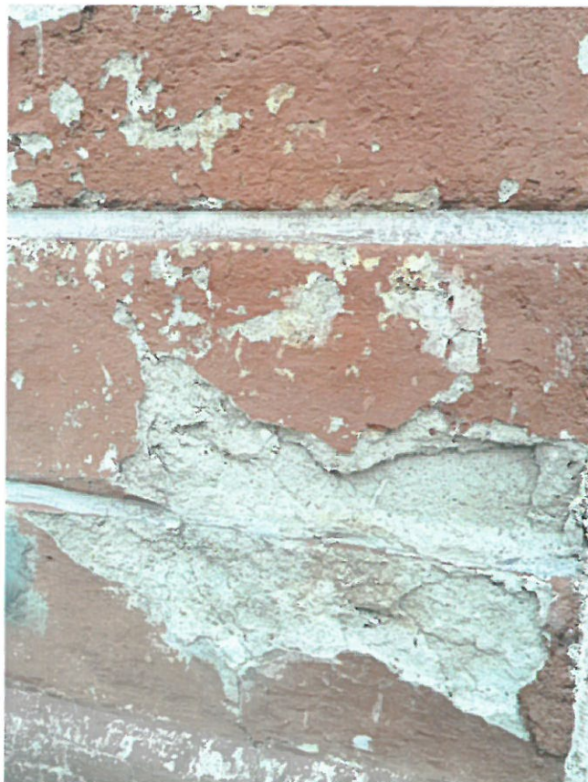
Fot. 14. Osypujące się wyprawy o osłabionym właściwościach fizyko-mechanicznych
