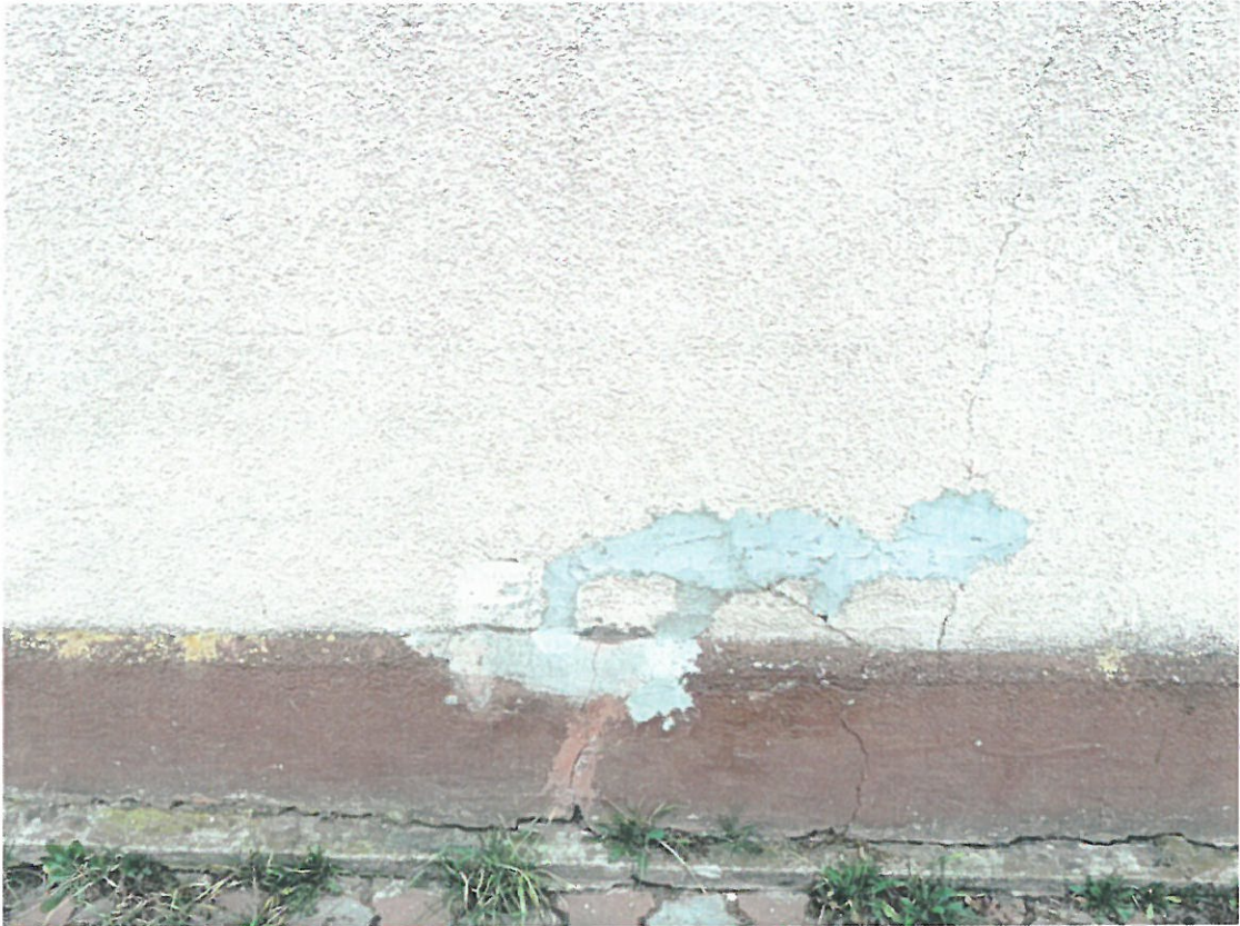
Fot. 9. Nie fachowo wykonane naprawy, łąty cementowe
