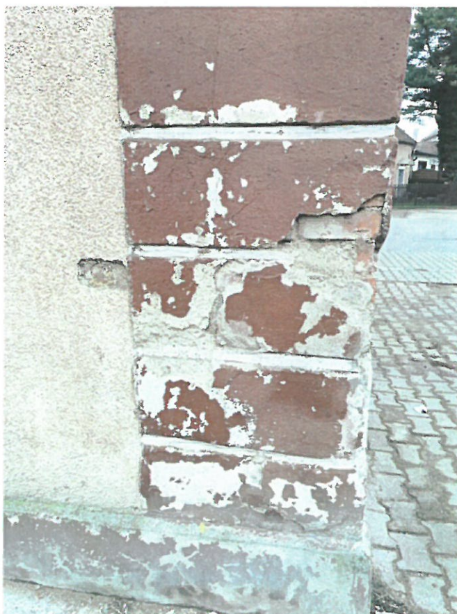
Fot. 6. Uszkodzenia detalu architektonicznego spowodowane podciąganiem kapilarnym
