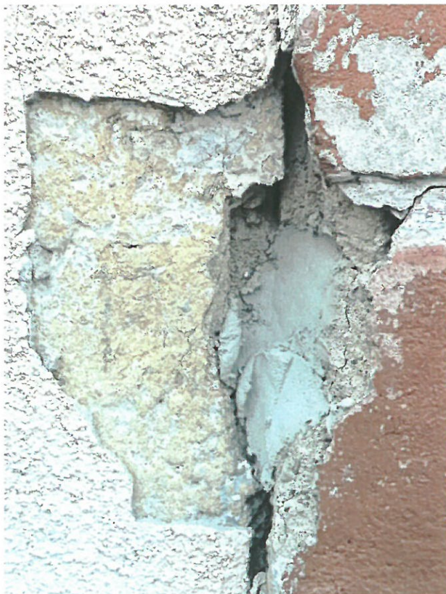
Fot. 12. Spękania konstrukcji murowej, wtórne szlichty cementowe na powierzchni pierwotnego tynku
