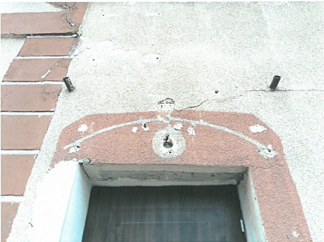
Fot. 10. Spękania na powierzchni elewacji
