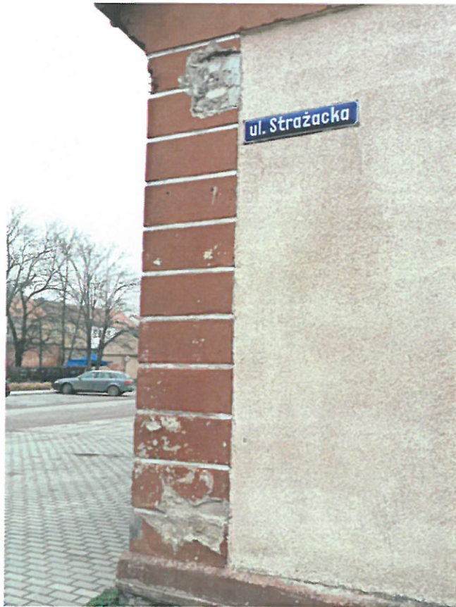
Fot. 13. Ubytki wypraw
