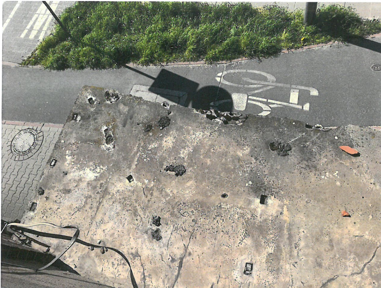
Ilustracja 4: Widok góry zadaszienia z widocznymi spękaniami, korozją biologiczną oraz z miejscami na montaż blachy
