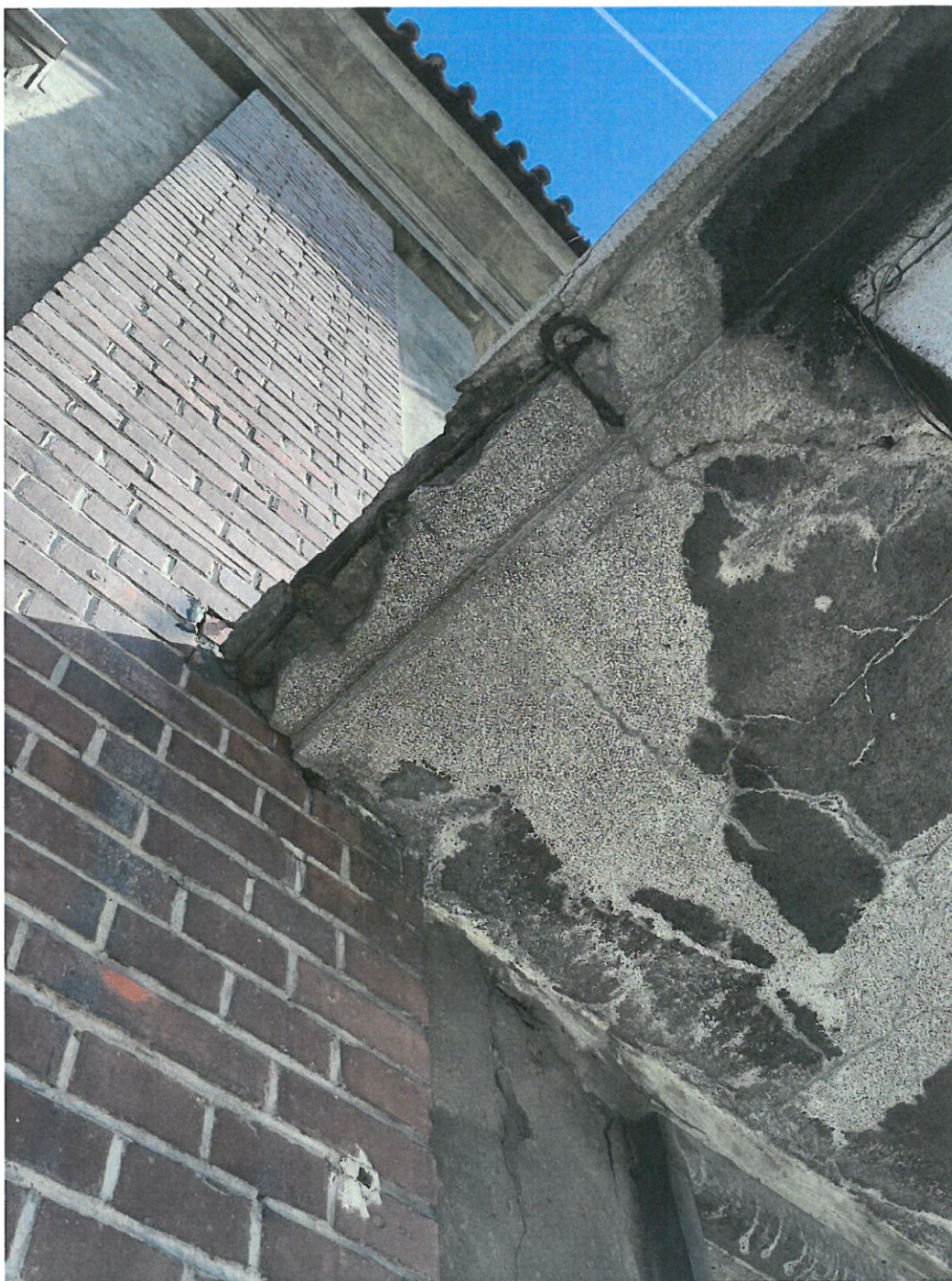
Ilustracja 3: Widok na spód zadaszania z widocznym ubytkiem lastriko oraz przebarwieniami
