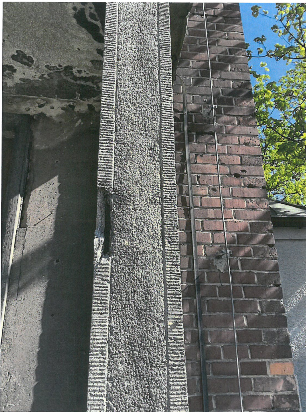
Ilustracja 2: Słup zadaszienia z widocznym ryflowaniem oraz ubytkiem lastriko
