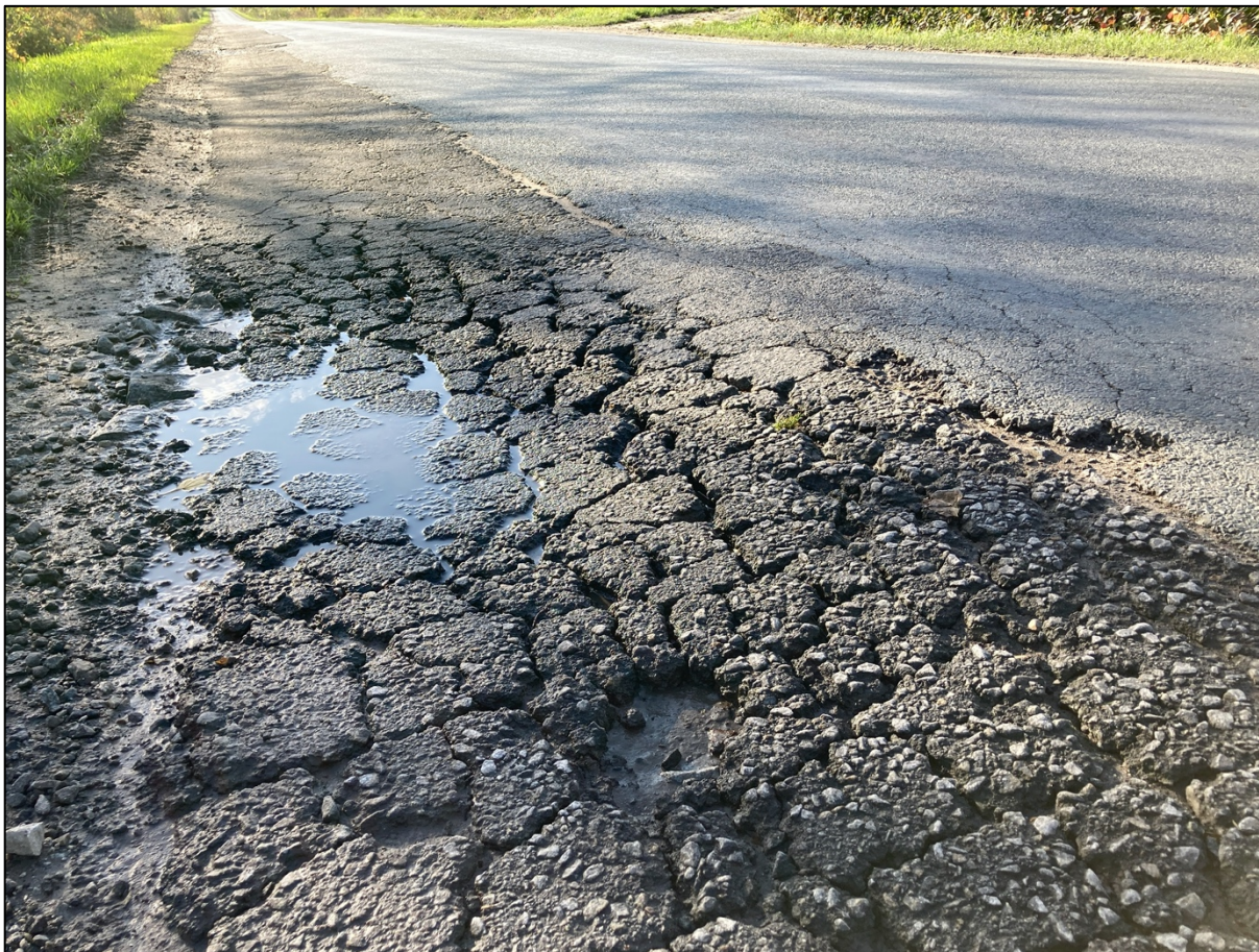
Rycina 7 „Doklejone” połacie bitumiczne na poboczu z licznymi spękaniem i ubytkami (fot. M. Roszyk)
