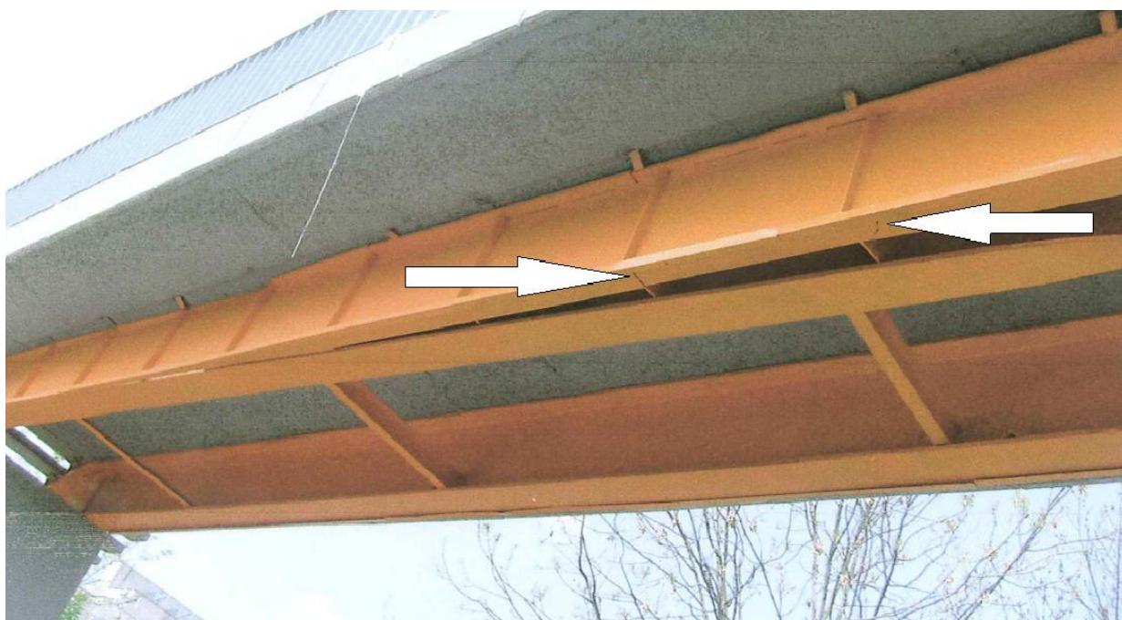
Fot.3 Pęknięcie stopki dolnej – zdjęcie wykonane podczas przeglądu w 2011 r.
