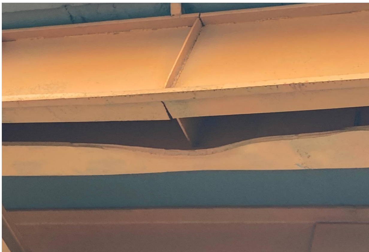
Fot. 9 Brak ciągłości blach elementu wzmacniającego.
