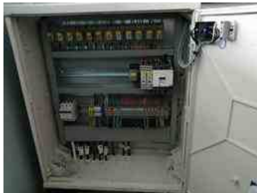
Zdj. nr 3. Widok tablic słupowych TS.
