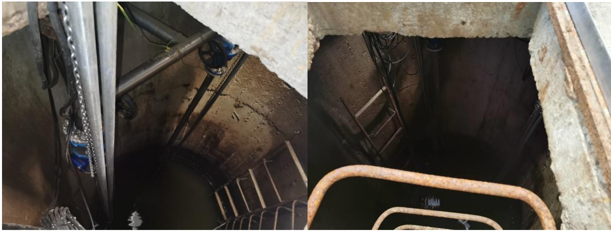
Rysunek 1. Komora przepompowni - stan obecny
