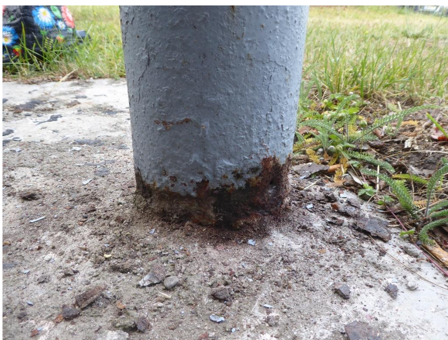
Fot. 3. Skorodowana dolna część słupa zadaszenia od strony południowej
