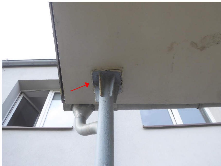
Fot. 2. Bezpośrednie oparcie płyty żelbetowej zadaszenia od strony północnej na słupie stalowym
