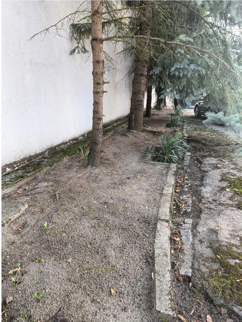
Fot. 6 krawężnik do usunięcia
