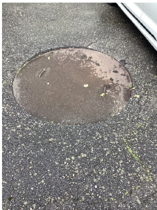
Fot. 2 wylaz do wymiany
