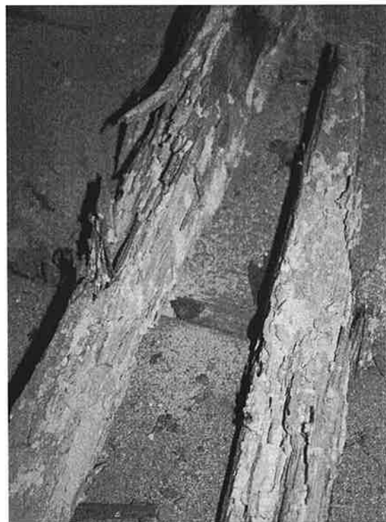
Fot.12 – Strop nad dolną kondygnacją poddasza ( nad IIp. ); odkrywka w rejonie krokwi nr 5; widoczne ułamki drewna porażonego przez owady
