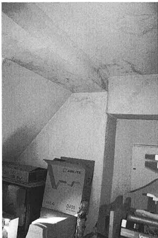
Fot. 07 - Strop nad dolną kondygnacją poddasza ( nad IIp. ); pom. magazyn. na pn. skraju budynku; widoczne plamy, przebarwienia i wykwyty;
