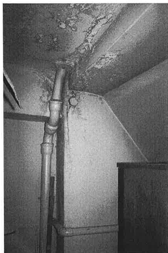
Fot. 05 - Strop nad dolną kondygnacją poddasza ( nad IIp. ); pom. magazyn. na pn. skraju budynku; widoczne plamy, przebarwienia i wykwit;
