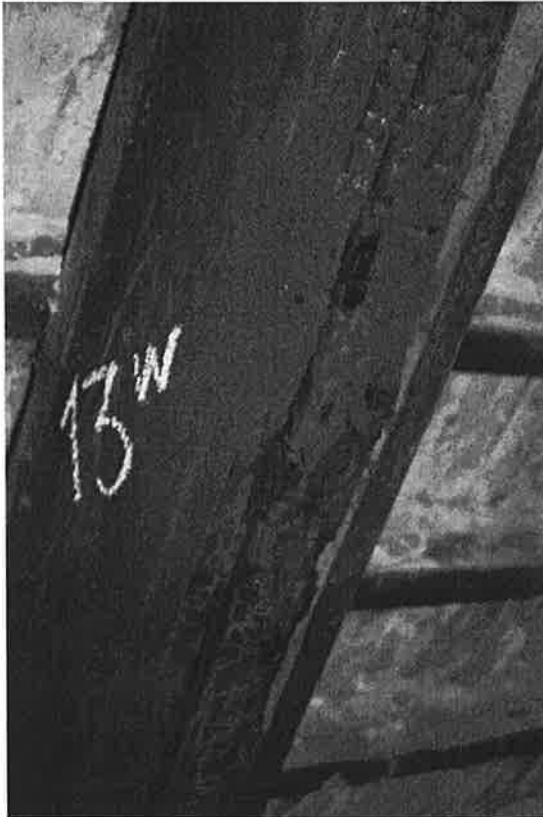
Fot. 19 – Górna kondygnacja poddasza ( IIIp.); uszkodzona przez ogień krokiew 13W oraz nakładki z desek
