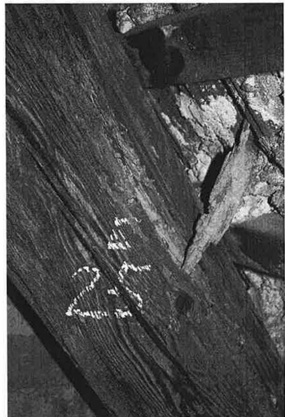
Fot.24 – Górna kondygnacja poddasza ( IIIp.); widoczna uszkodzona krokiew 25E
