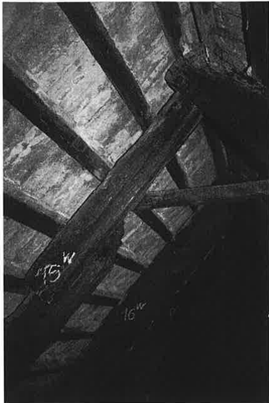
Fot. 21 – Górna kondygnacja poddasza ( IIIp.); widoczna uszkodzona krokiew 15W
