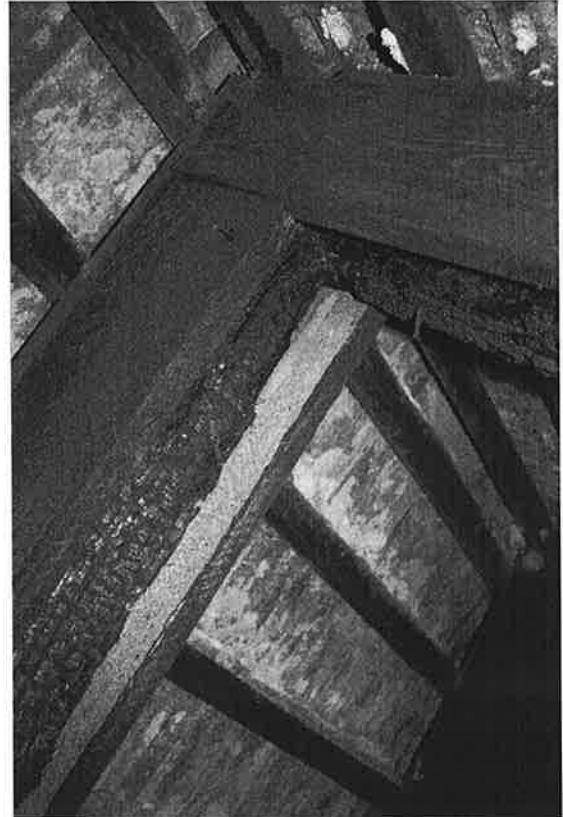
Fot.20 – Górna kondygnacja poddasza ( IIIp.); uszkodzona przez ogień krokiew 13W i 13E oraz nakładki z desek
