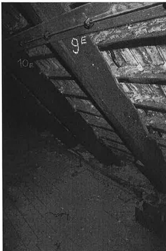
Fot. 23 – Górna kondygnacja poddasza ( IIIp.); widoczna nadciąg z NP. 120
