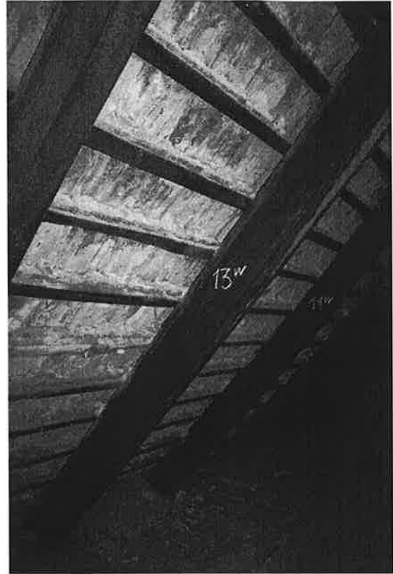
Fot.18 – Górna kondygnacja poddasza ( IIIp.); widoczne krokiew 13W uszkodzona przez ogień
