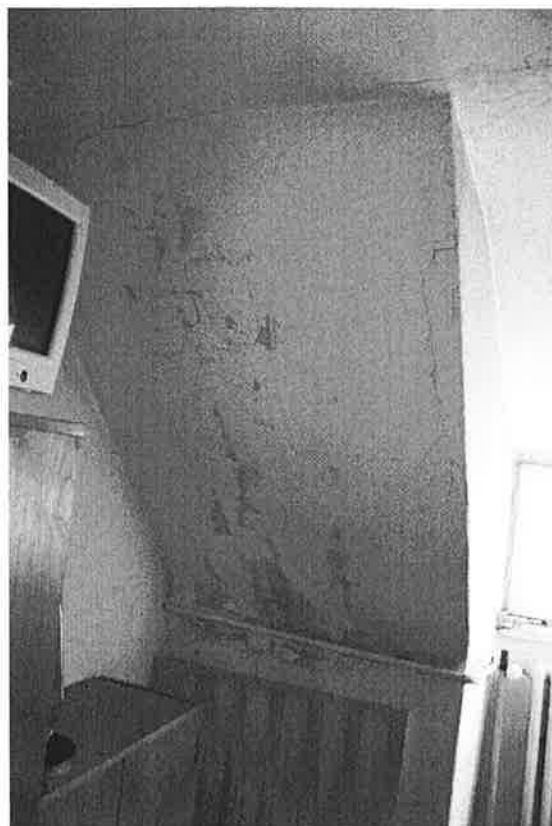
Fot.08 – Strop nad dolną kondygnacją poddasza ( nad IIp. ); pom. magazyn. na pn. skraju budynku; widoczne plamy, przebarwienia i wykwyty;
