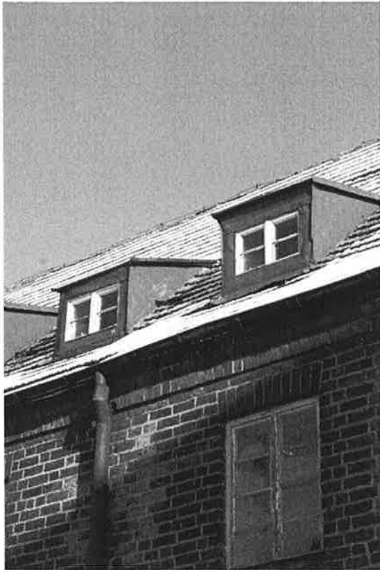
Fot. 27 – Zachodnia płac dachowa; po lewej widoczna lukarna niższa niż pozostałe;
