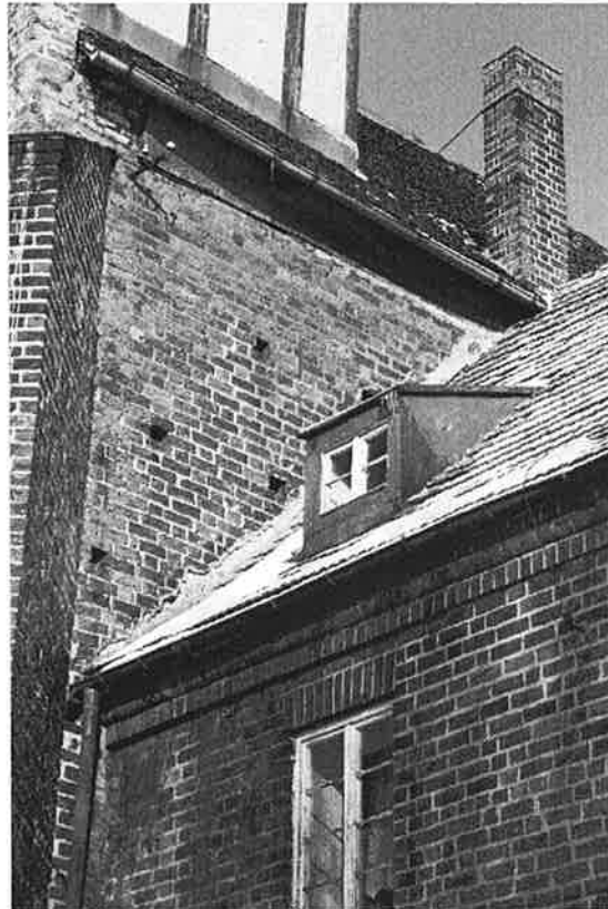
Fot. 29 – Zachodnia płac dachowa; widoczna korozja blachy skrajnej lukarny i brak opierzenia na styku z dawnym kościołem
