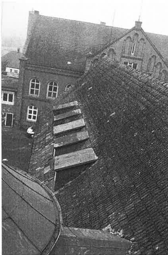
Fot. 25 –Wschodnia płac dachowa; widoczna widoczna korozja blachy na lukarnach;
