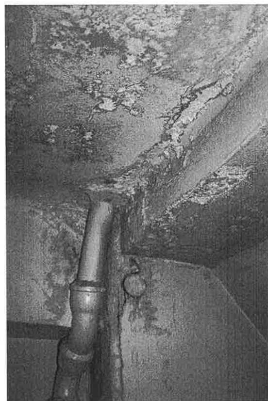
Fot.06 – Strop nad dolną kondygnacją poddasza ( nad IIp. ); pom. magazyn. na pn. skraju budynku; widoczne plamy, przebarwienia i wykwit;
