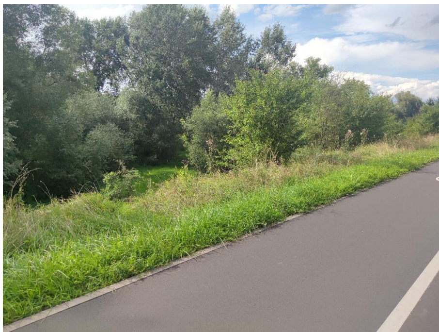
Fot.11. Widok na wał w km 0+700. Widoczne krzewy i drzewa na skarpach wału
