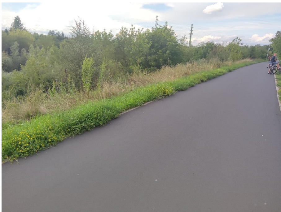
Fot.2. Widok na wał w km 1+650. Widoczne krzewy i drzewa na skarpach wału.
