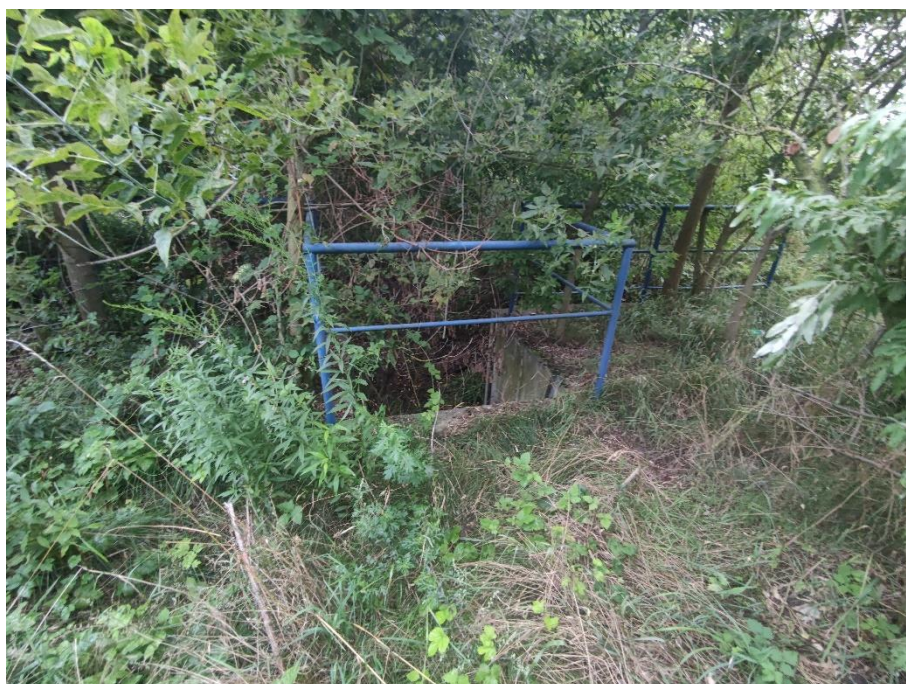
Fot.15. Komora wlotowa przepustu w km 1+175. Widoczne krzewy i drzewa
