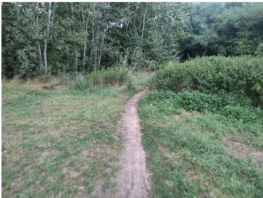
Fot.21. Widok na wał w km 0+100. Widoczne krzewy i drzewa na wale
