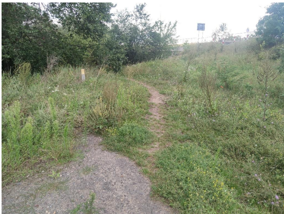
Fot.25. Początek wału w km 0+000. Widoczne krzewy i drzewa na wale
