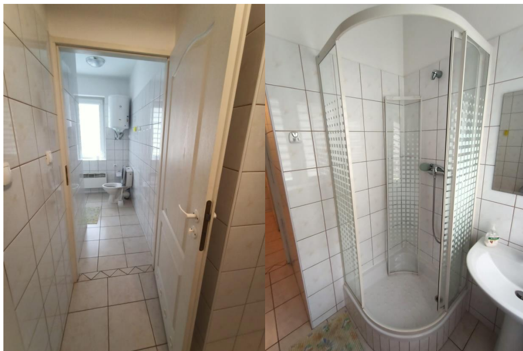
Zdjęcie 23, Zdjęcie 24. Łazienka „za kuchnią przy sali ze stołami konferencyjnymi” – wejście od strony przedsionka z umywalkami.
