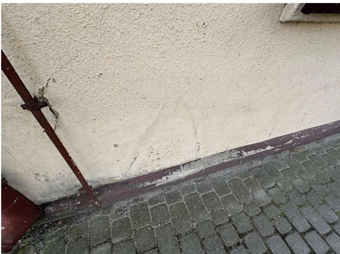
Zdj. Nr. 6 Elewacja północna widoczny wtórny tynk cementowo-wapienny
