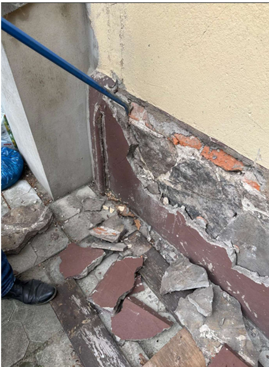
Zdj. Nr. 4 Widoczny stan cokołu pod warstwami wtórnego tynku
