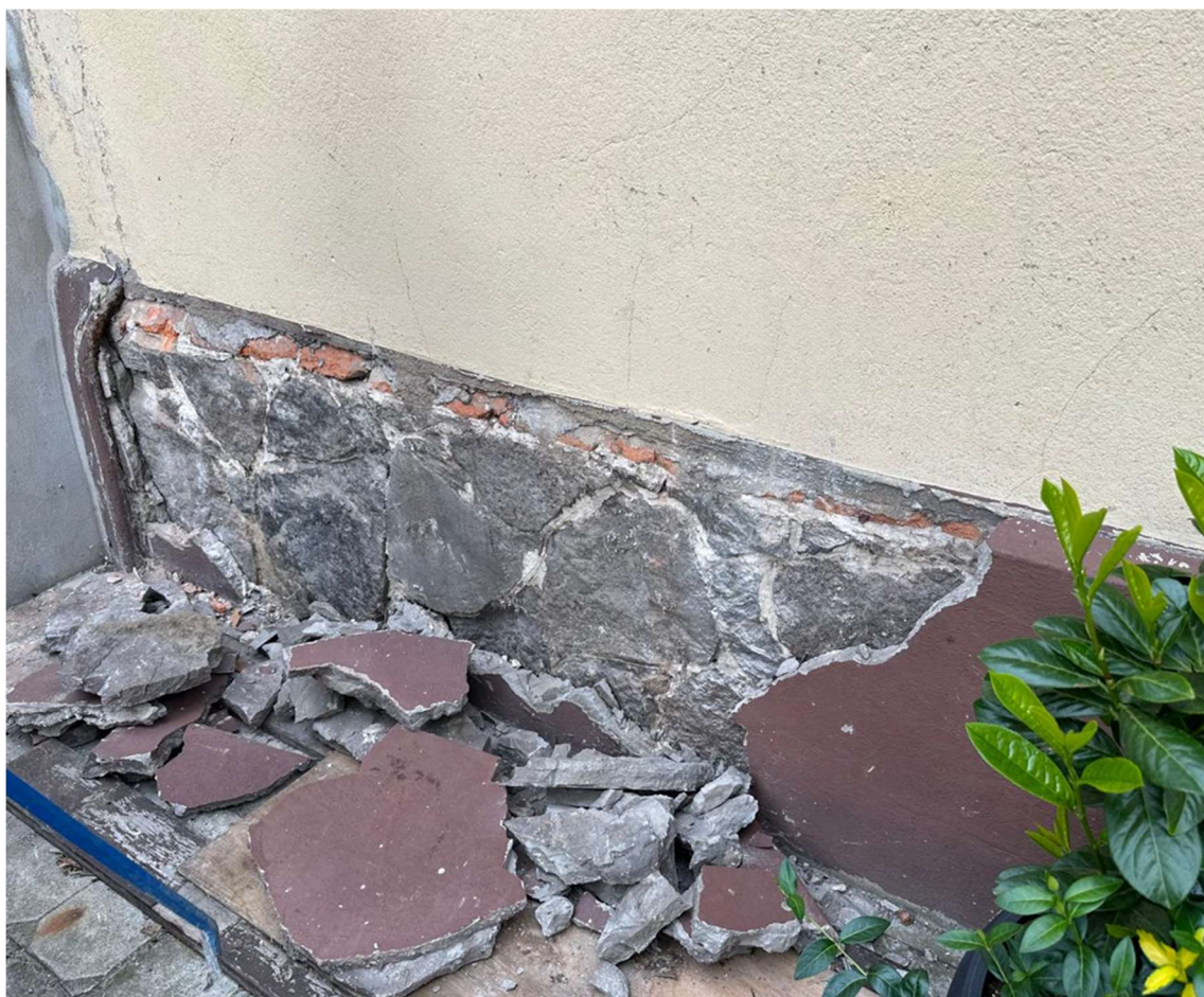
Zdj. Nr. 3 Widoczny stan cokołu pod warstwami wtórnego tynku
