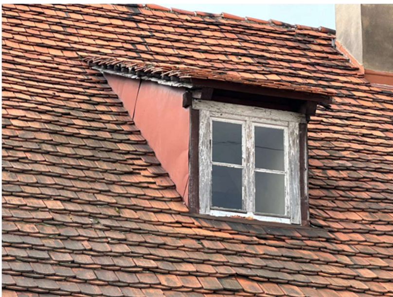
Zdj. Nr. 11 Widoczny stan pokrycia dachu
