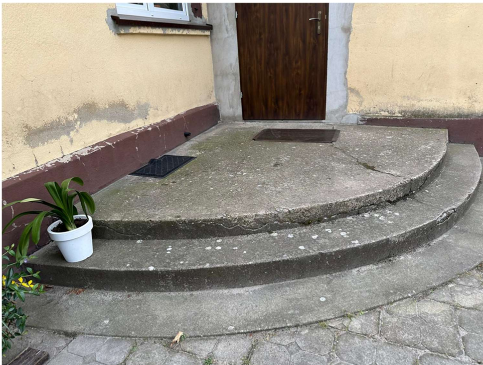
Zdj. Nr . 14 Widoczny uszkodzenia warstw posadzki schodów zewnętrznych
