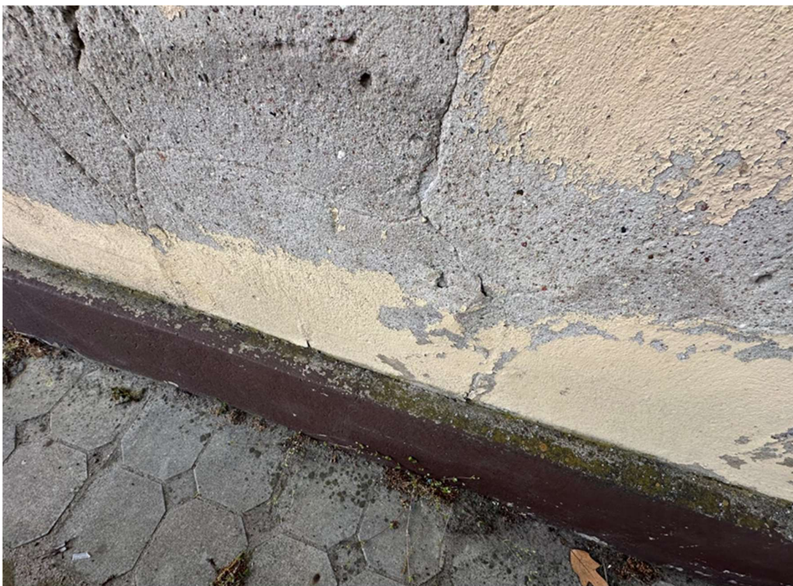
Zdj. Nr. 7 Elewacja wschodnia widoczny wtorny tynk cementowo-wapienny
