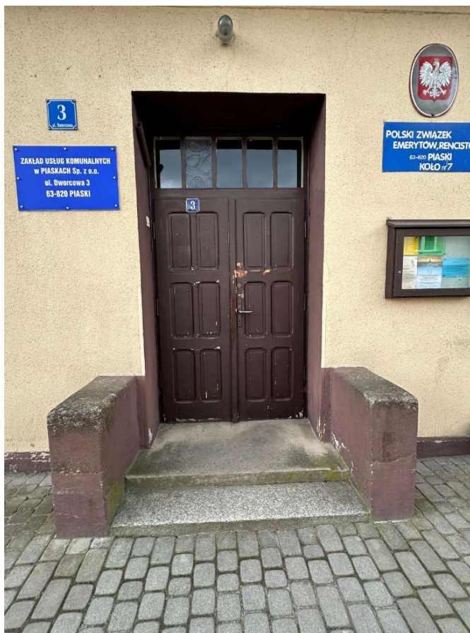
Zdj. Nr.13 Widoczny stan stolarki drzwiowej
