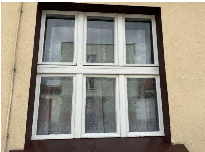
Zdj. Nr.12 Widoczny stan stolarki okiennej
