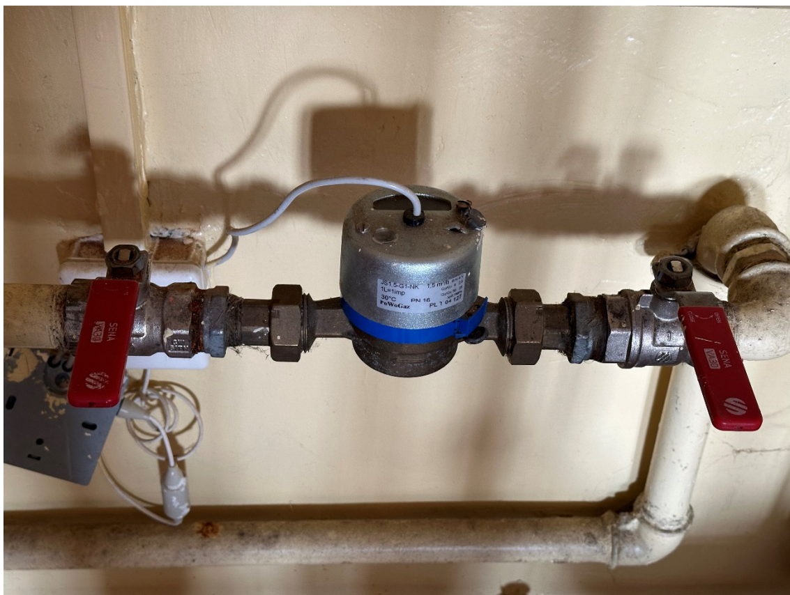
Fot. 22 Widok wodomierza, w poziomie piwnicy
