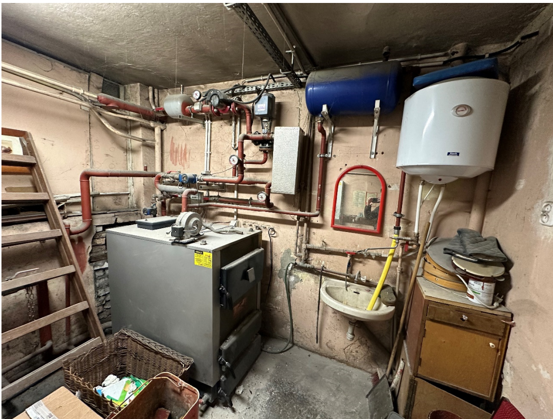
Fot. 15 Widok kotła oraz zasobnika c.w.u. , w poziomie piwnicy
