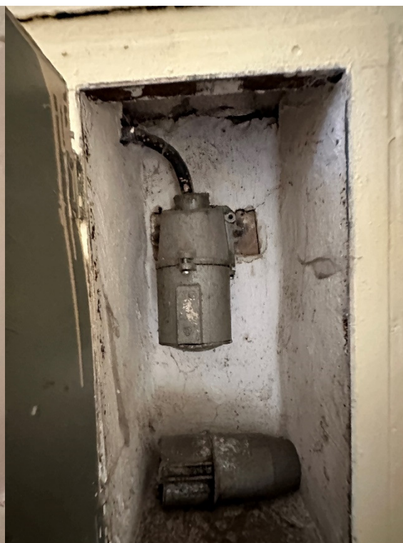
Fot. 27 Widok instalacji, przy wejściu do budynku
