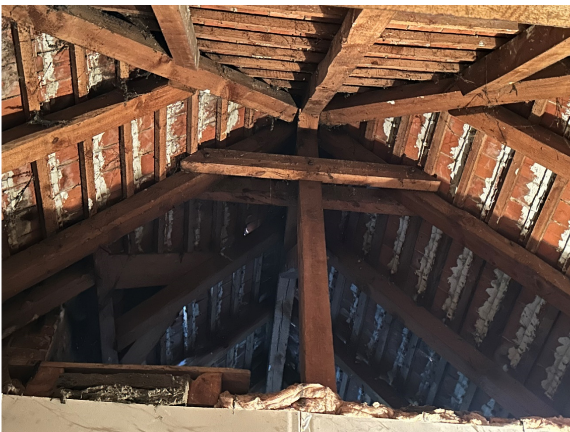
Fot. 43 Zbliżenie na konstrukcję więźby dachowej w osi '2' przy klatce schodowej (ponad ścianą konstrukcyjną w osi '2')
