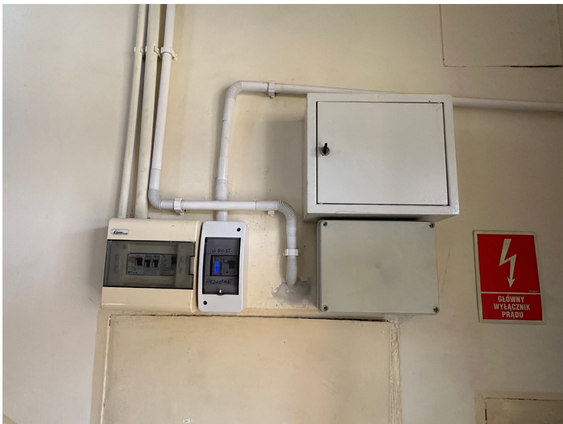
Fot. 25 Widok tablic rozdzielczych, przy wejściu do budynku
