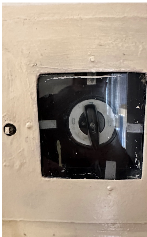
Fot. 26 Widok głównego wyłącznika prądu, przy wejściu do budynku
