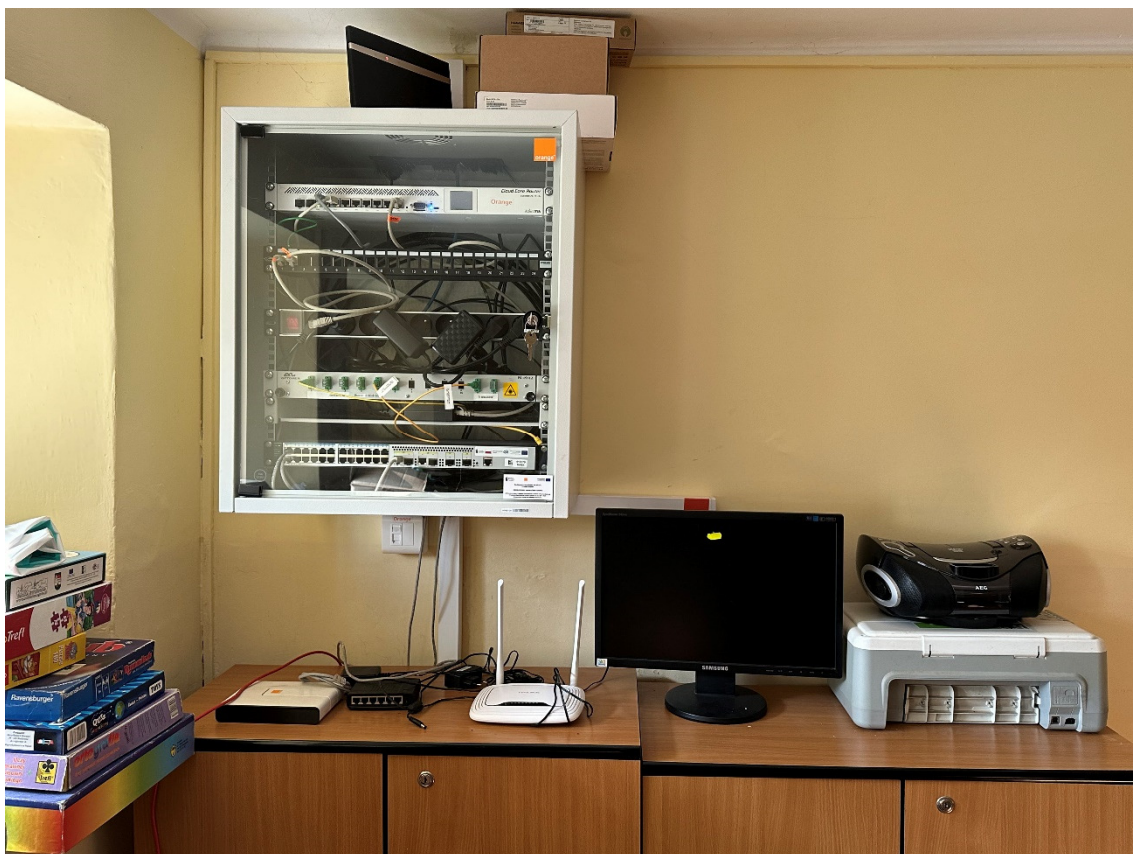
Fot. 23 Widok szafki teletechnicznej, w poziomie piwnicy
