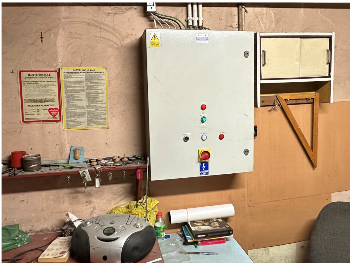
Fot. 24 Widok głównego wyłącznika prądu, w poziomie piwnicy
