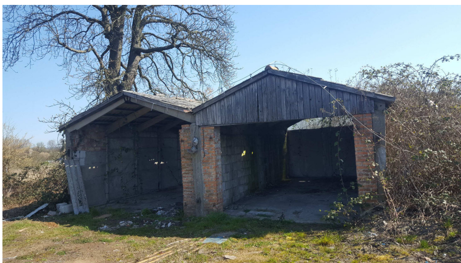
Widok ogólny od frontu garaży. Widoczny stan techniczny budynku oraz brak wrót wjazdowych
