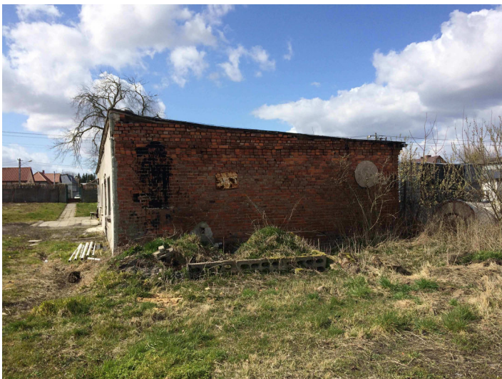
Widok na elewację wschodnią. Widoczne ubytki, uszkodzenia i wypłukana spoina
