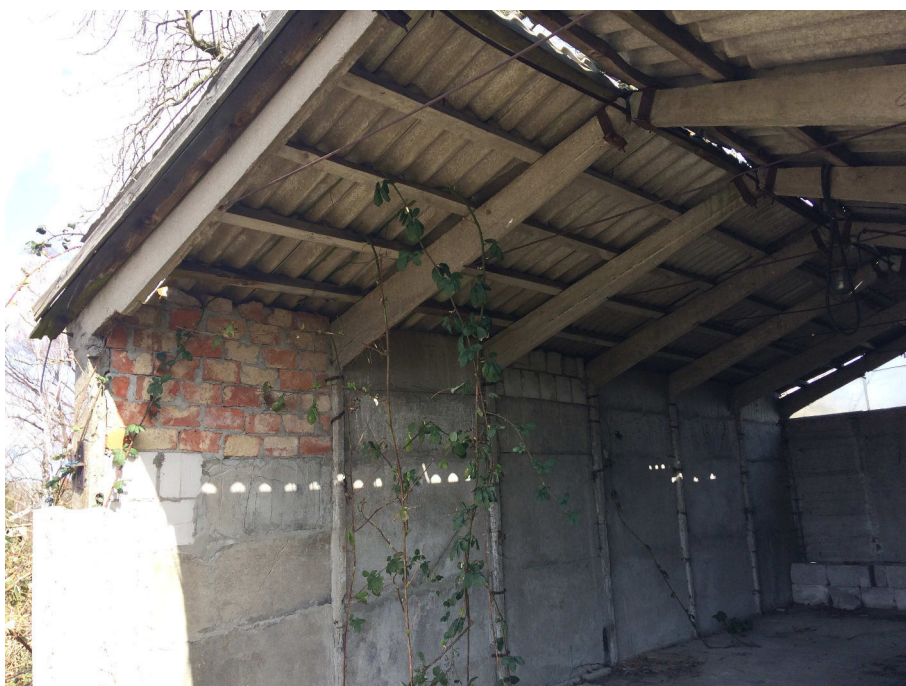
Widoczna konstrukcja prefabrykowana betonowa ścian zewnętrznych wypełnionych płytami betonowymi oraz betonowe krokwie dachowe połączone na stalowe łączniki.
