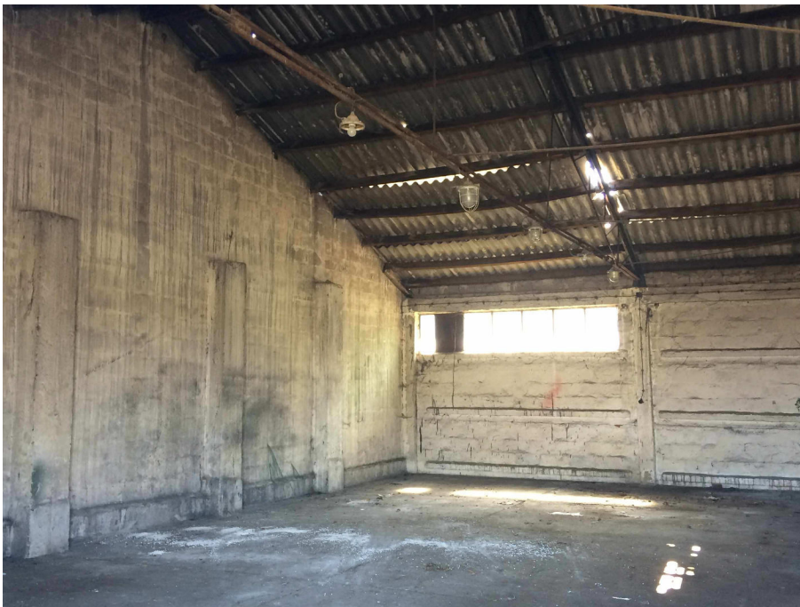
Widok na wnętrze hali wysokiej. Widoczne nieszczelności pokrycia dachowego, konstrukcją ścian zewnętrznych i szczytowych
