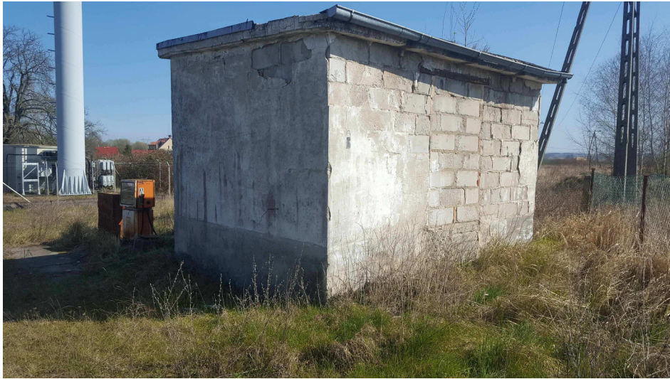
Widok ogólny z zewnątrz na budynek. Widoczne uszkodzenia, przemurowania i ubytki
