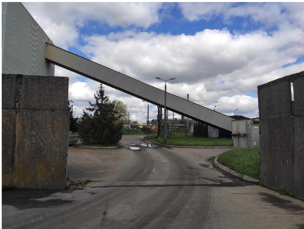
Fot.3 - Obudowa estakady nawęglania kotłów przeznaczona do remontu.
