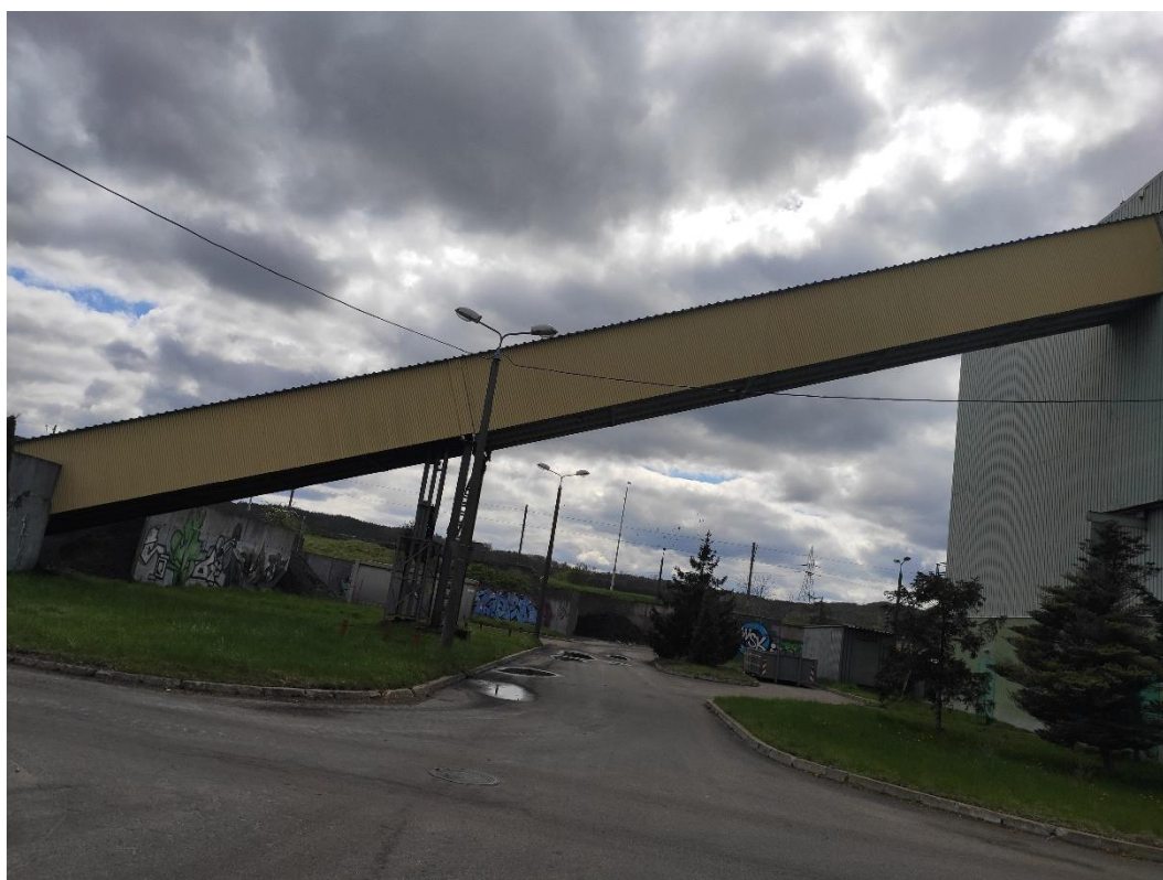
Fot.4 - Obudowa estakady nawęglania kotłów przeznaczona do remontu.
